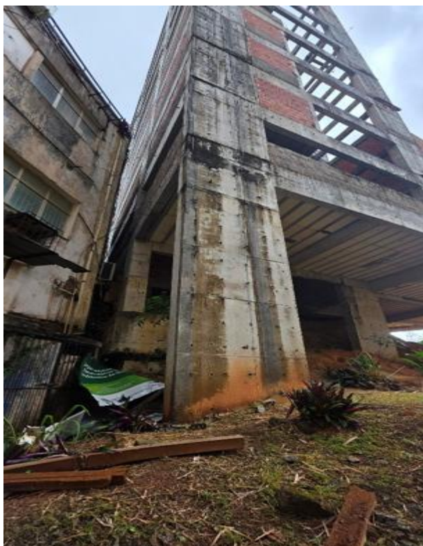
FOTO IV – FACHADA EXTERNA/PILARES – SITUAÇÃO ATUAL
