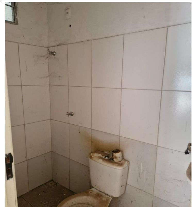
Foto 03 – Sanitário do imóvel, apresentando revestimento cerâmico em condições estruturais adequadas e sem danos aparentes. Observa-se acúmulo de sujeira devido ao desuso, bem como tampa do vaso sanitário ausente e necessidade de higienização completa. O ambiente requer limpeza, substituição da tampa e pequenos ajustes, mantendo-se, contudo, funcional para atendimento após intervenções simples.
