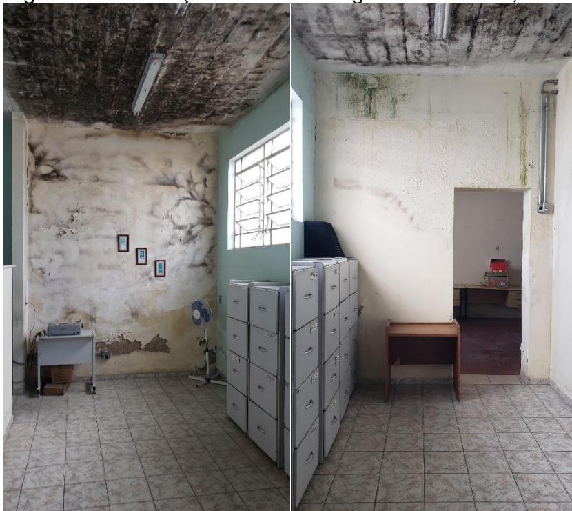
Figura 4 – Presença de Mofo e Fungos em Paredes, Tetos e Pisos
