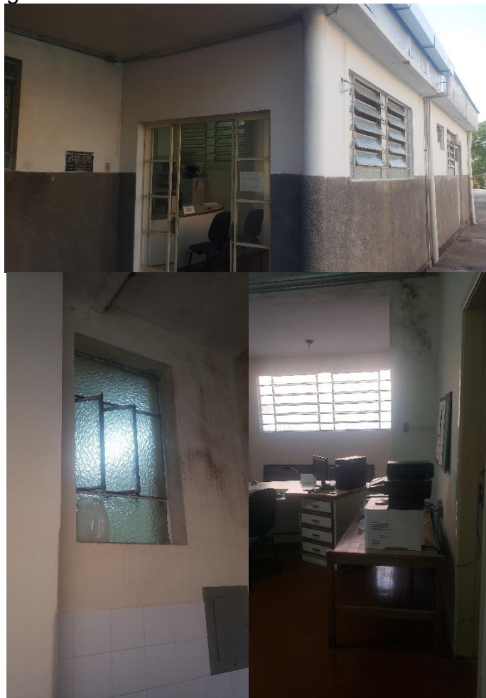
Figura 8 – Portas e Estruturas de Janelas Oxidadas
