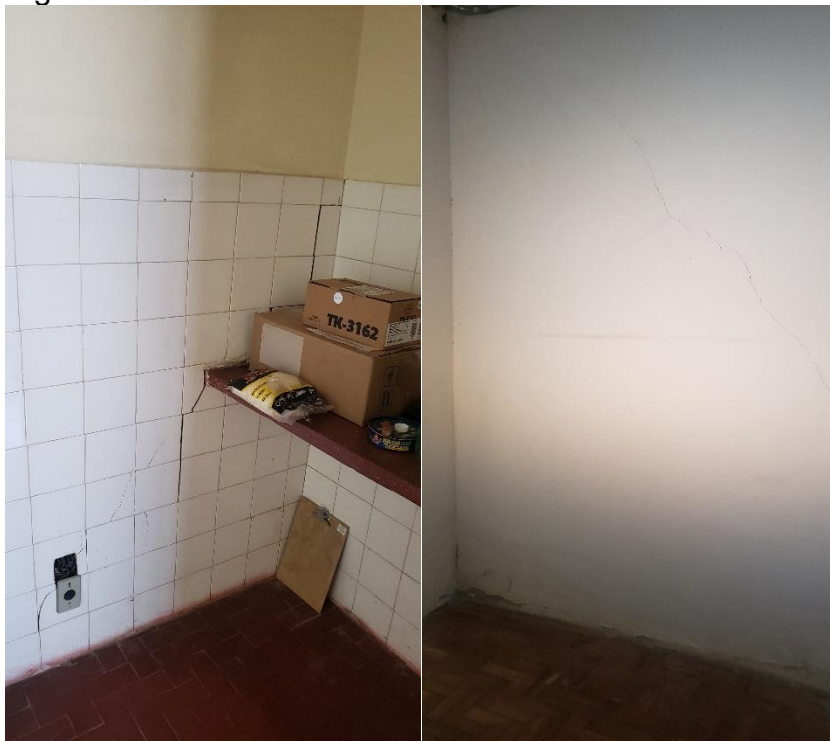
Figura 5 – Trincas e Fissuras em Paredes
