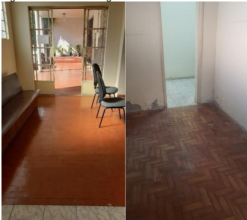
Figura 6 – Pisos Escorregadios e Tacos de Madeira Deteriorados
