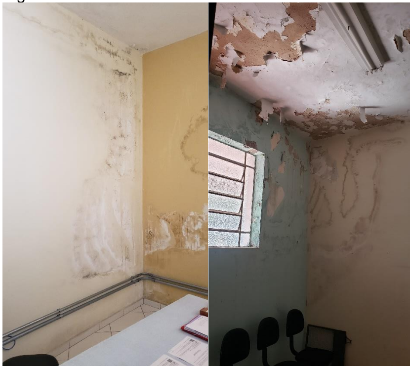
Figura 3 – Pintura e Revestimentos Danificados
