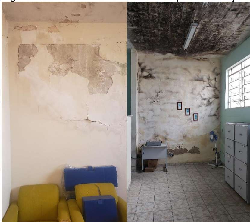
Figura 7 – Reboco Podre e Falhas na Impermeabilização
