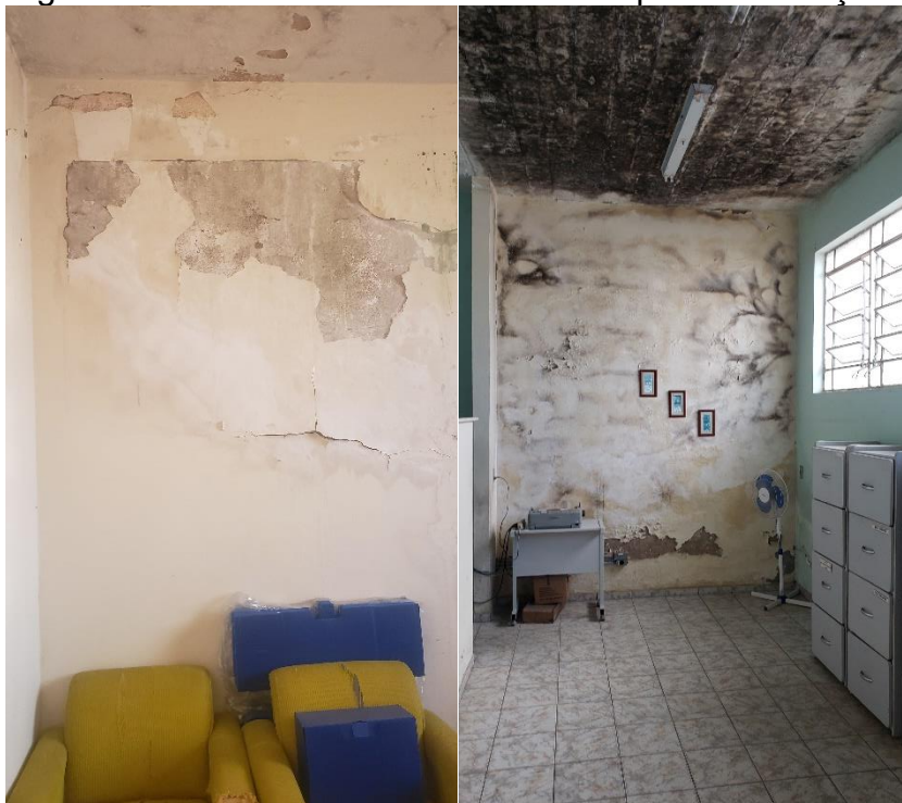
Figura 7 – Reboco Podre e Falhas na Impermeabilização
