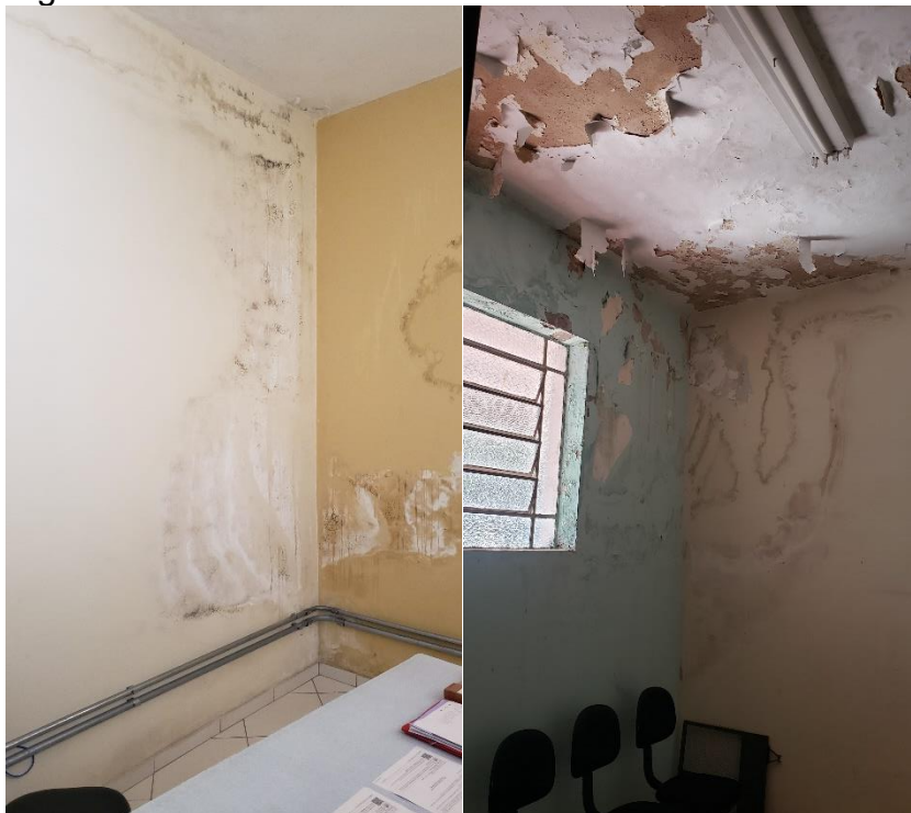
Figura 3 – Pintura e Revestimentos Danificados
