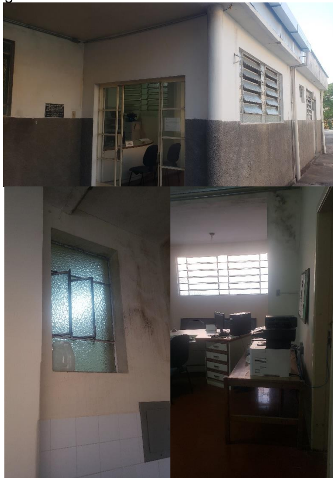
Figura 8 – Portas e Estruturas de Janelas Oxidadas
