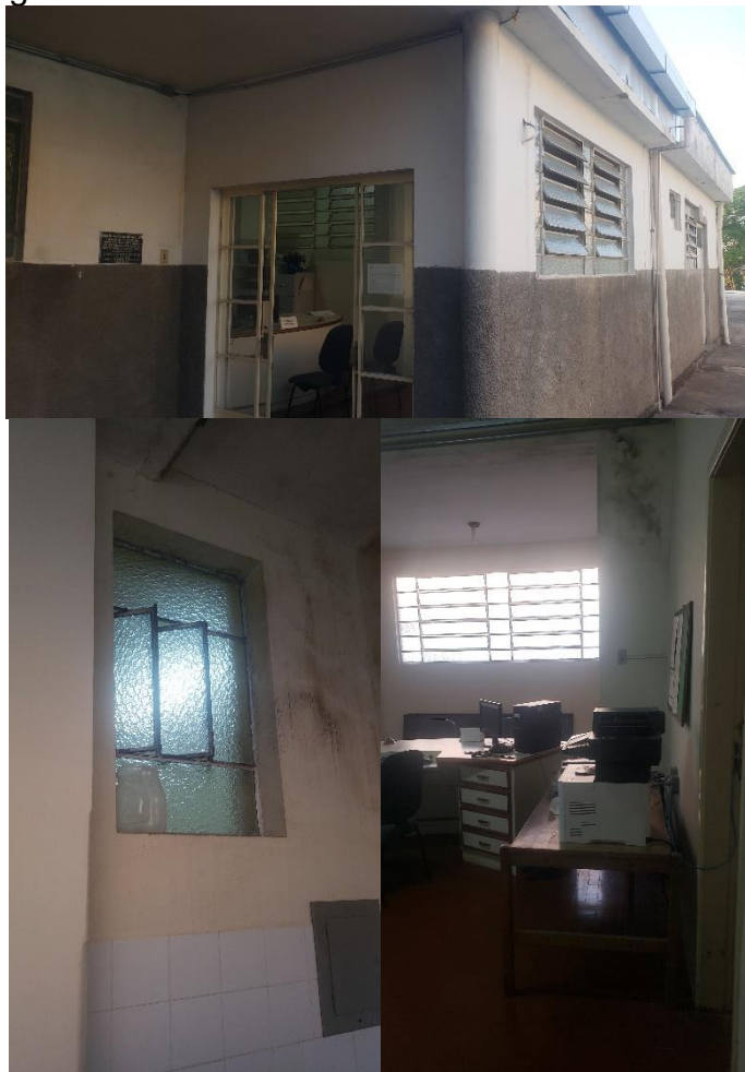
Figura 8 – Portas e Estruturas de Janelas Oxidadas
