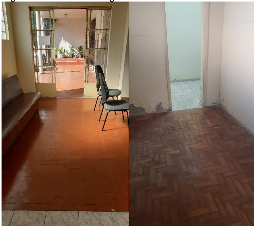
Figura 6 – Pisos Escorregadios e Tacos de Madeira Deteriorados
