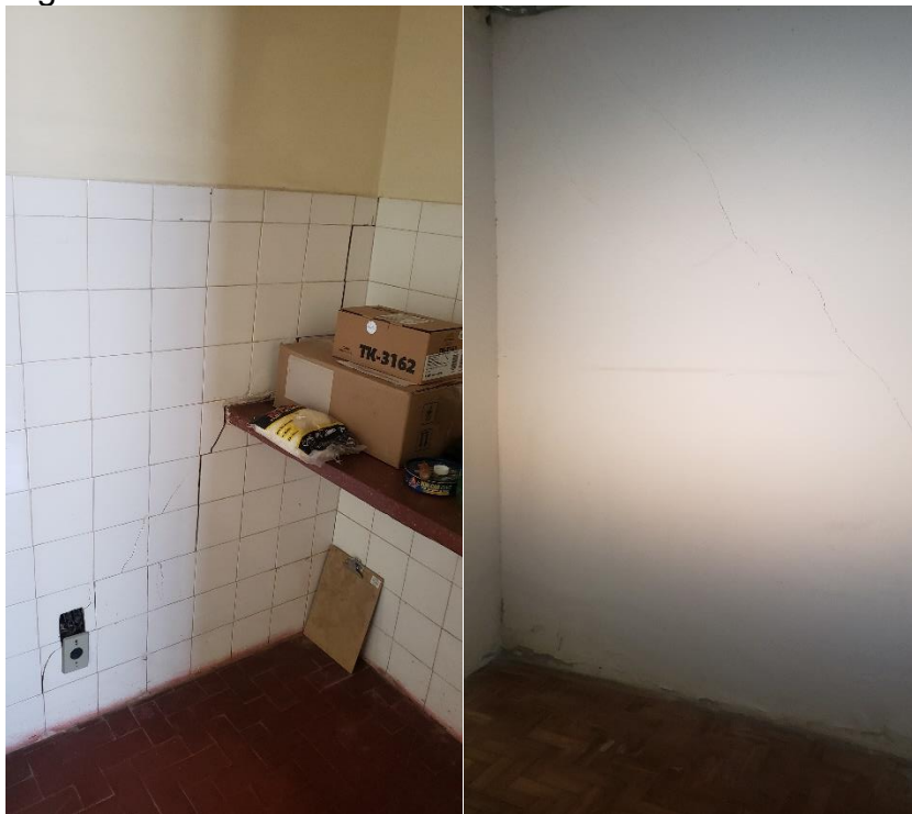
Figura 5 – Trincas e Fissuras em Paredes
