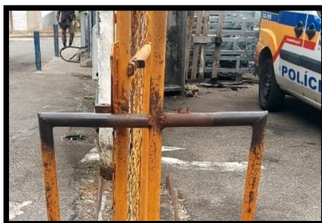
Fig. 26 – Estrutura do Portão Enferrujada
