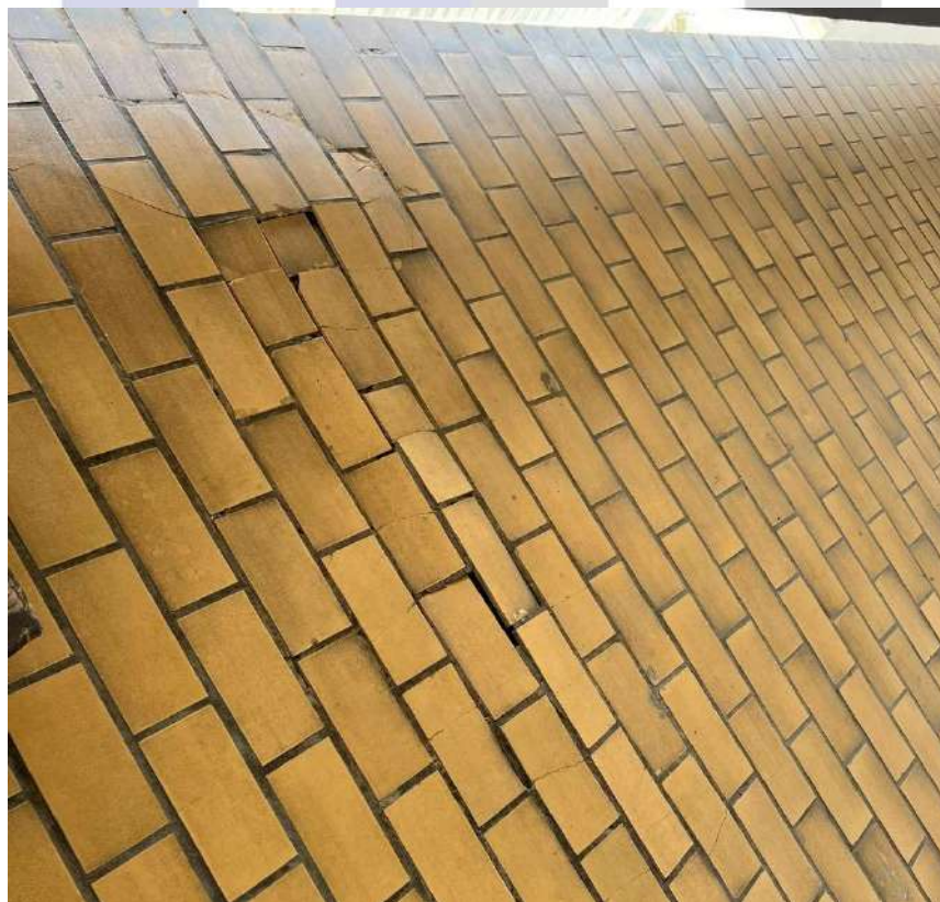
Figura 28 - Deslocamento do piso cerâmico (Fonte: O Autor)
