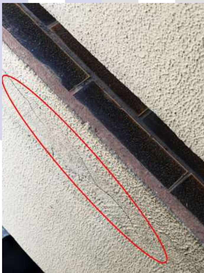
Figura 29 - Fissura horizontal na lateral das passarelas (Fonte: O Autor)
