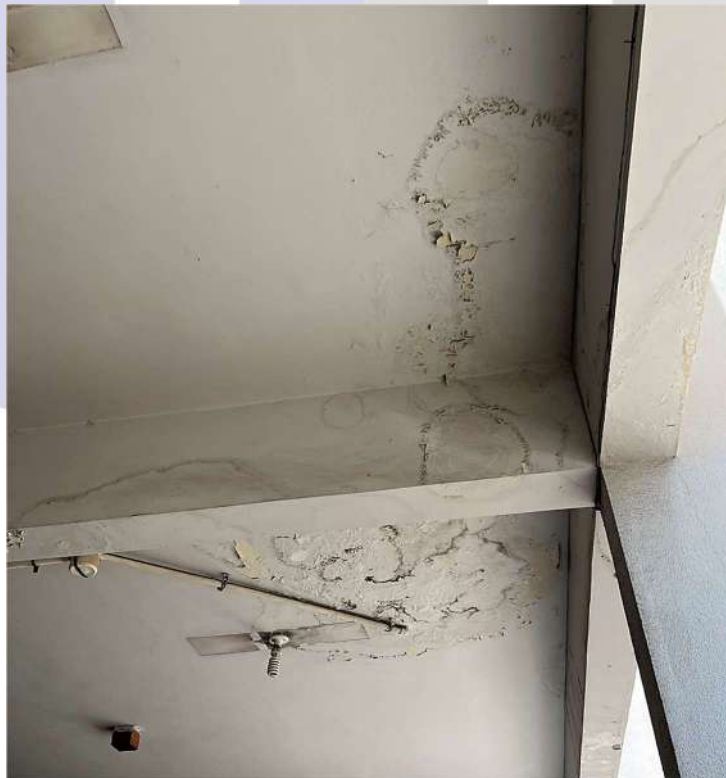
Figura 30 – Manchas e bolor no teto da oficina (Fonte: O Autor)
