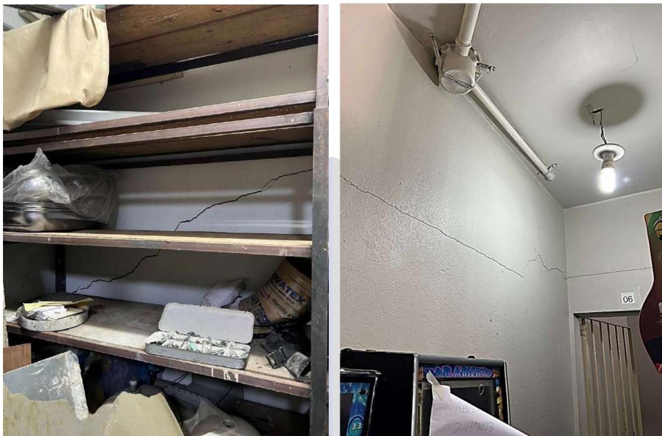
Figura 14 - Alguns dos pontos de fissuração no presídio (Fonte: O Autor)
