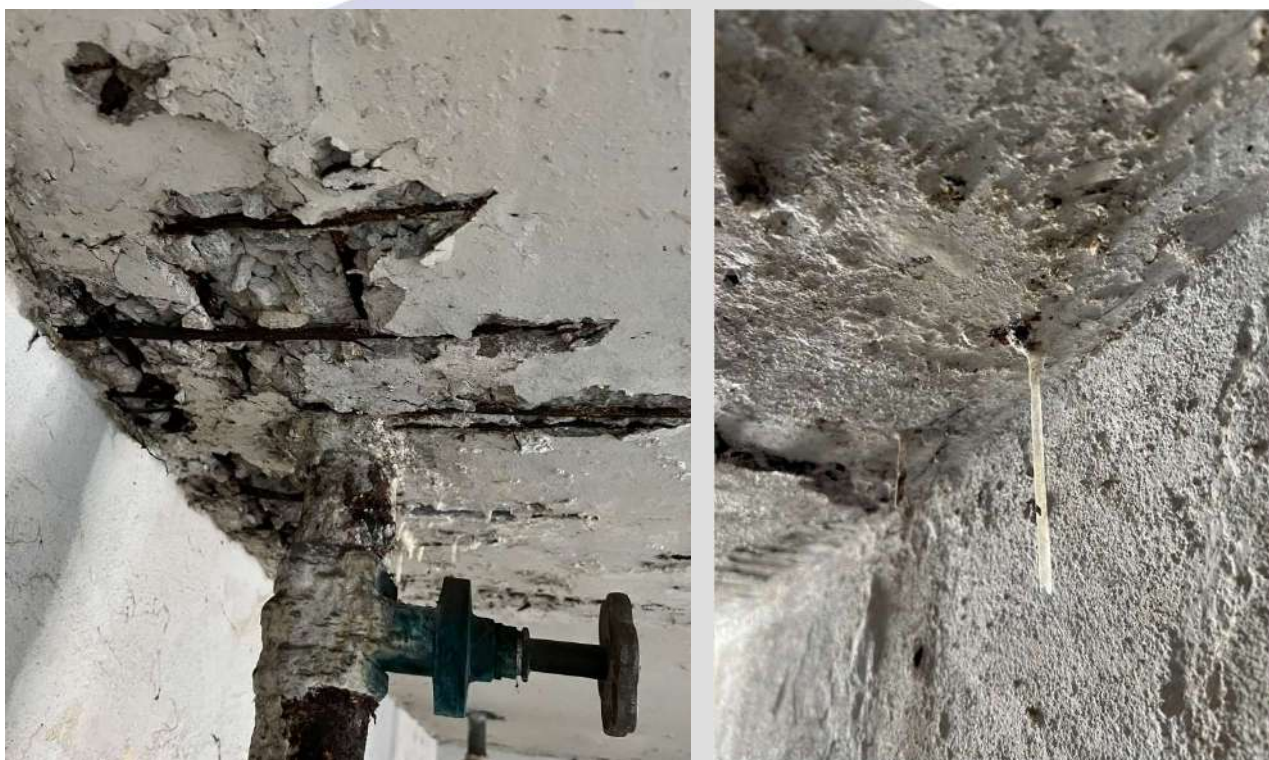
Figura 26 - Armadura exposta e formação de estalactites na laje da casa de máquinas (Fonte: O Autor)
