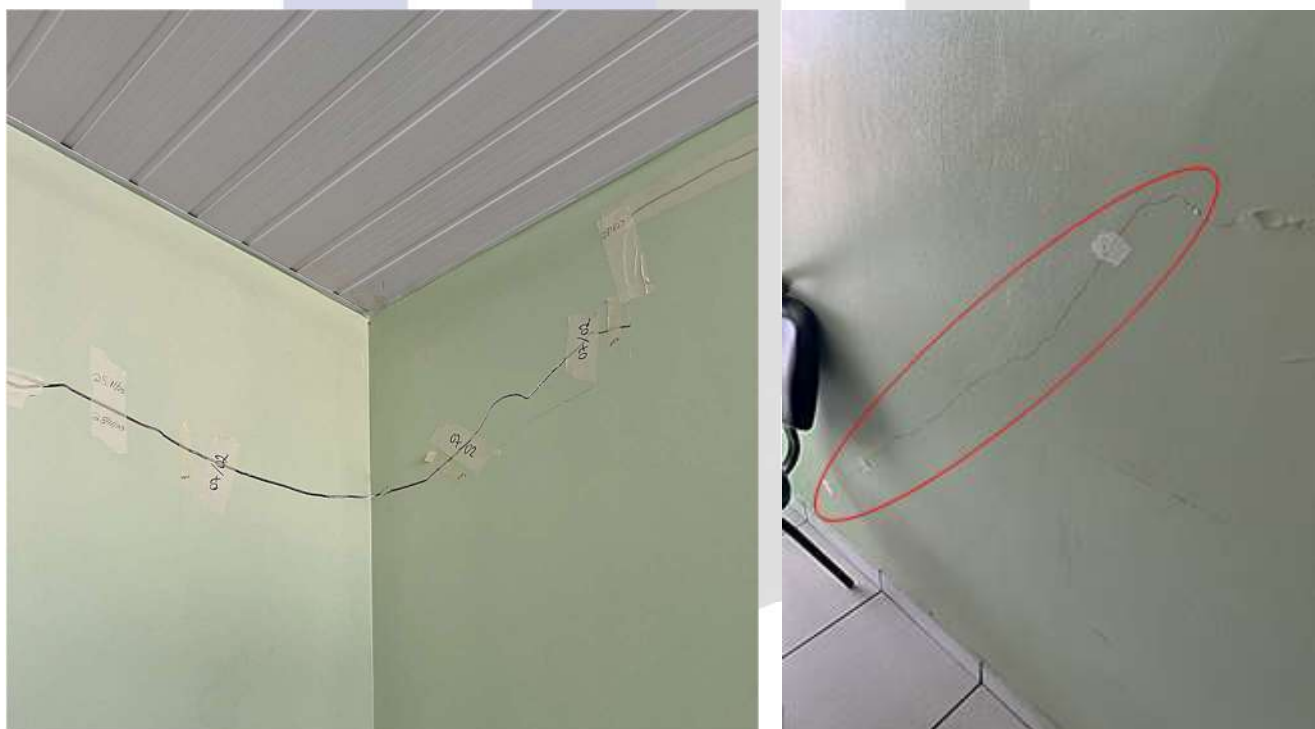
Figura 13: Alguns dos pontos de fissuração no NAIS (Fonte: O Autor)
