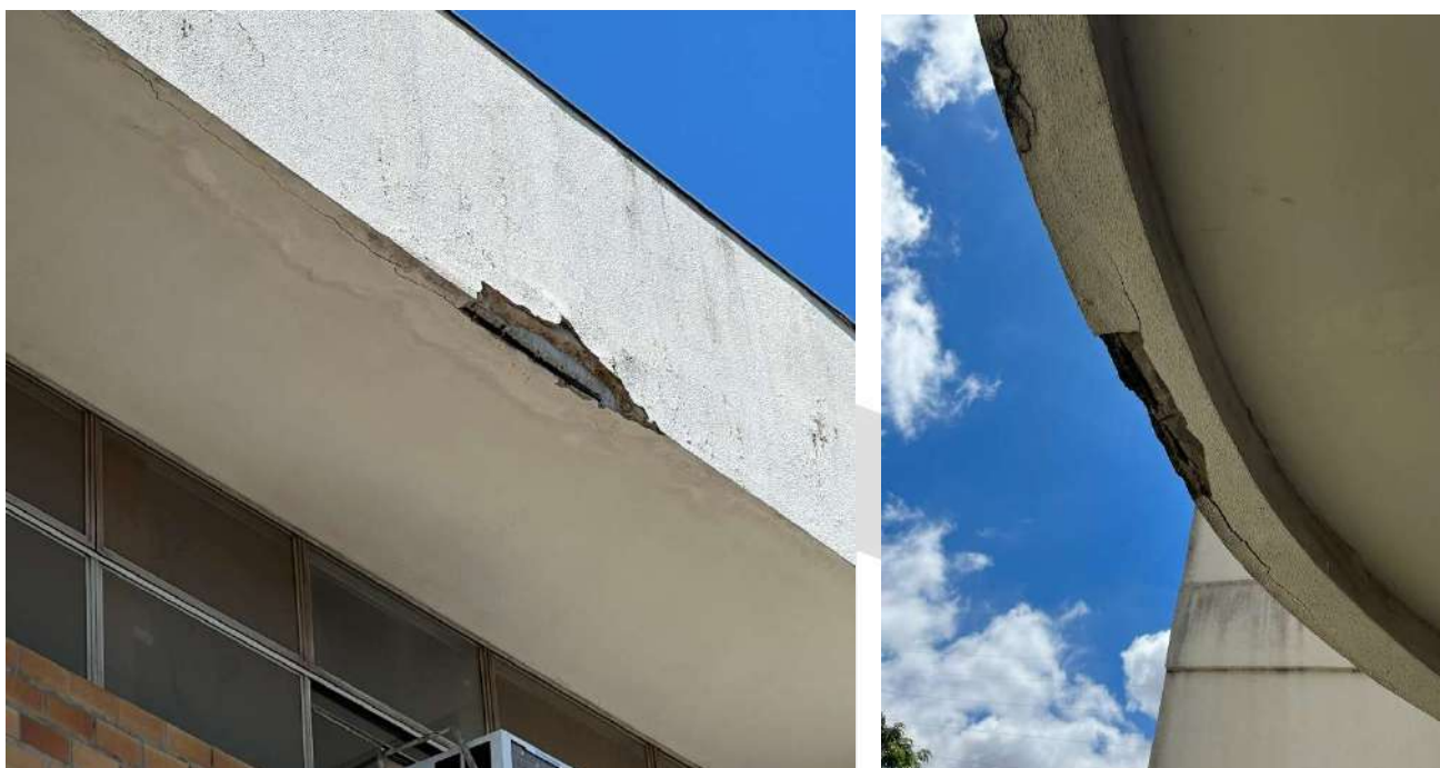
Figura 21: Deslocamento do concreto nas fachadas (Fonte: O Autor)
