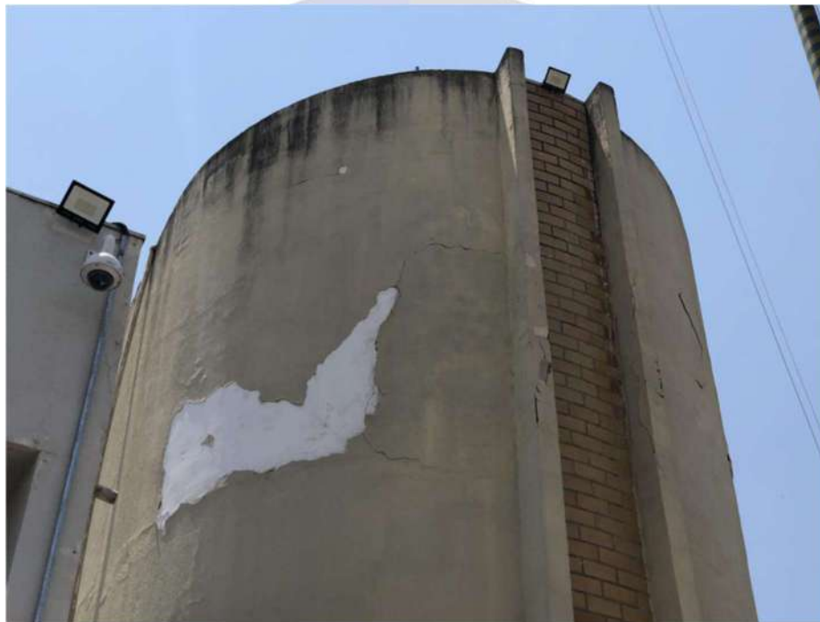
Figura 22 – Descascamento da tinta e manchas na parte externa da caixa d’água (Fonte: Thiago Barradas – CPO)
