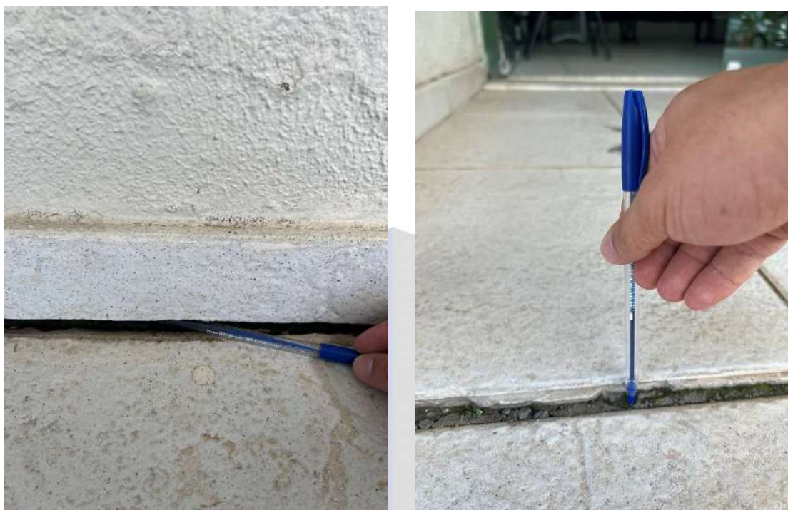
Figura 15 – Pontos de desnivelamento do piso e descolamento de elementos construtivos no NAIS (Fonte: O Autor)
