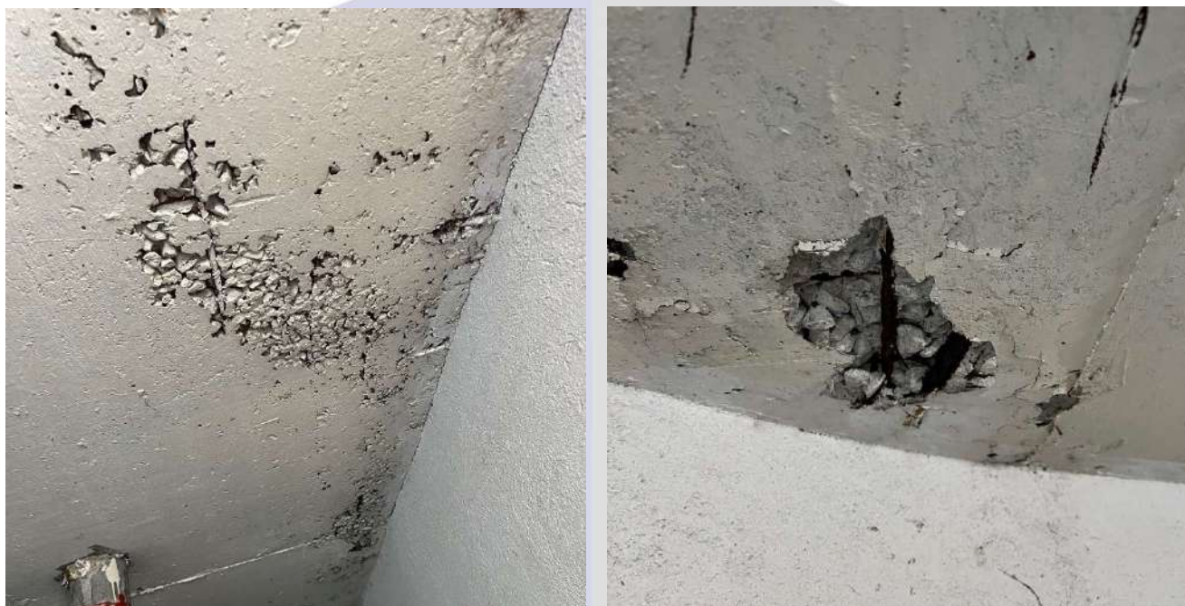
Figura 27 – Pontos de segregação do concreto e formação de ninhos de concretagem (Fonte: O Autor)
