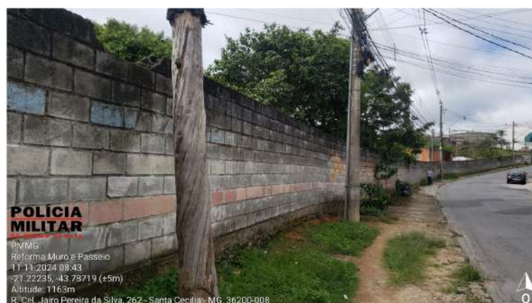
Figura 11 – Passeio frontal: deterioração e vegetação
