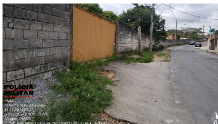
Figura 10 – Passeio frontal: deterioração, vegetação e desníveis
