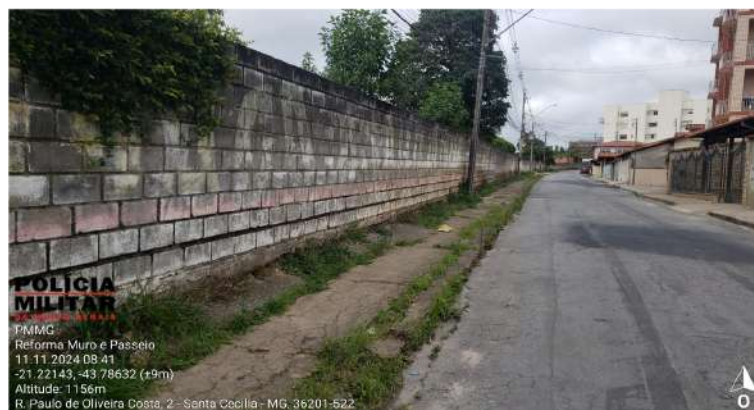
Figura 8 – Passeio frontal: vegetação e trincas
