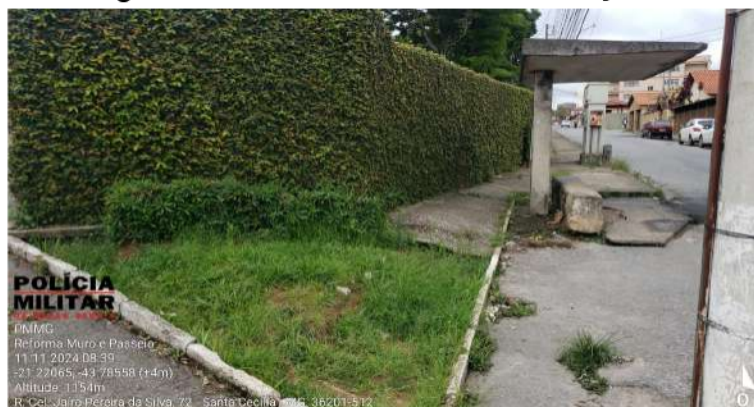
Figura 7 – Passeio frontal: deterioração
