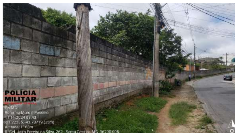
Figura 11 – Passeio frontal: deterioração e vegetação
