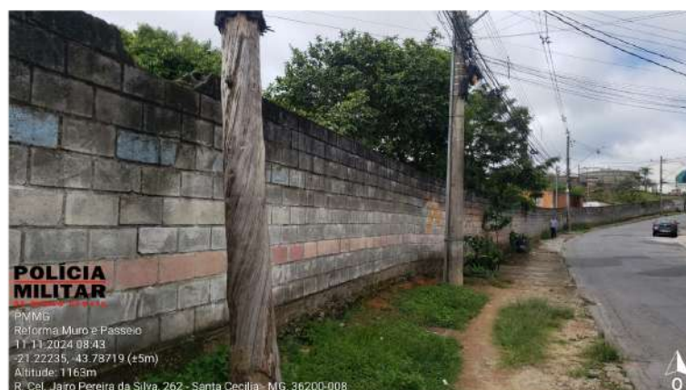
Figura 11 – Passeio frontal: deterioração e vegetação
