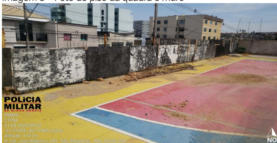
Imagem 3 – Foto do piso da quadra e muro
