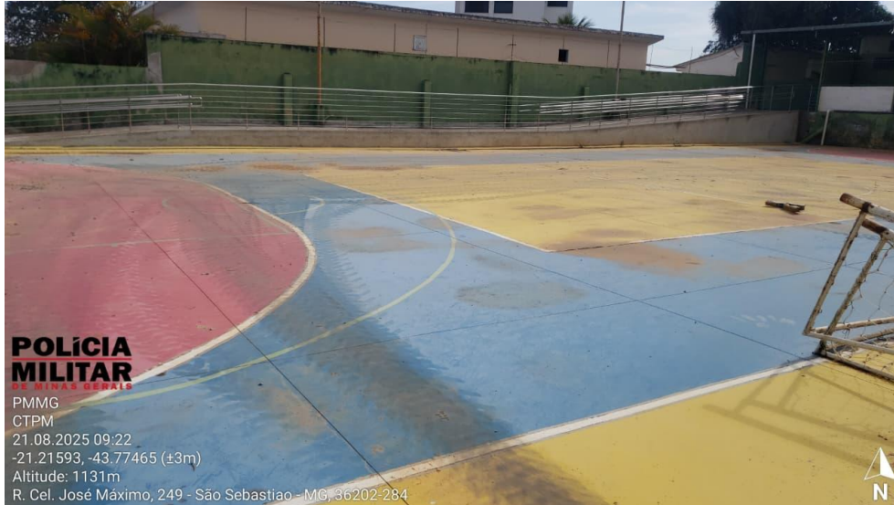
Imagem 1 – Foto do piso da quadra
