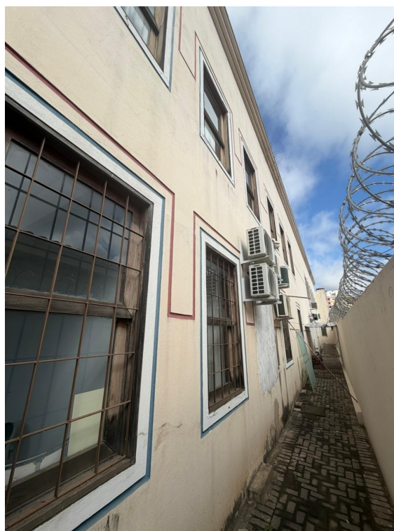
Foto 4 - Área externa e local da condensadora
