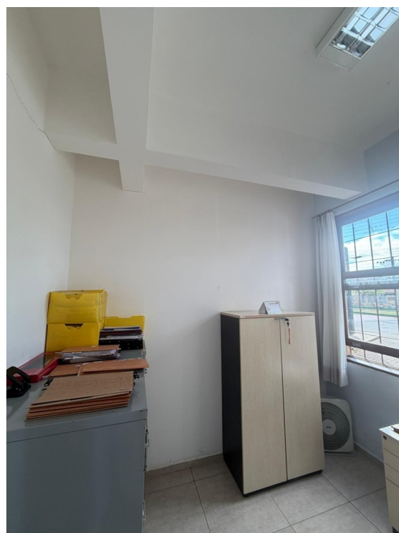
Foto 1 - Local da evaporadora
