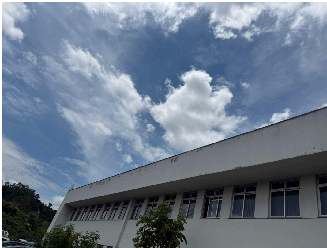
Imagem 4 - Foto fachada lateral apresenta áreas afetadas na platibanda
