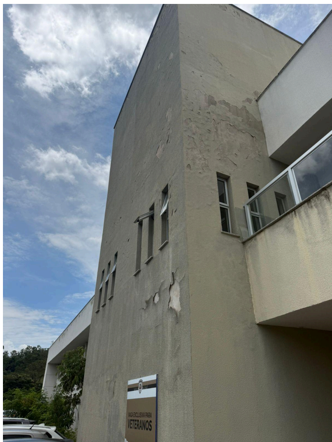
Imagem 2 - Foto da fachada lateral apresenta áreas afetadas
