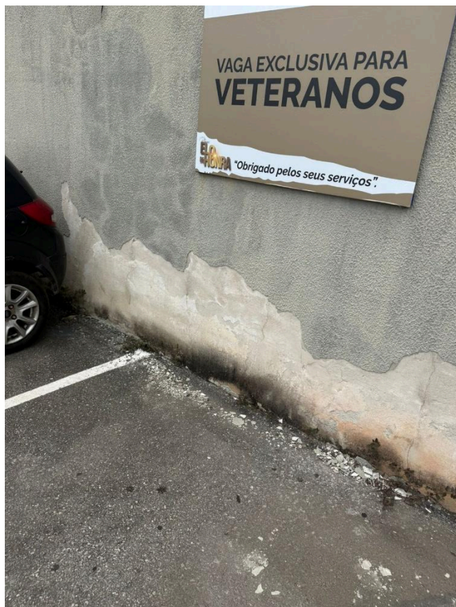
Imagem 3 - Foto fachada lateral apresenta áreas afetadas próximo ao piso
