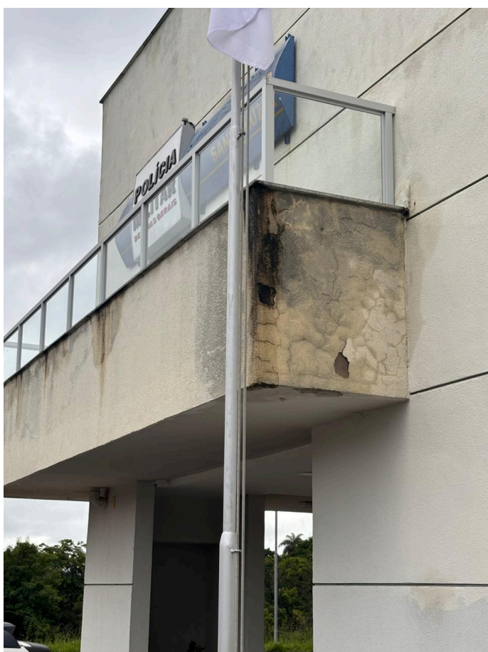
Imagem 6 - Foto da varanda apresenta áreas afetadas ao longo de toda sua extensão
