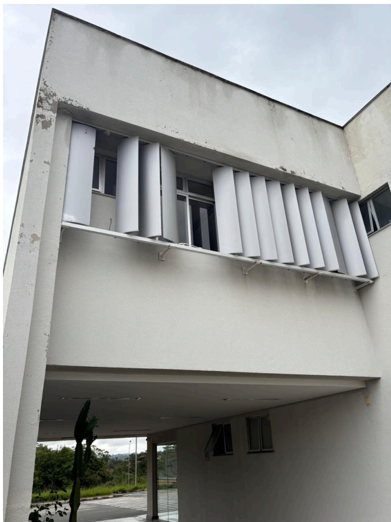
Imagem SEQ Imagem \* ARABIC 1 - Foto da fachada frontal (interna) apresenta áreas afetadas
