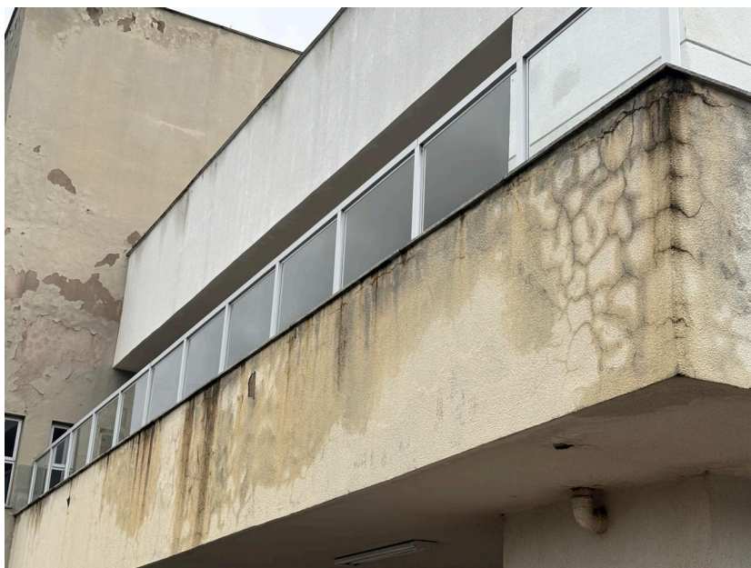
Imagem 5 - Foto da varanda apresenta áreas afetadas ao longo de toda sua extensão
