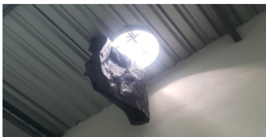
Fig. 08 – Falha na Vedação dos Exaustores
