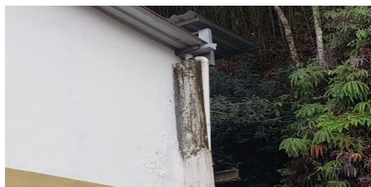
Fig. 14 – Detalhe da necessidade de retoques pontuais na pintura
