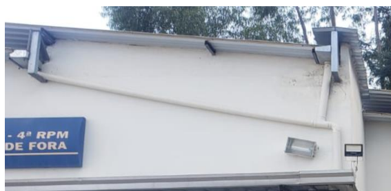
Fig. 06 – Necessidade de Segregação de tubulação
