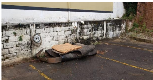
Fig. 15 – Necessidade de Limpeza e Pintura
