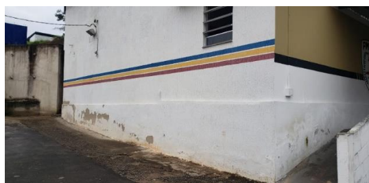
Fig. 13 – Detalhe da não Compatibilização da Pintura
