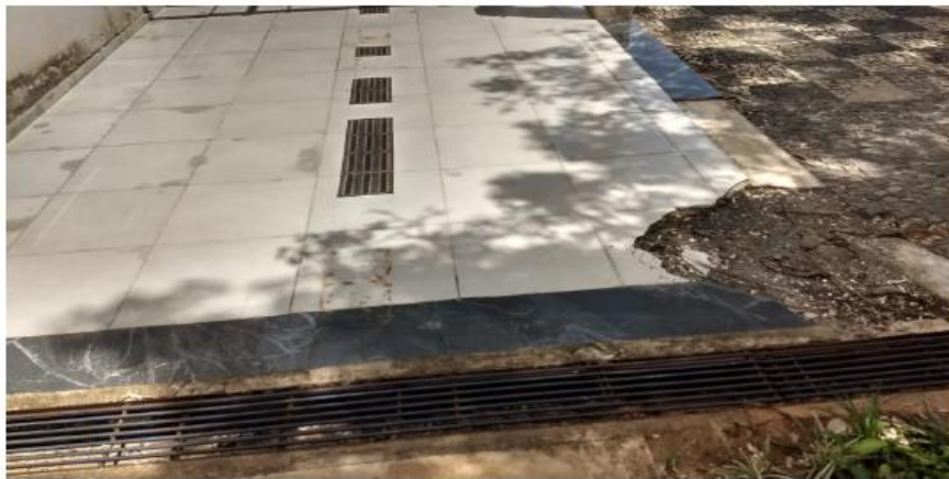
Descrição: Piso danificado/Área de locação do pilar
