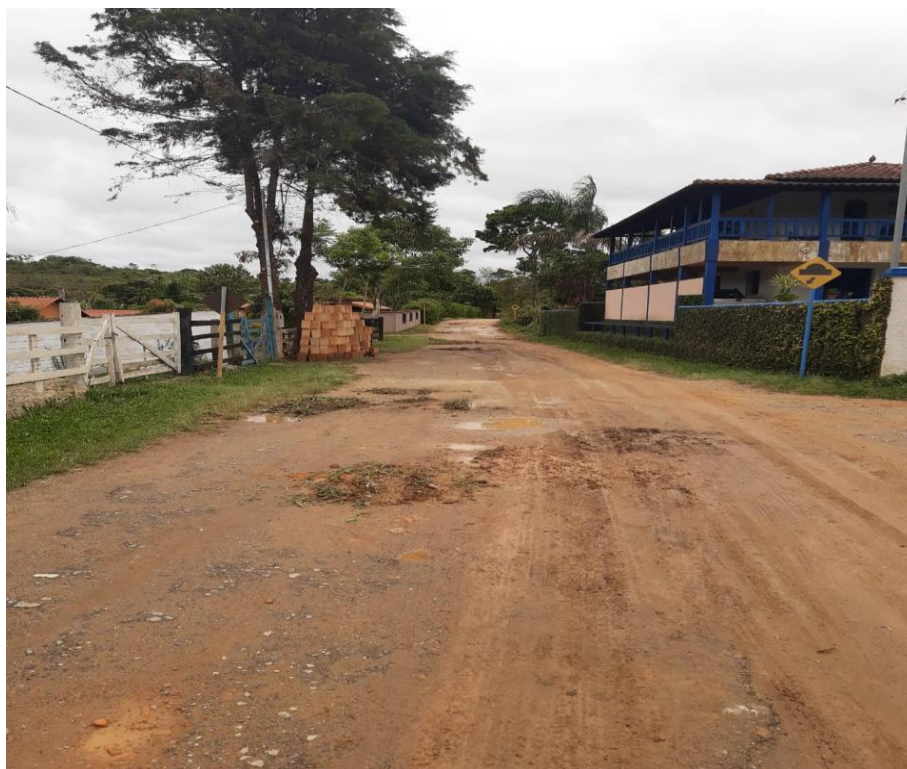
Figura 3: Estrada da Comunidade dos Faleiros a ser pavimentada
