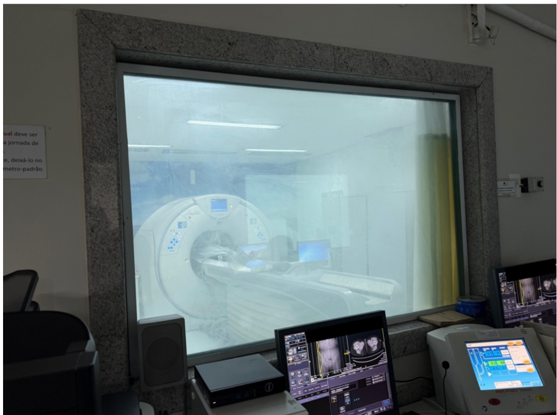
TOMOGRAFIA 1 - VISTA DA SALA DE COMANDO
