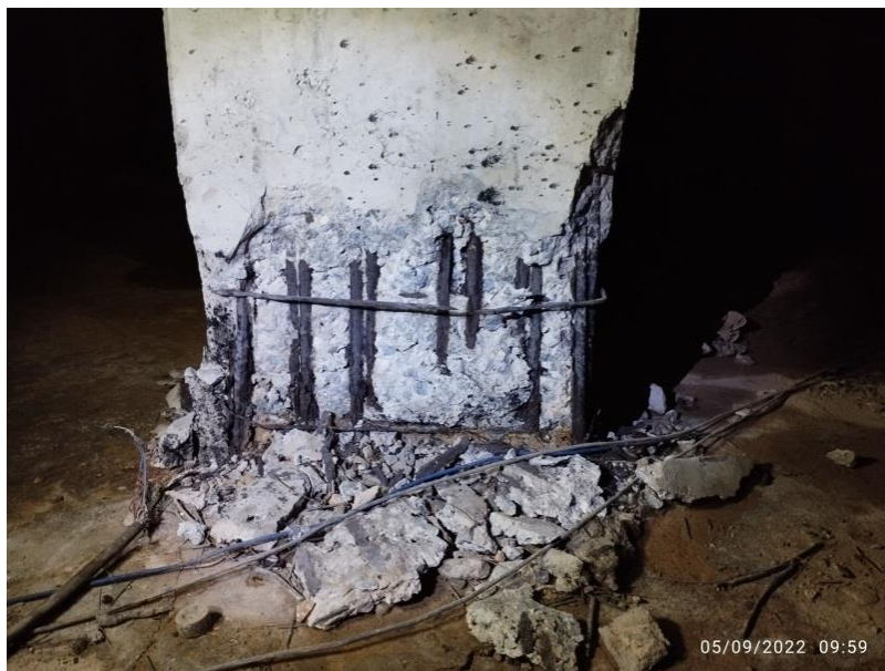
Figura 8: "Pé" do pilar P43 no subsolo da edificação. Fonte: PRA/UFMG. Data: setembro de 2022
