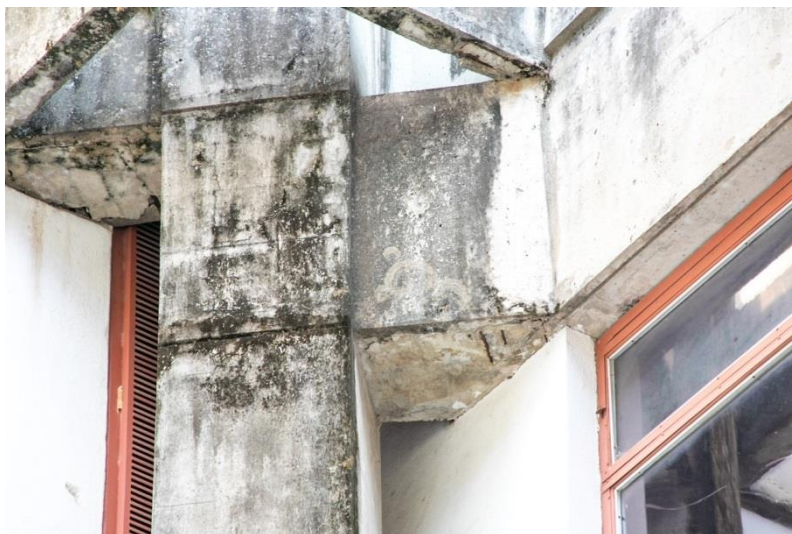
Figura 2: Consolos do pilar P68. Fonte: PRA/UFMG. Data: outubro de 2022.
