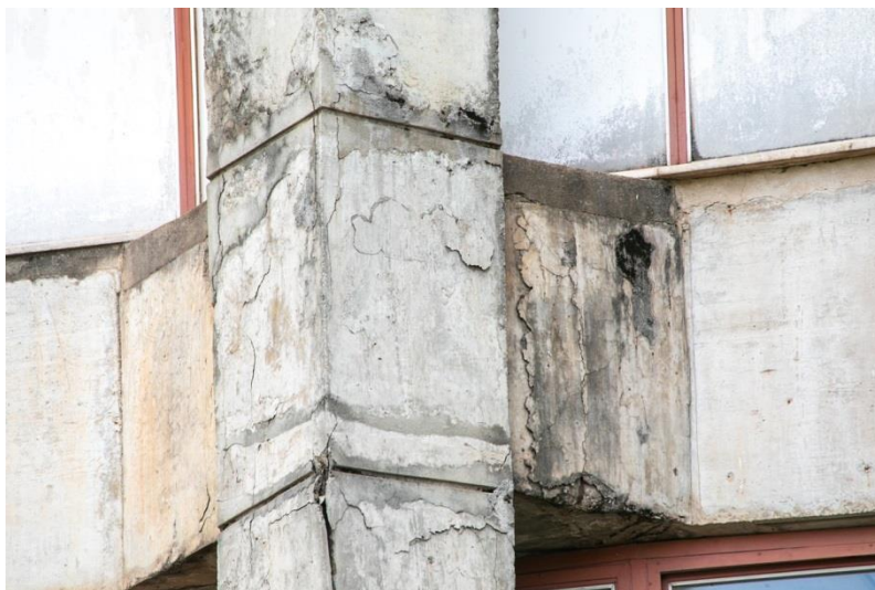
Figura 4: Consolos do pilar P70. Fonte: PRA/UFMG. Data: outubro de 2022.
