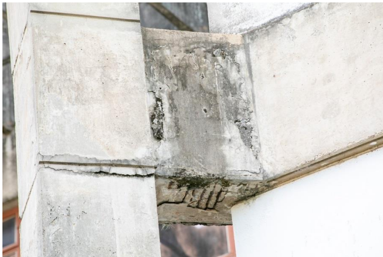
Figura 7: Consolo do pilar P80. Fonte: PRA/UFMG. Data: outubro de 2022.
