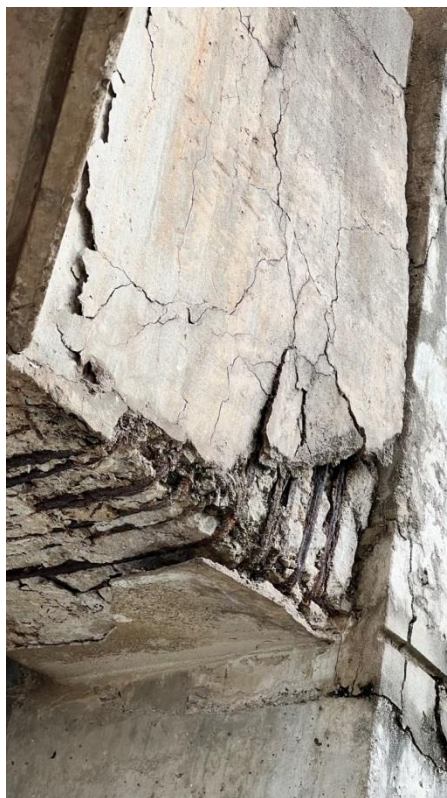
Figura 6: Detalhe do consolo mais deteriorado do pilar P71. Fonte: PRA/UFMG. Data: outubro de 2022.
