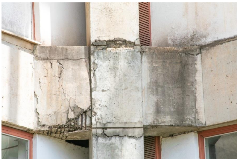
Figura 5: Consolos do pilar P71. Fonte: PRA/UFMG. Data: outubro de 2022.
