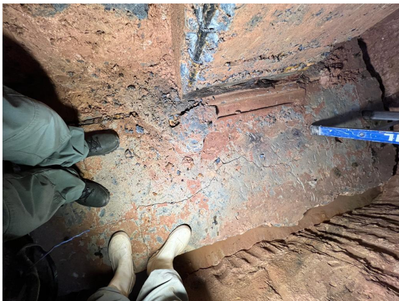
Figura 9: Trincas no topo do bloco do Pilar P43. Fonte: PRA/UFMG. Data: outubro de 2022.
