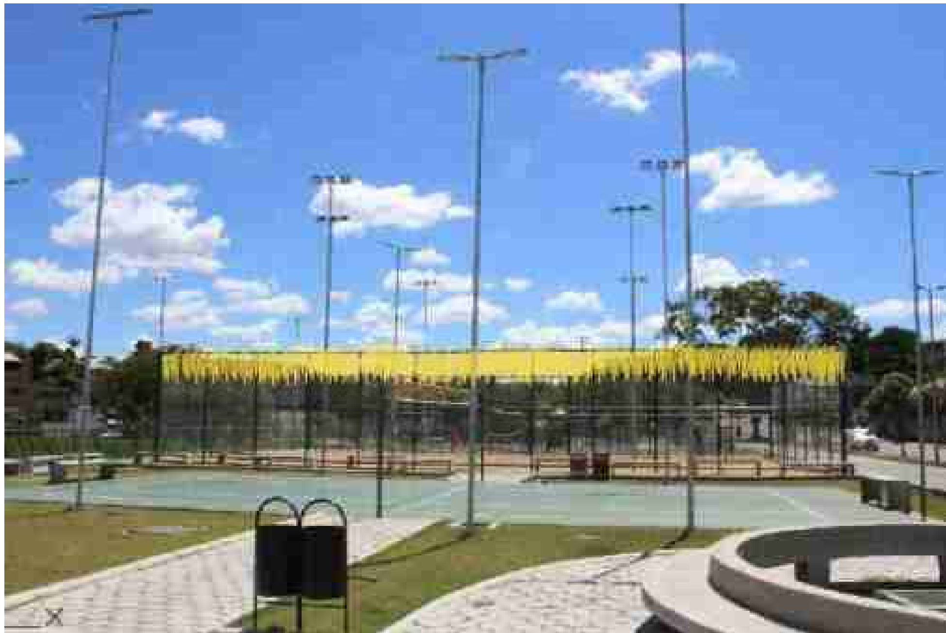
EM VOLTA DE TODO O ALAMBRADO DA QUADRA, CORTINAS DE LED.
