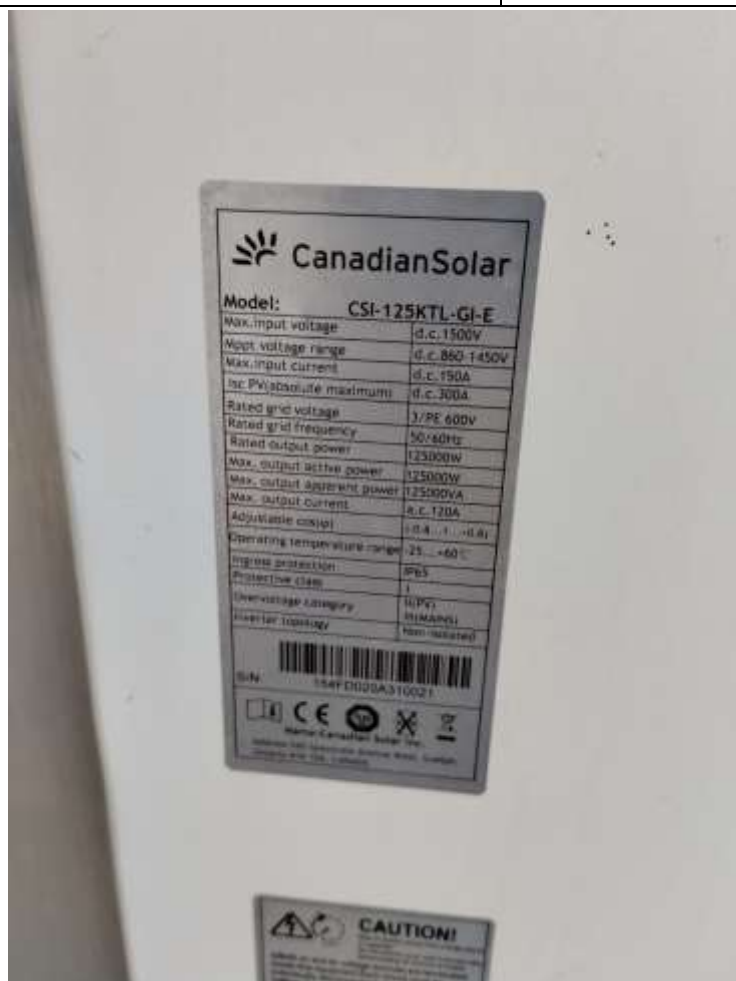
Figura 6.6 - Placa de Identificação dos Inversores
