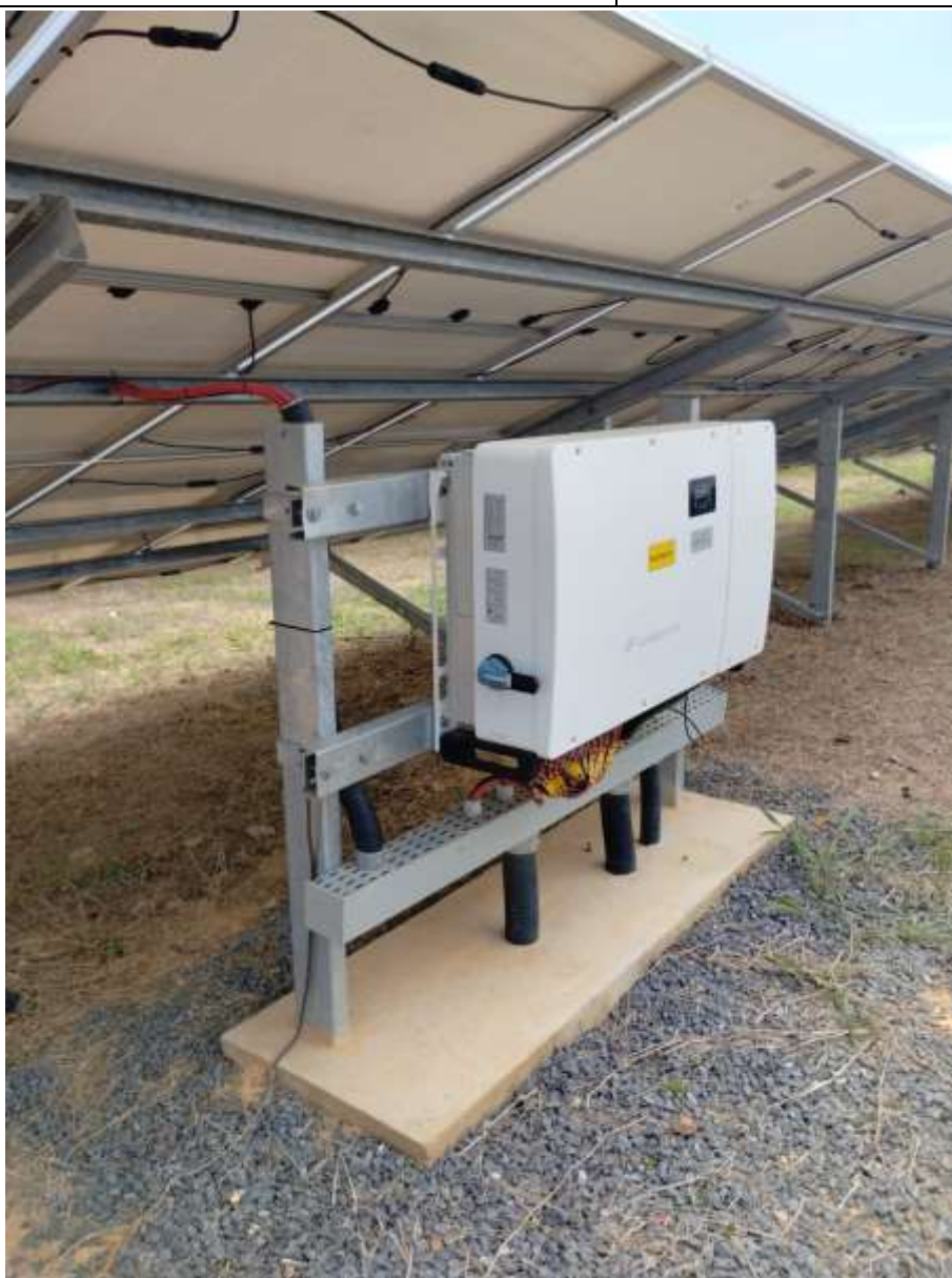
Figura 6.7 - Abrigo dos Inversores
