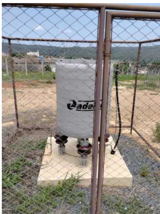
Figura 6.9 – Transformador de Aterramento
