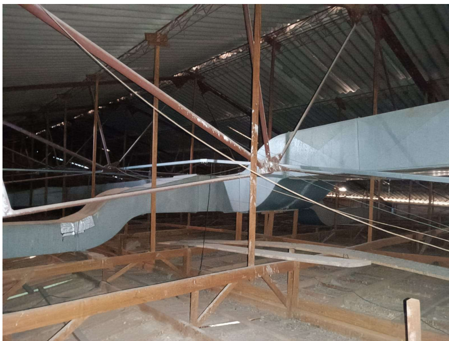
Imagem 13. – Sistemas de Ventilação
