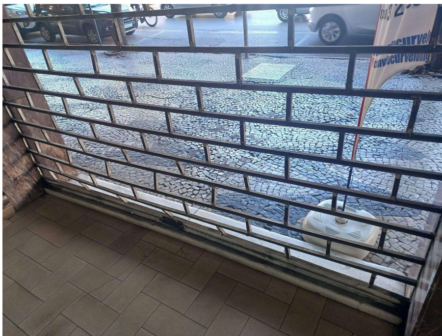
Imagem 08. – Sistemas de Esquadrias (Porta com Deformação excessiva)
