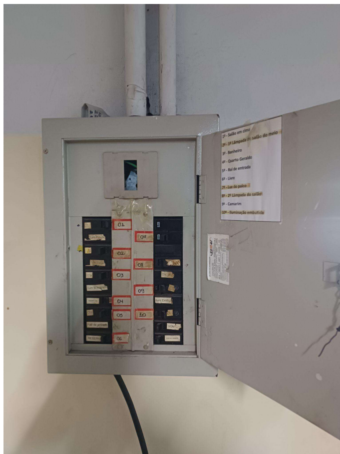
Imagem 11.2.– Sistemas de Instalação Elétrica
