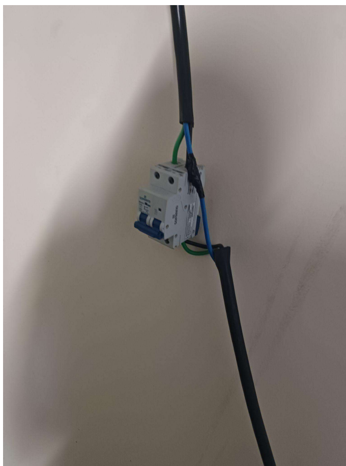
Imagem 11.1.– Sistemas de Instalação Elétrica
