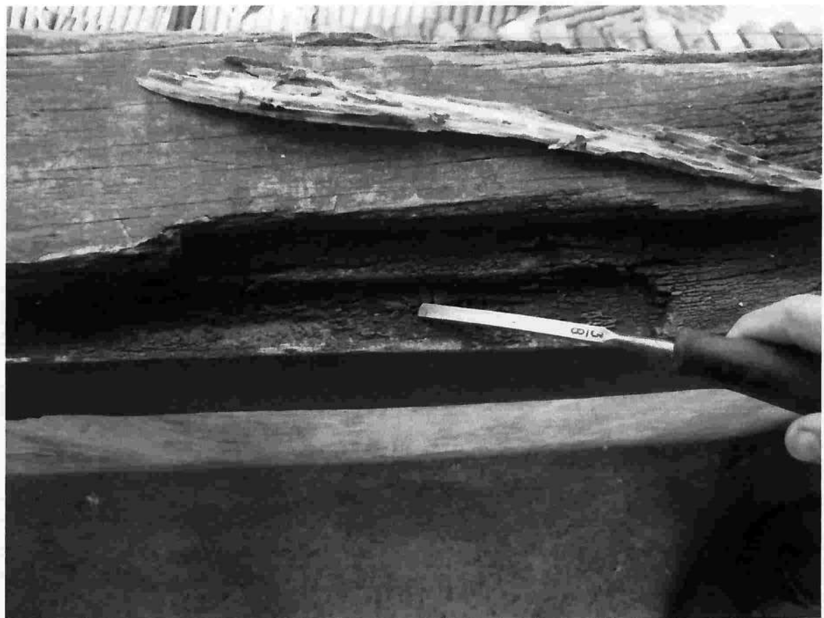
FIGURA 11 – Os constantes ciclos de umedecimento, aliados à ação da radiação solar, num fenômeno conhecido, genericamente, por Intemperismo, tem acelerado e agravado o processo de degradação do madeirame da parede externa da torre do sino.
