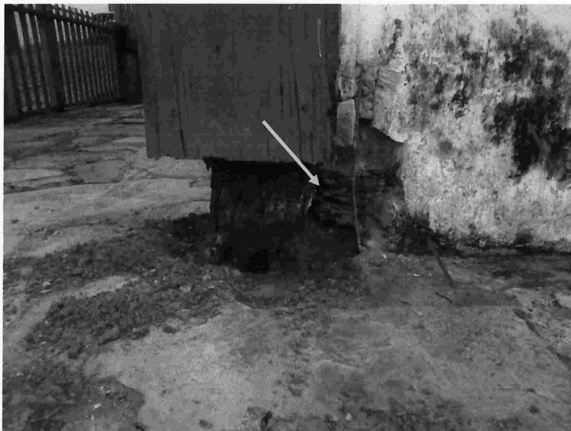
FIGURA 3 – Vista lateral direita do pilar do frontão e do baldrame, indicado pela seta amarela, onde pode ser verificada a degradação concomitante destes elementos estruturais. O lodo (manchas escuras na parede indicadas pelas setas vermelhas) indica a constante presença de umidade nesta região.
