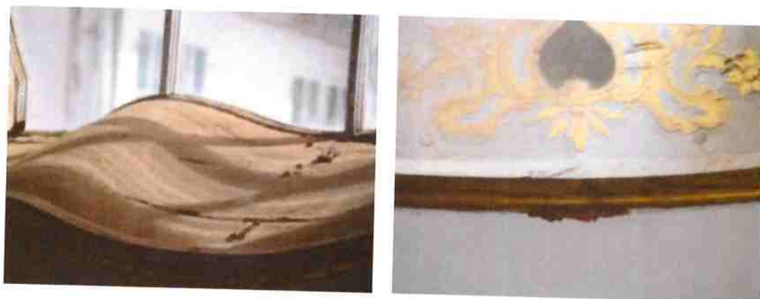
Fig. 7 Degradações do suporte nas molduras da janela da capela-mor
