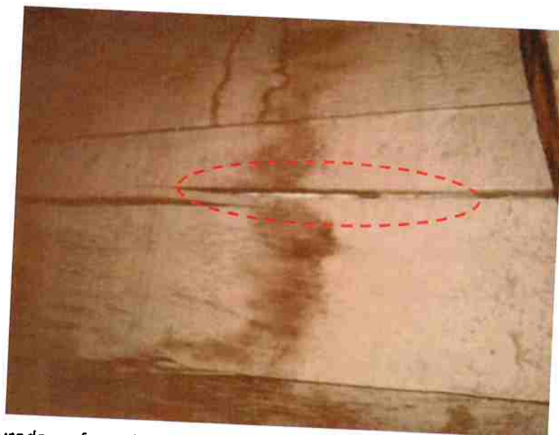
Tábua fraturada no forro do camarim. Na região observa-se as áreas de mancha de escorrimentos de água.
