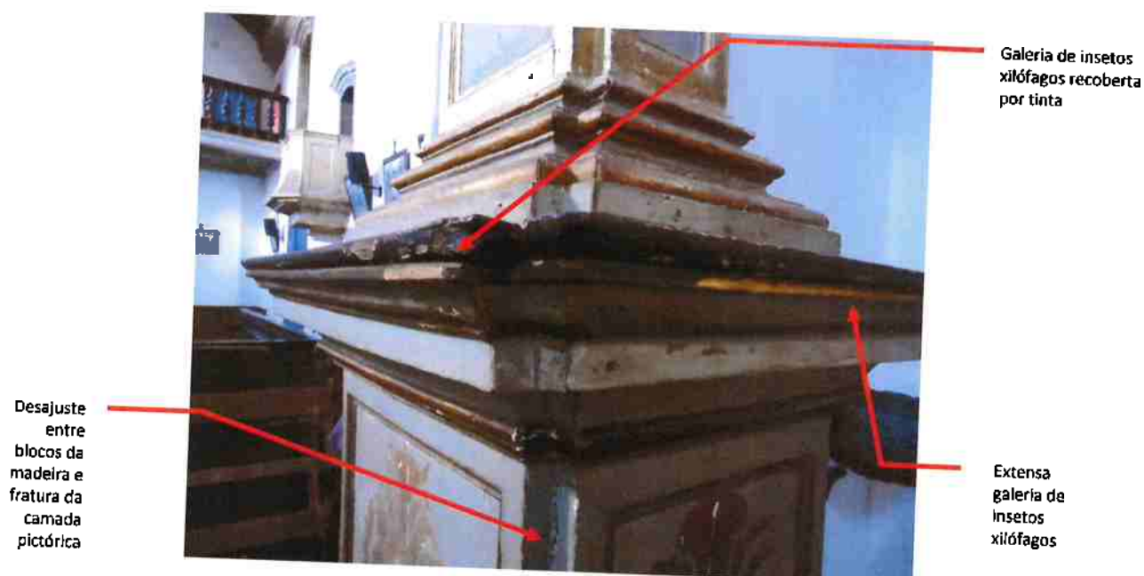
Fig. 11 Degradações nas bases dos pilares do arco cruzeiro
