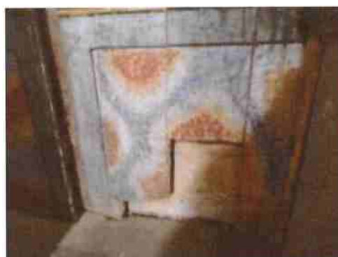
Recorte com perda de suporte em intervenção anterior na parede lateral direita do camarim.
