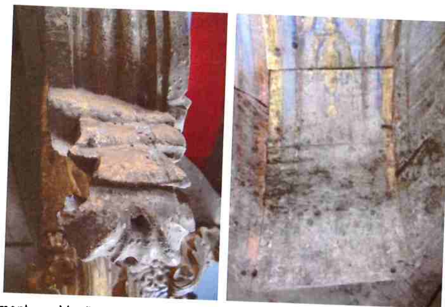
Fig. 5 Degradações no retábulo-mor decorrentes de adaptações e utilização
