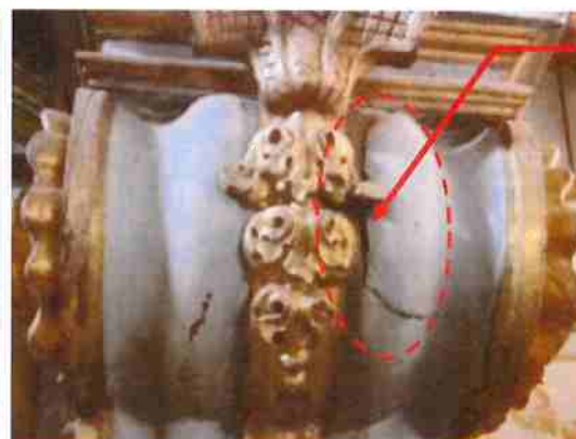
Fratura com deslocamento do bloco
