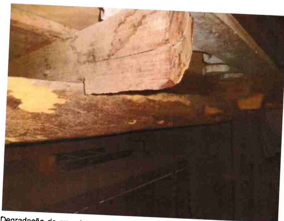
Fig. 6 Degradações nos elementos estruturais na parte posterior do retábulo-mor
