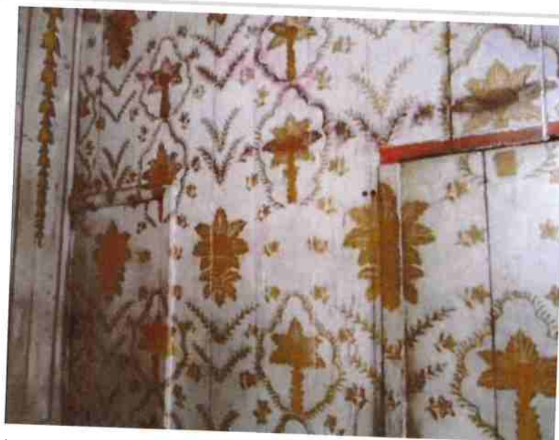
Manchas de migração de pinturas subjacentes nas paredes do camarim.
