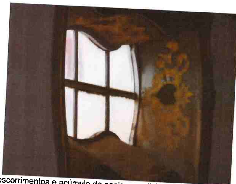
Fig. 8 Degradações da pintura e douramento nas molduras da janela da capela-mor
