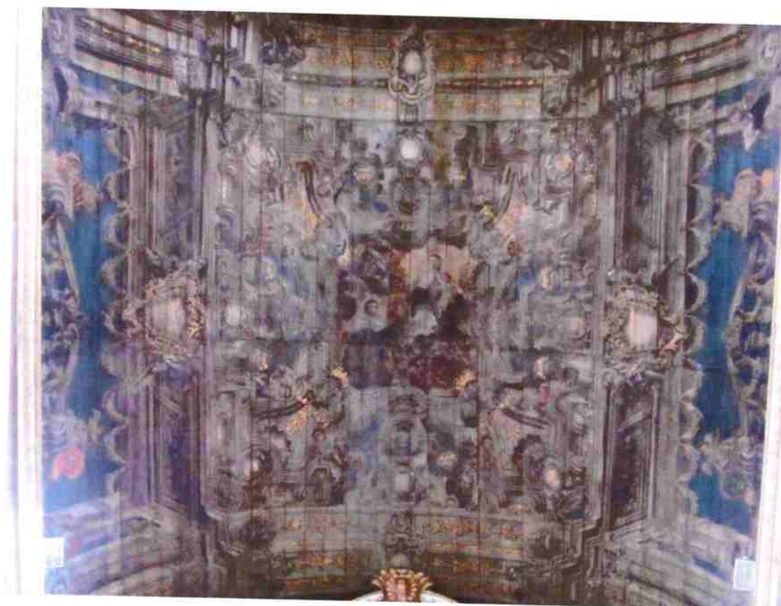
Fig. 1 Degradações do forro da capela-mor
