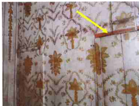
Desprendimento e perda da moldura da porta lateral do camarim.
