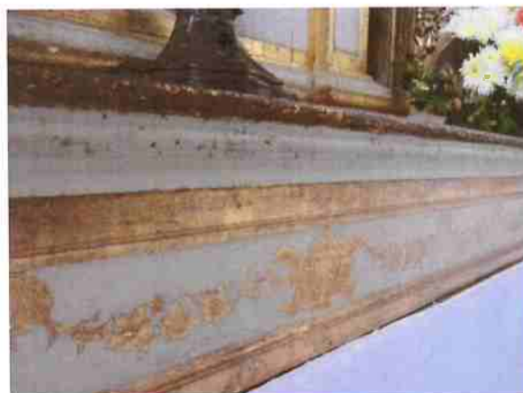
Fig. 4 Degradações da policromia e douramento nos elementos do retábulo-mor
