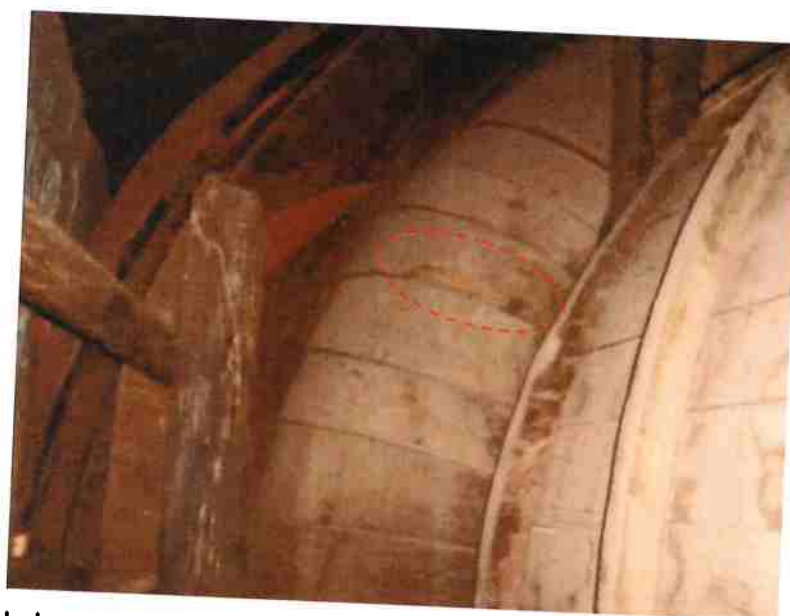
Tabuado no lado posterior do coroamento com fratura e perda de parte de tábua curva.
