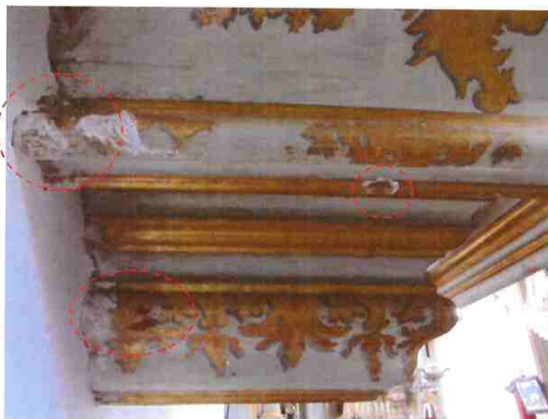
Fig. 21 Degradações estéticas no púlpito
