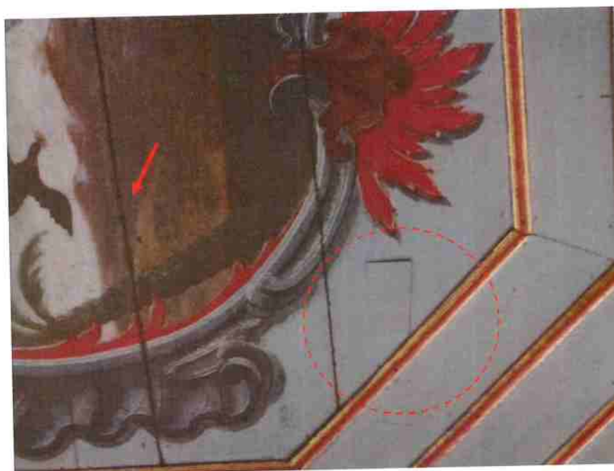
Desajuste em intervenção original e fissura na pintura entre tábuas.
