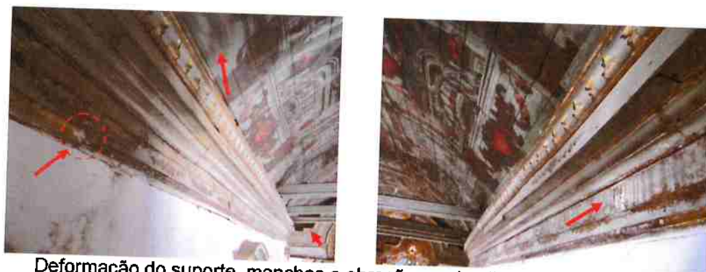
Fig. 14 Degradações de suporte e policromia na cimalha do forro da nave
