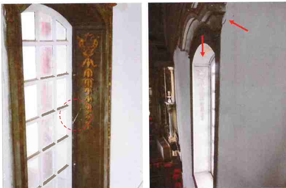
Fig. 23 Degradações das molduras e vergas das janelas da nave
