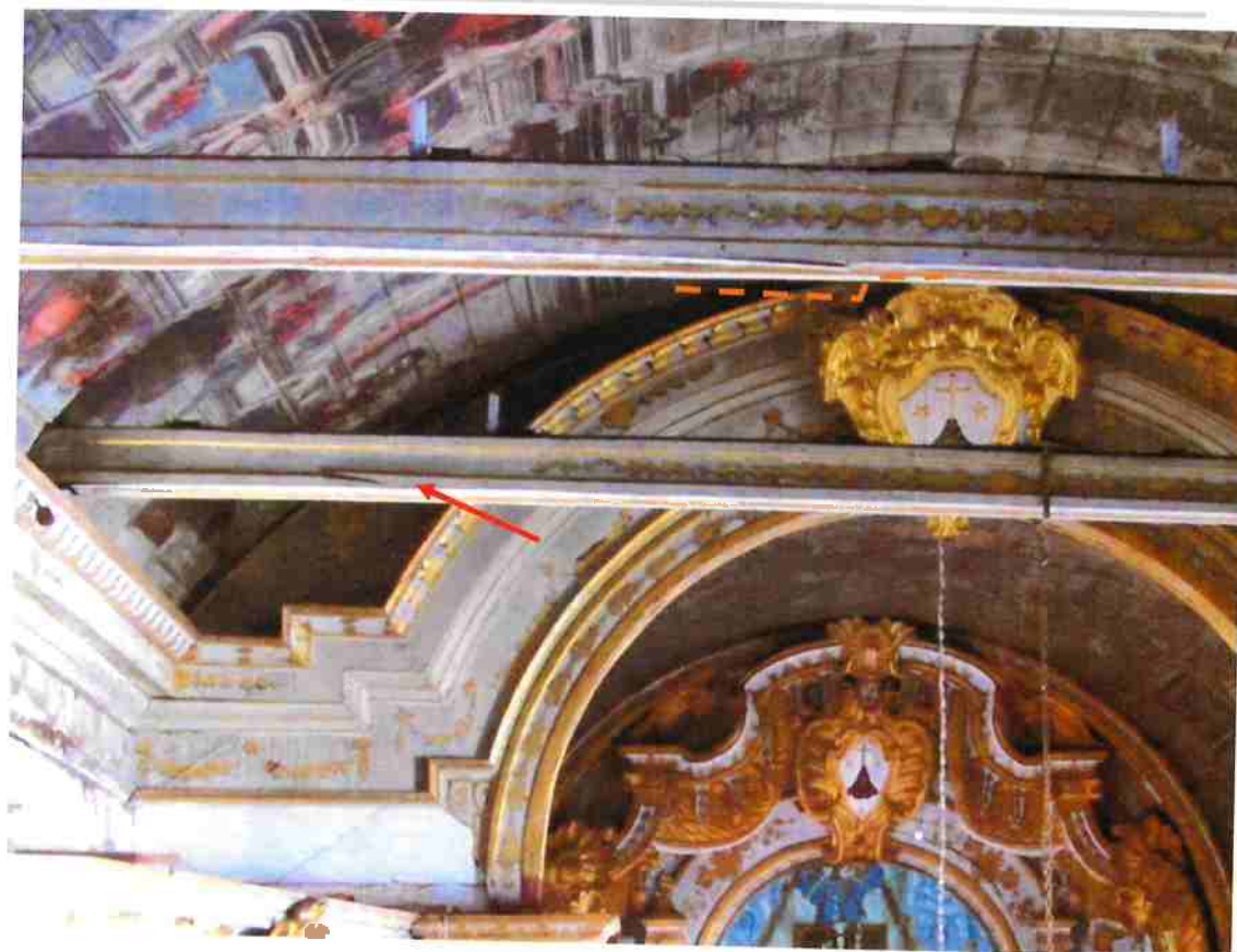
Fratura parcial no tirante próximo ao arco cruzeiro na face voltada para o coro.
