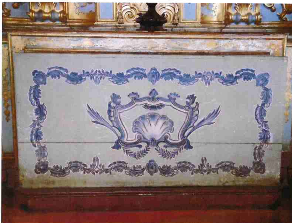
Fig. 17 Degradações da camada pictórica dos elementos de revestimento, talha e douramento do retábulo colateral de Santo Elias
