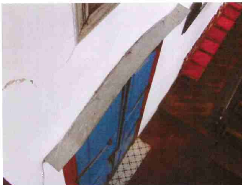
Fig. 24 Degradações das sobrevergas das portas da nave Porta da parede lateral esquerda
