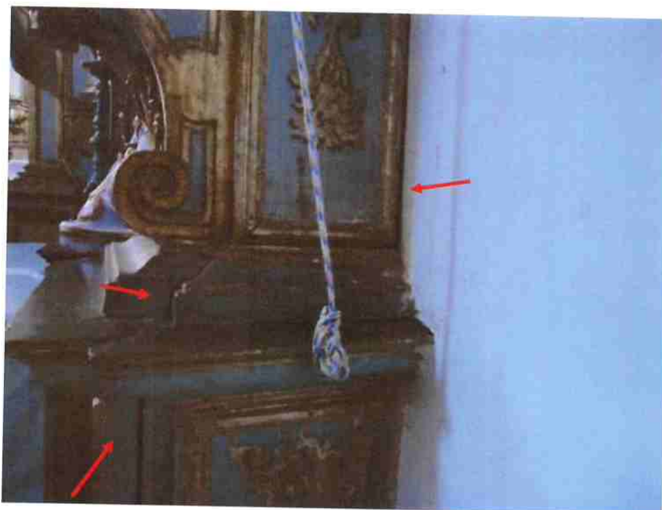
Desajuste e fendas entre blocos e peças construtivas.
