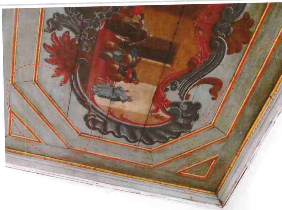
Manchas de alteração cromática na pintura de fundo.
