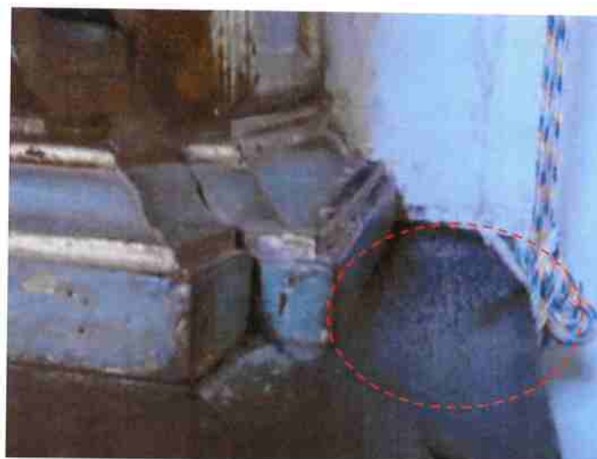
Galerias e ataque ativo de insetos xilófagos
