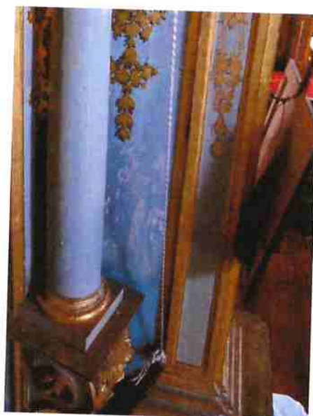
Perdas da policromia na parte inferior do painel lateral do arco cruzeiro ao lado do retábulo colateral esquerdo
