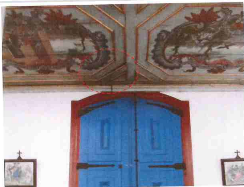
Deslocamento de friso da moldura do painel do forro do átrio e manchas.
