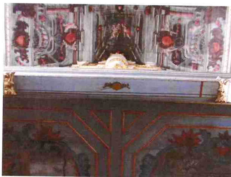
Marcas de intervenções anteriores, frestas e furos.
