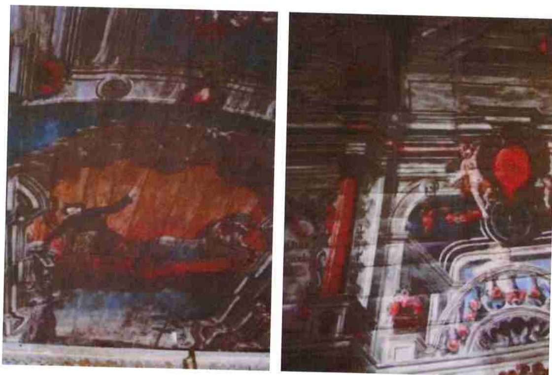
Fig. 13 Degradações do forro da nave
