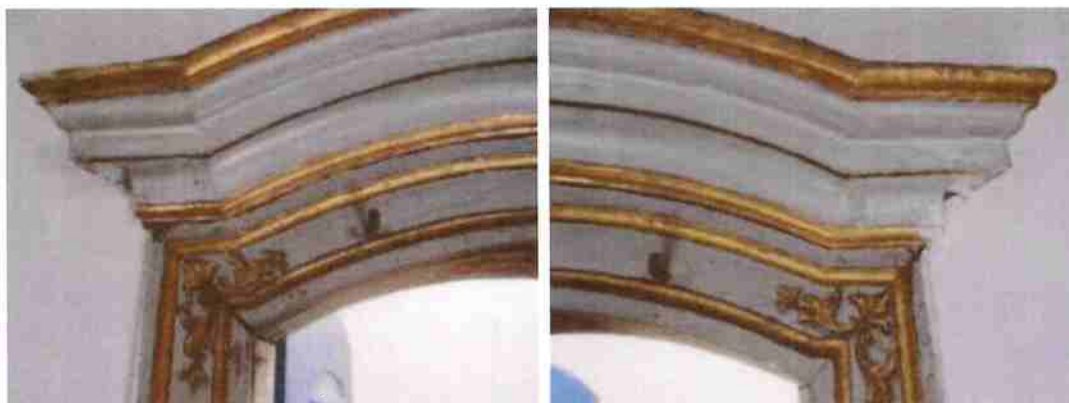
Fig. 22 Degradações da porta de acesso ao púlpito
