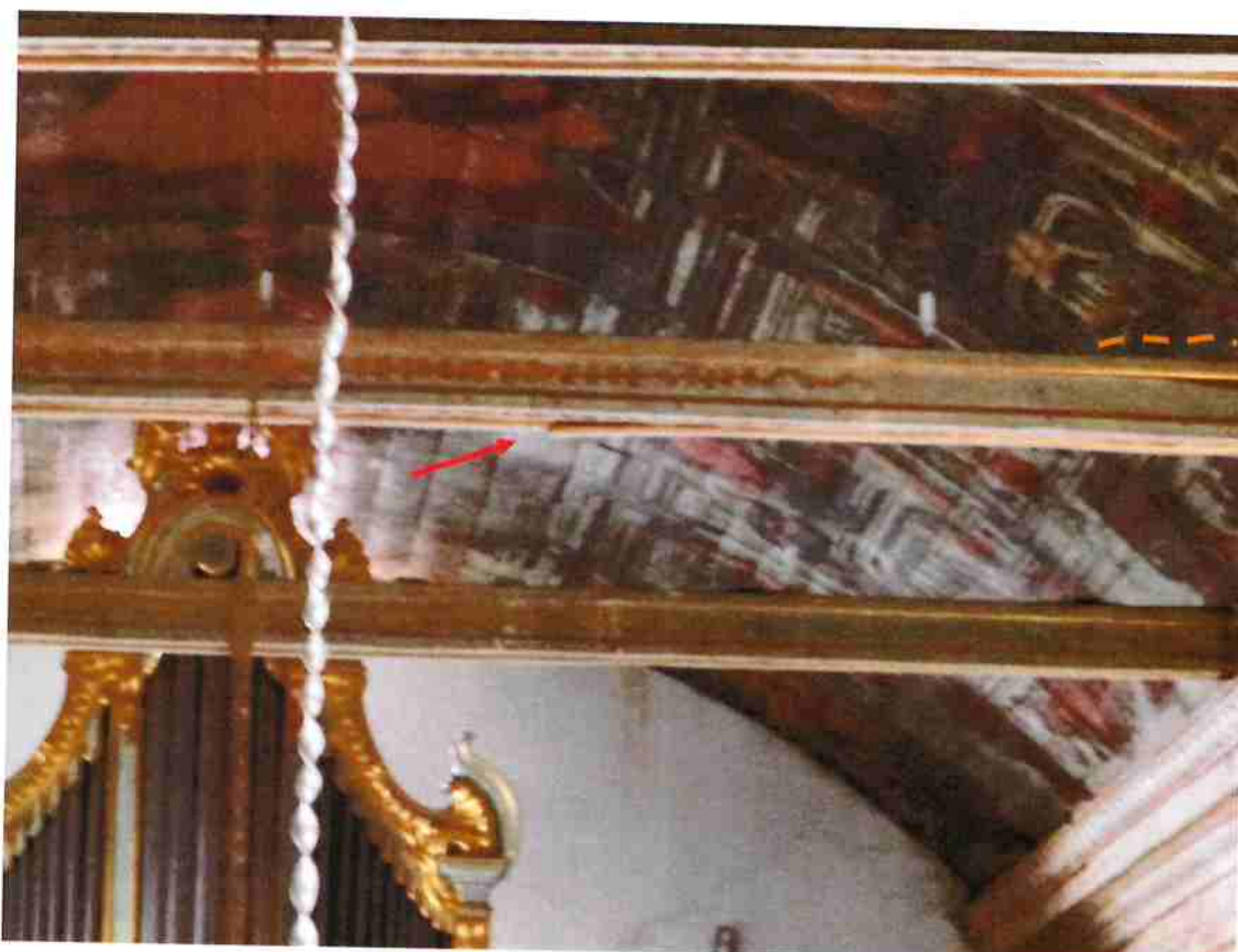
Fig. 15 Degradações dos elementos de revestimento dos tirantes da nave
