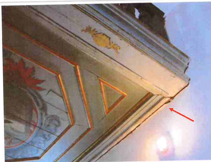
Desajuste na fixação da cimalha à parede e fratura.
