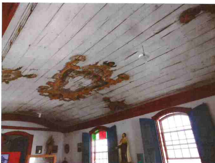
Deformação e desajuste generalizado no tabuado de revestimento.
