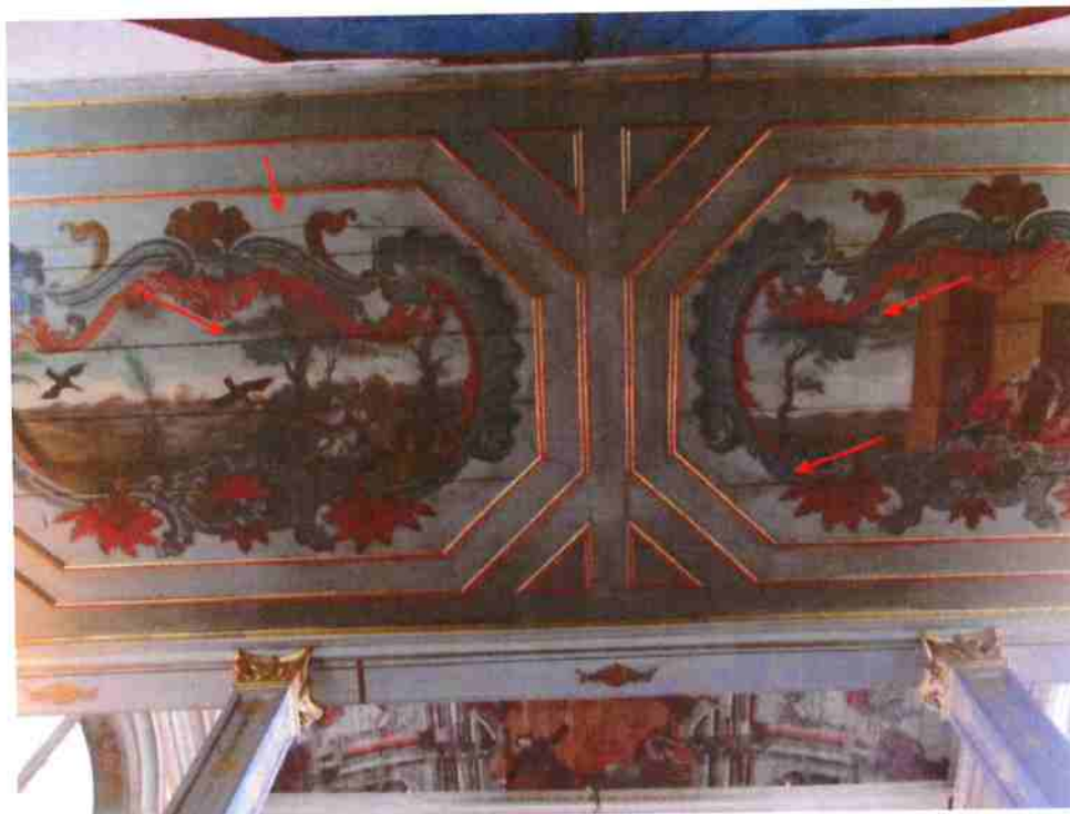
Frestas no encaixe entre as tábuas de composição dos painéis e tábua com fratura longitudinal..
