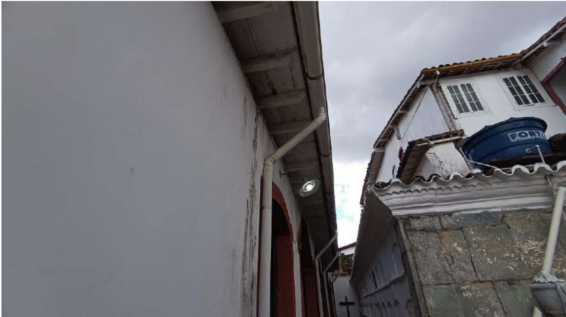
Vista sistema pluvial no alinhamento cobertura 1º Pavimento
