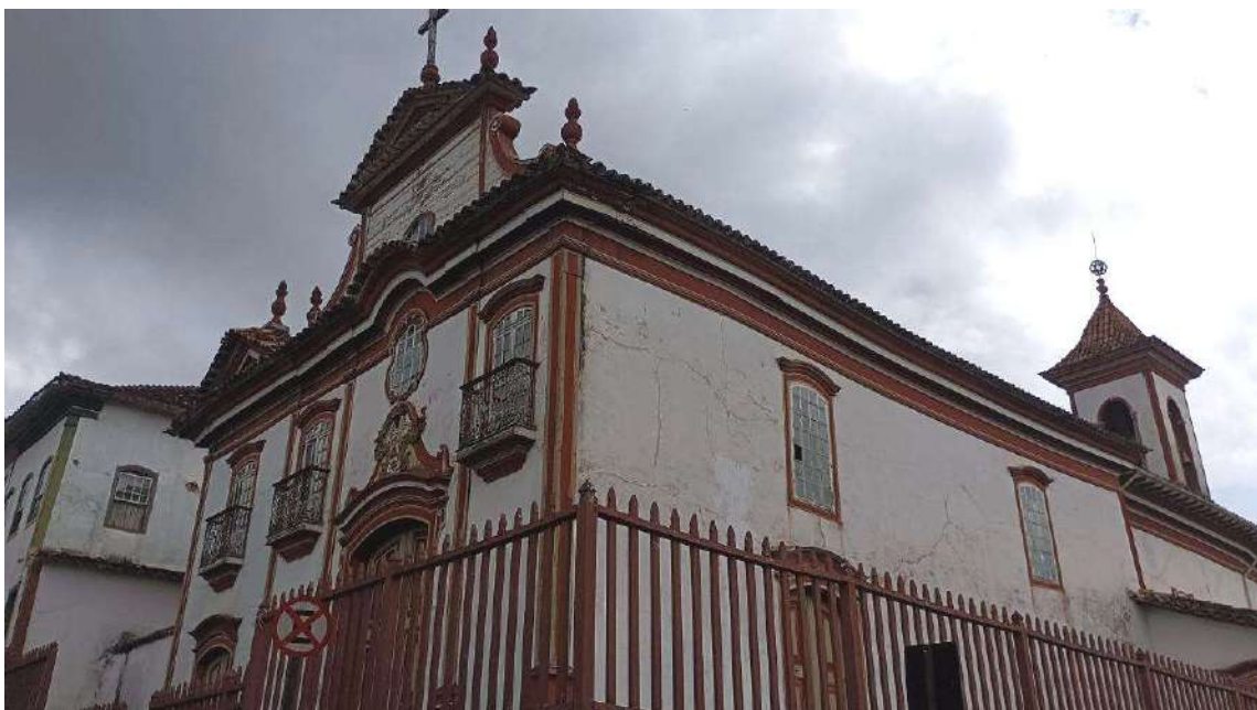
Vista alinhamento Nave sem implantação de sistema de coleta e condução
