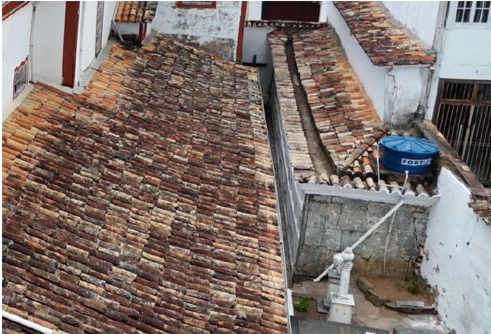
Vista sistema pluvial Carneira
