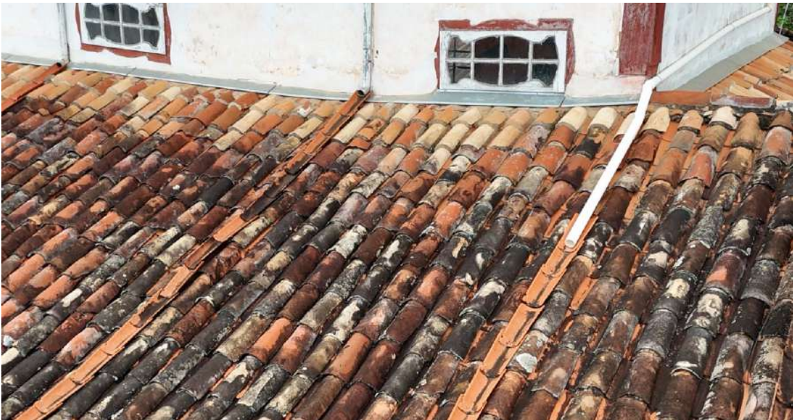
Detalhe Rufos do alinhamento lateral direito e sistema existente do volume pluvial sob telhado
