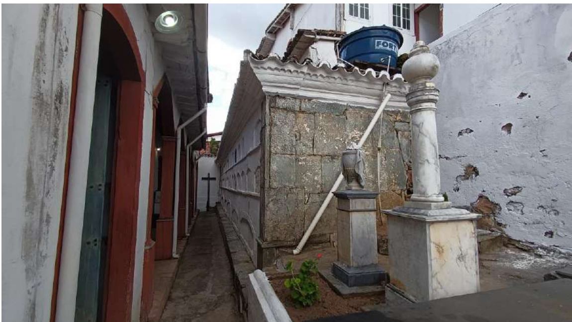
Vista sistema pluvial Carneira
