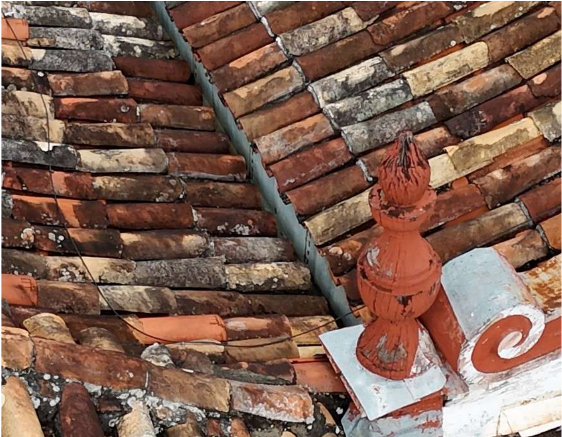
Detalhe sistema de coleta e condução entre cobertura da nave e área lateral esquerda
