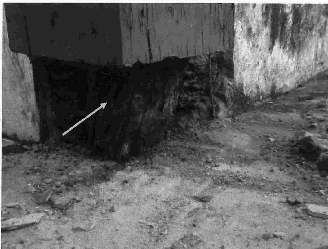
FIGURA 2 – Região do pilar externo do frontão na zona de afloramento, junto à sua base. A seta indica a intensa degradação e apodrecimento do pilar nesta região, comprometendo seu comportamento estrutural.
