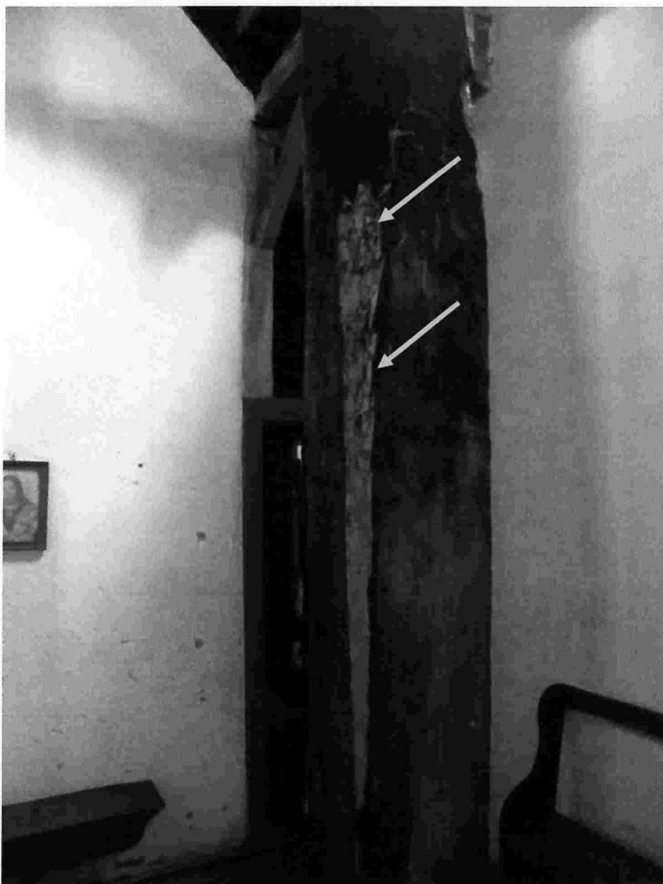
FIGURA 9 – Pilares da torre do sino ao nível do piso da nave. As setas indicam a deterioração da face do pilar devida ao ataque e infestação por Cupim de madeira seca ( Cryptotermes brevis ).
