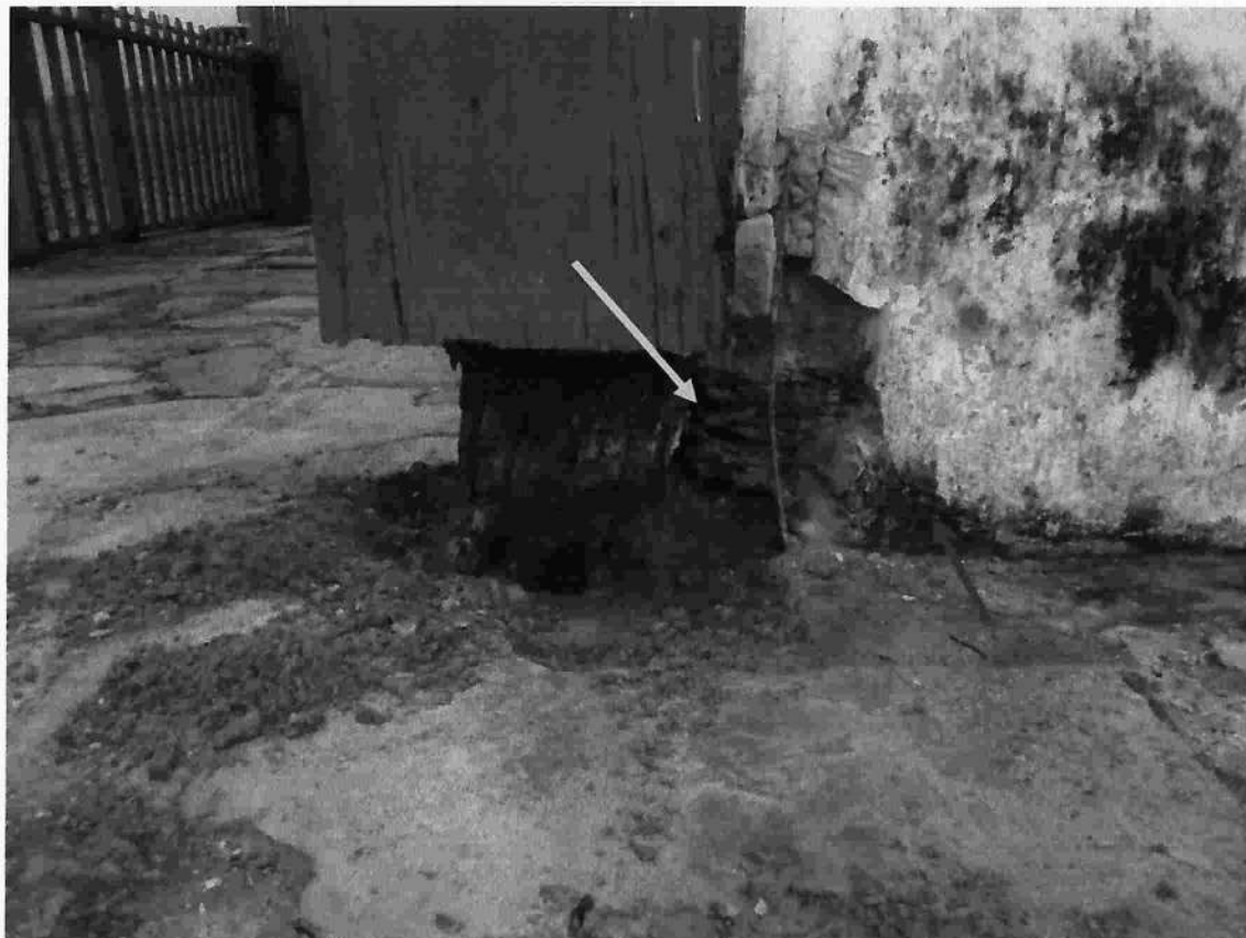
FIGURA 3 – Vista lateral direita do pilar do frontão e do baldrame, indicado pela seta amarela, onde pode ser verificada a degradação concomitante destes elementos estruturais. O lodo (manchas escuras na parede indicadas pelas setas vermelhas) indica a constante presença de umidade nesta região.
