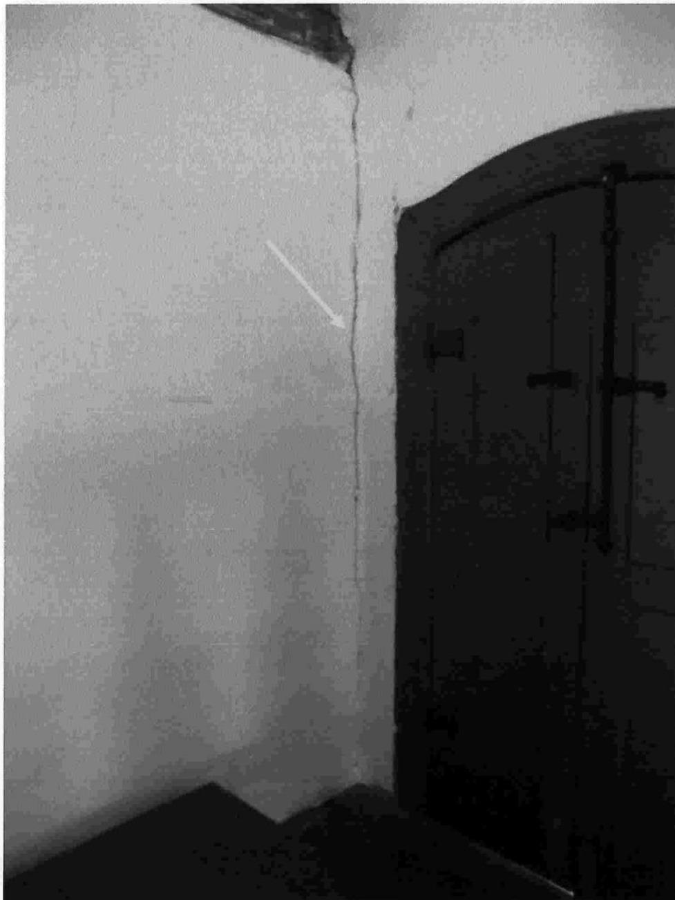
FIGURA 7 – Trinca observada no encontro das paredes lateral direita e frontal. Como pode ser observado, a trinca cresce, verticalmente, no sentido do piso do coro para o frechal, evidenciando a flexão da parede e o seu conseqüente deslocamento angular para fora da edificação.
