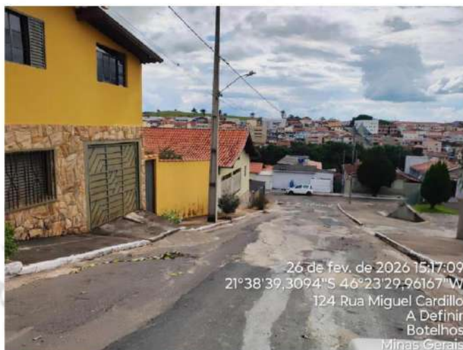
Figura 4 - Parte crítica da Rua João Ignácio do Lago
