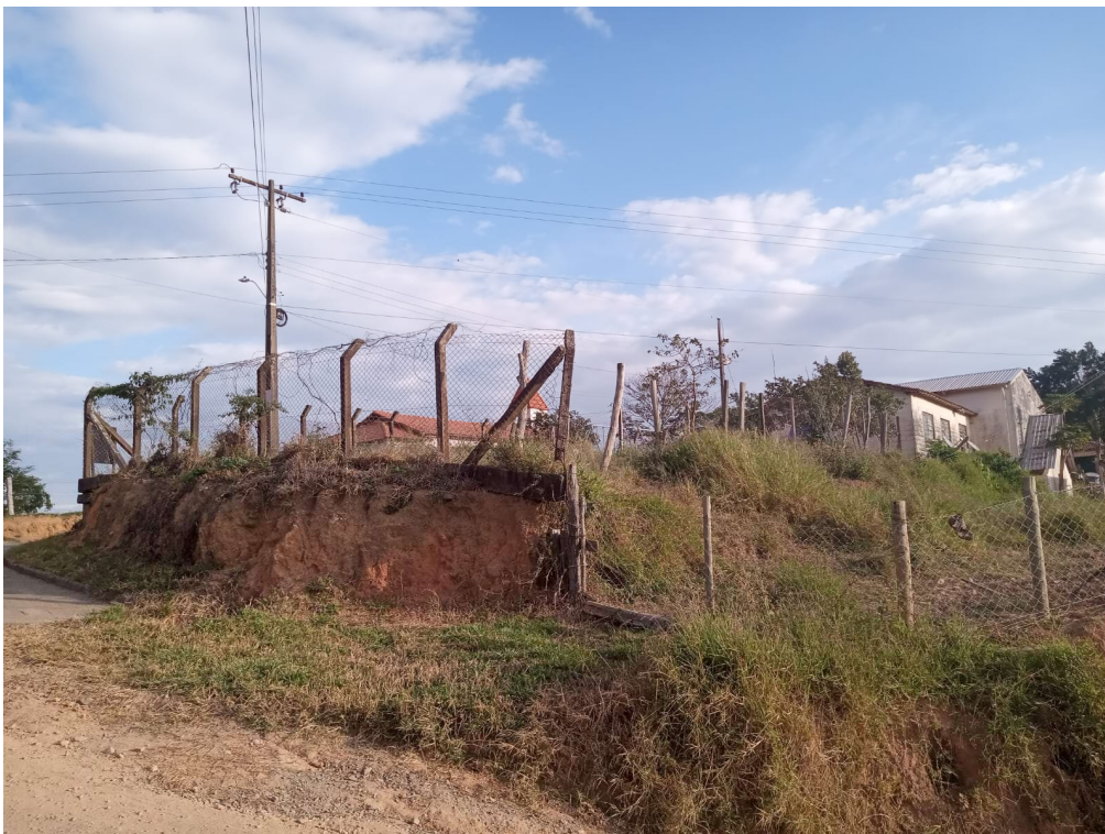
Figura 4: Vista do local onde será executado o muro de arrimo e muro de fechamento (divisa) da Escola Municipal Luiz Augusto de Melo
