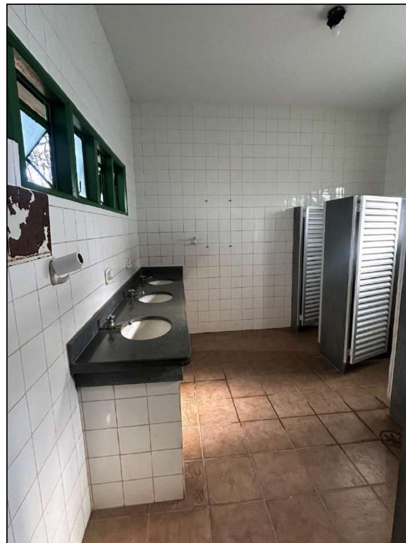
Foto 18 – Sanitário feminino Revestimento cerâmico das paredes em bom estado geral, porém com falhas de manutenção (buracos de fixação expostos e ausência de acessórios). Teto com iluminação improvisada e sem acabamento. Piso cerâmico com desgaste e sujeira nas juntas.
