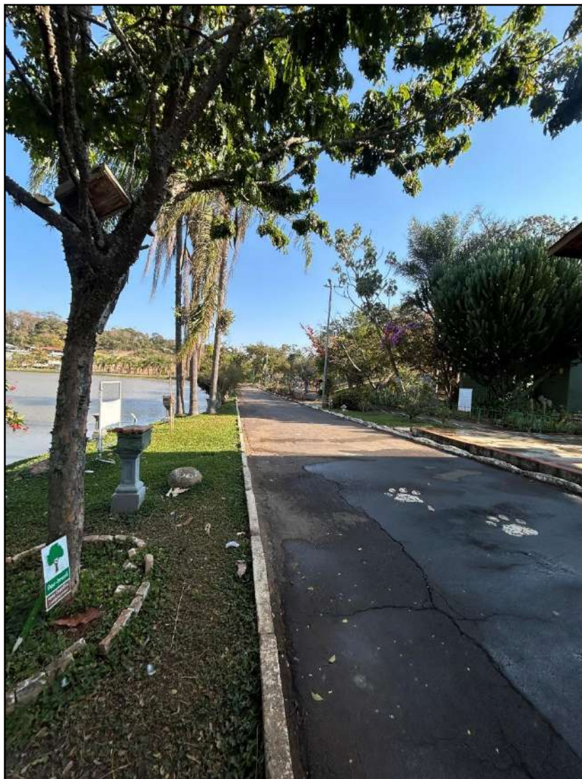
Foto 11 – Via interna de circulação Pavimento asfáltico com fissuras longitudinais e áreas de desgaste superficial, indicando necessidade de recapeamento. Meio-fio em concreto com manchas e pontos de deterioração.
