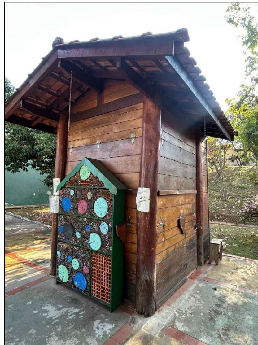
Foto 12 – Estrutura em madeira (anexo coberto) Revestimento em madeira apresentando sinais de desgaste, manchas e pontos de deterioração superficial. Espaço destinado para instalação de uma lanchonete, que seguirá a legislação de um Chamamento Público.
