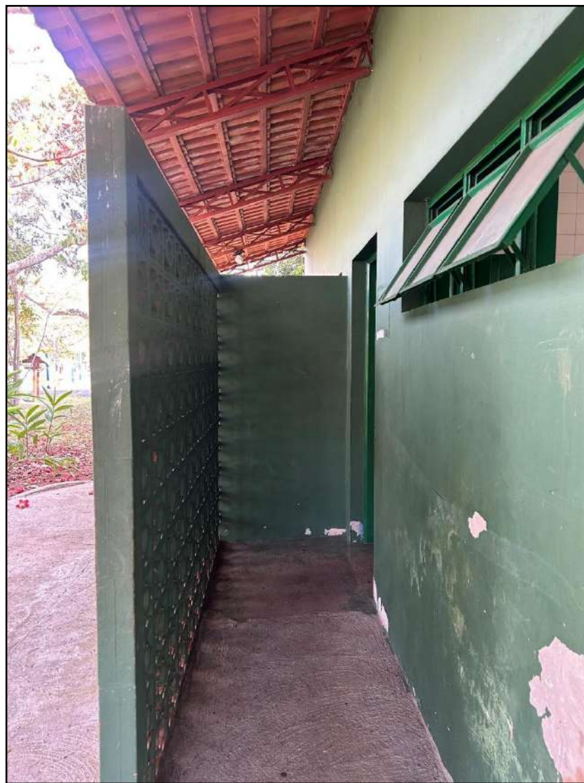
Foto 14 – Área externa de sanitários Paredes externas em alvenaria com pintura deteriorada, apresentando descascamento e manchas de umidade. Revestimento do piso em concreto áspero com sinais de desgaste. Estrutura metálica da cobertura sem manutenção visível.
