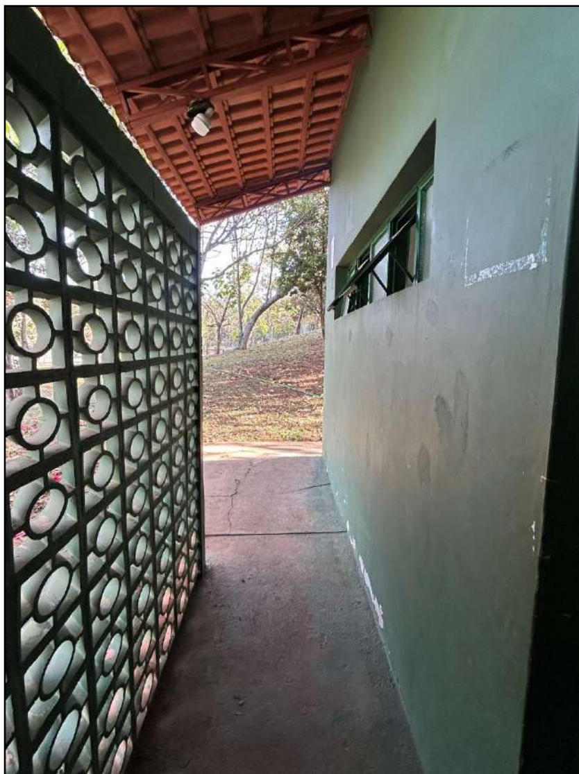
Foto 17 – Acesso lateral aos sanitário feminino Parede de alvenaria com pintura desgastada e descascamento na base, apresentando manchas de umidade. Piso cimentício com fissuras superficiais.
