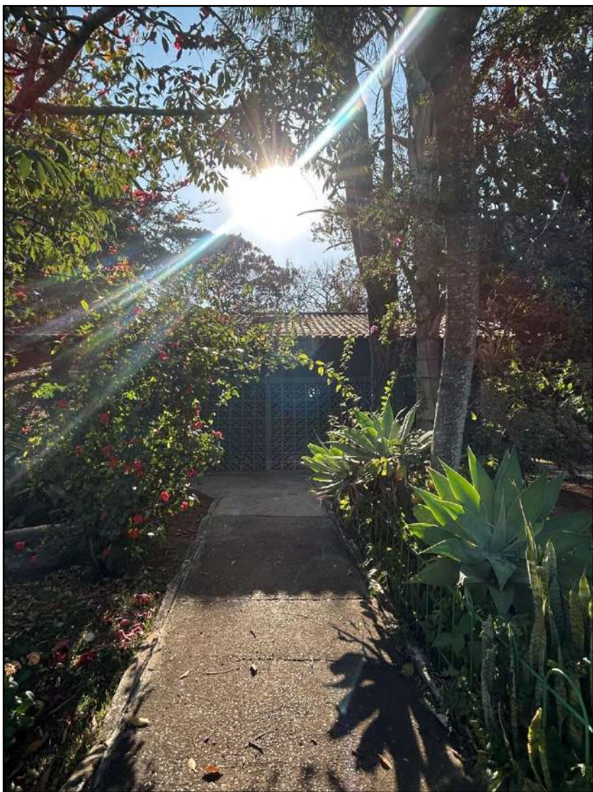
Foto 13 – Acesso aos Banheiros Calçamento em concreto apresentando desgaste superficial e pequenas fissuras, com presença de vegetação lateral invadindo parcialmente o passeio. Necessidade de limpeza, recuperação pontual e recomposição do revestimento.
