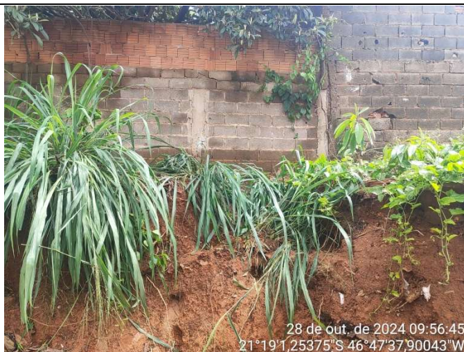
Descrição: VISTA DA VIELA E MURO CAÍDO – 28/10/2024
