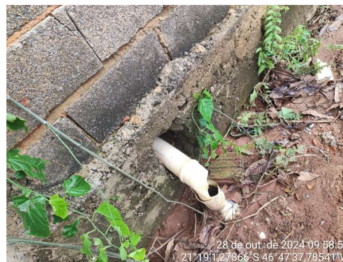
Descrição: COLETA DE ÁGUA PLUVIAL QUEBRADA – 28/10/2024
