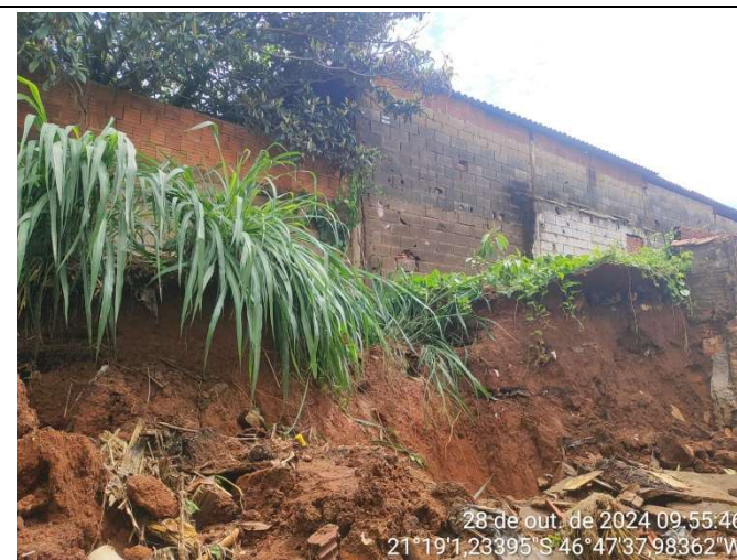
Descrição: VISTA DA VIELA E MURO CAÍDO – 28/10/2024
