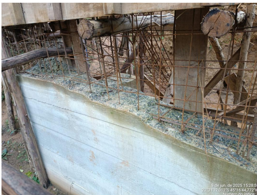
Imagem 6 – Umidade na região de concretagem inacabada Fonte: Acervo pessoal da Projeta Engenharia
