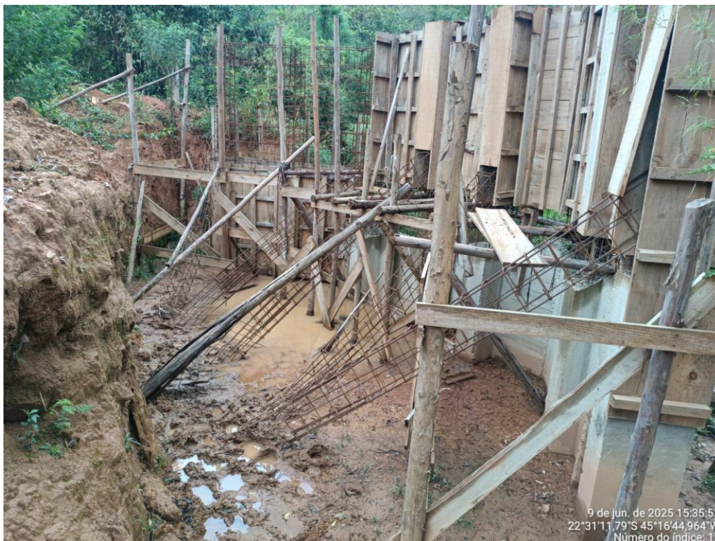
Imagem 7 – Armação exposta em contato com solo úmido Fonte: Acervo pessoal da Projeta Engenharia
