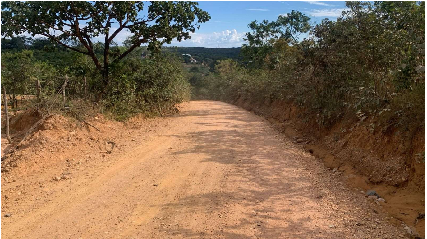
Foto 8: Morro da Cuia, localizado na Estrada Vicinal que interliga os Distritos de Vila Amanda e Vargem Grande à Comunidade da Cuia no Município de Baldim-MG. Fonte: Próprio Autor, 2026.
