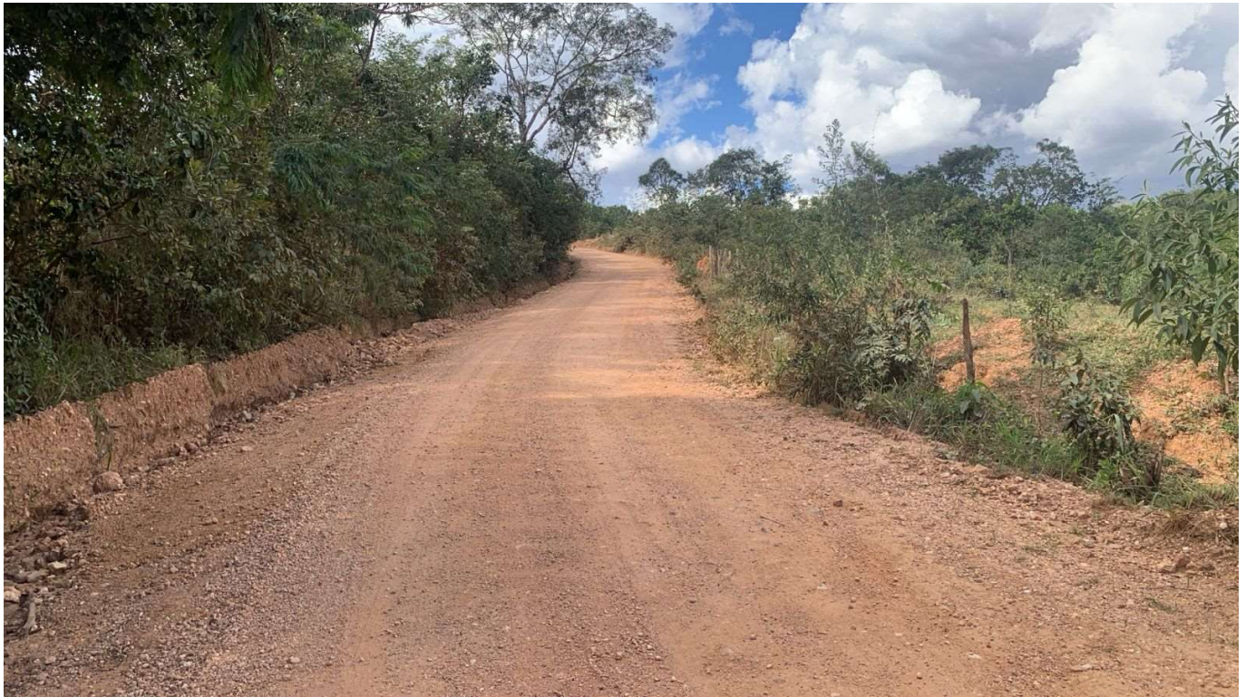
Foto 6: Morro da Cuia, localizado na Estrada Vicinal que interliga os Distritos de Vila Amanda e Vargem Grande à Comunidade da Cuia no Município de Baldim-MG. Fonte: Próprio Autor, 2026.
