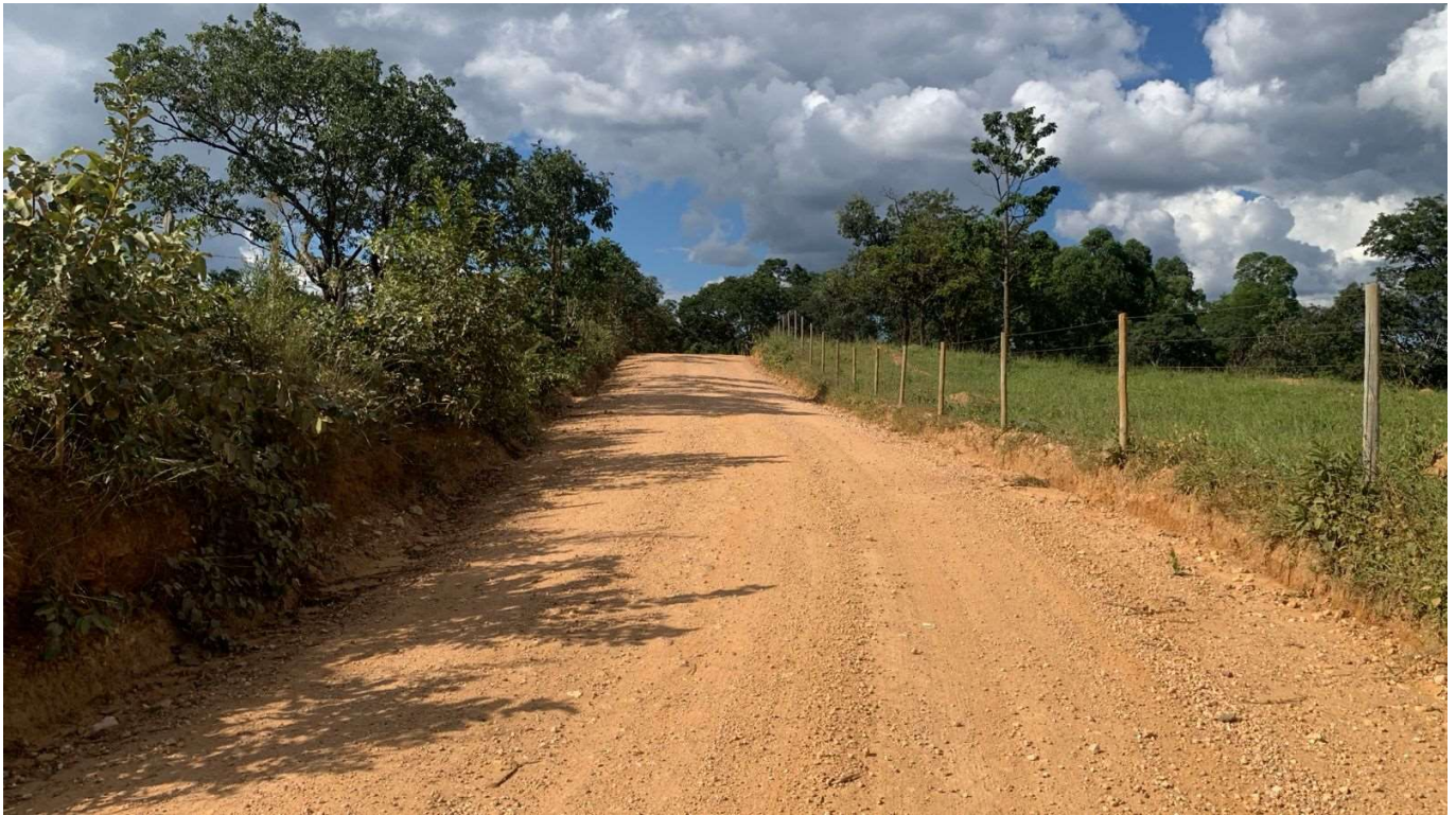
Foto 14: Morro da Cuia, localizado na Estrada Vicinal que interliga os Distritos de Vila Amanda e Vargem Grande à Comunidade da Cuia no Município de Baldim-MG. Fonte: Próprio Autor, 2026.
