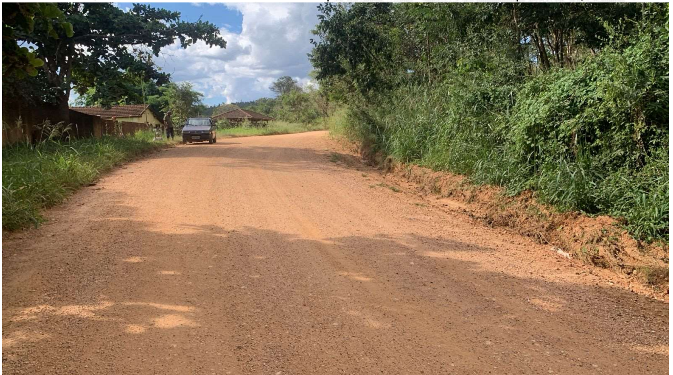
Foto 3: Morro da Cuia, localizado na Estrada Vicinal que interliga os Distritos de Vila Amanda e Vargem Grande à Comunidade da Cuia no Município de Baldim-MG. Fonte: Próprio Autor, 2026.
