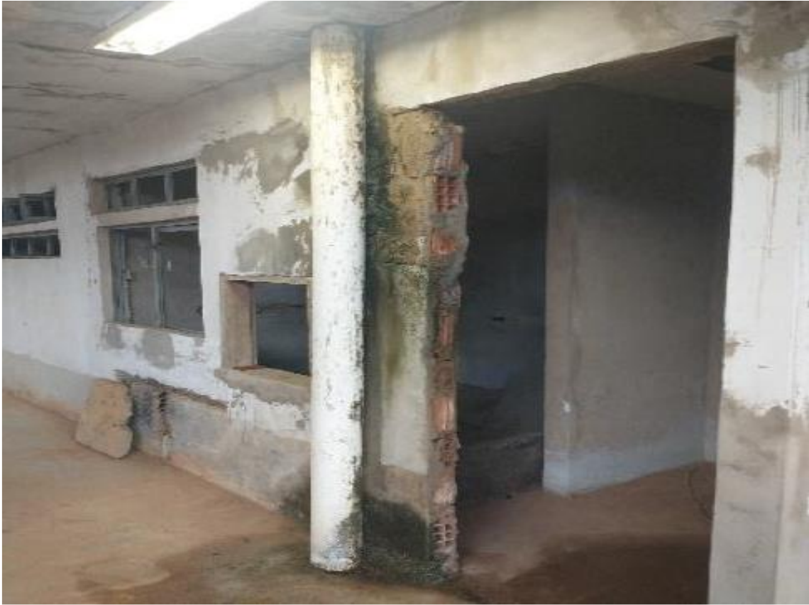
Figura 20 – Conduto da calha com vazamento exposto podendo oxidar o pilar e a viga baldrame devido a umidade. Fonte: OBRAS 2.0 – Histórico SIMEC.
