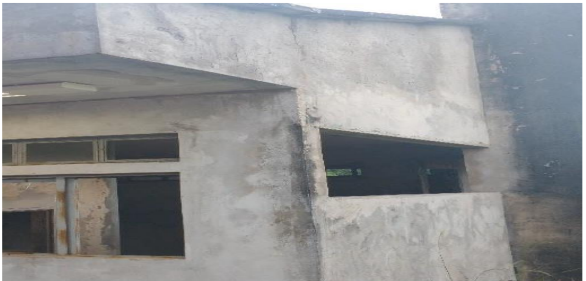
Figura 18 – Vista lateral esquerda bloco de serviço com fissura aparente e umidade na alvenaria com lodo no pano de revestimento. Fonte: OBRAS 2.0 – Histórico SIMEC.
