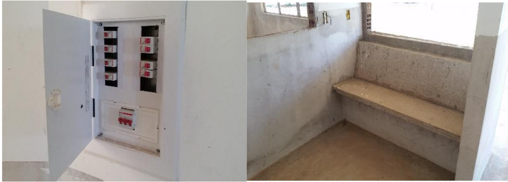
Figura 9 – Parte da instalação elétrica executada faltando cabos e acabamentos além da necessidade de uma reparação geral em todas as redes elétricas. Fonte: OBRAS 2.0 – Histórico SIMEC.
