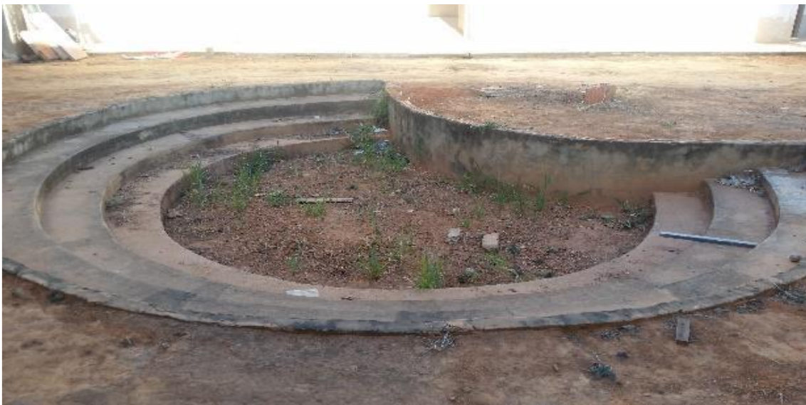
Figura 16 – Piso em estado de deterioração leve com acumulo de lodo.
