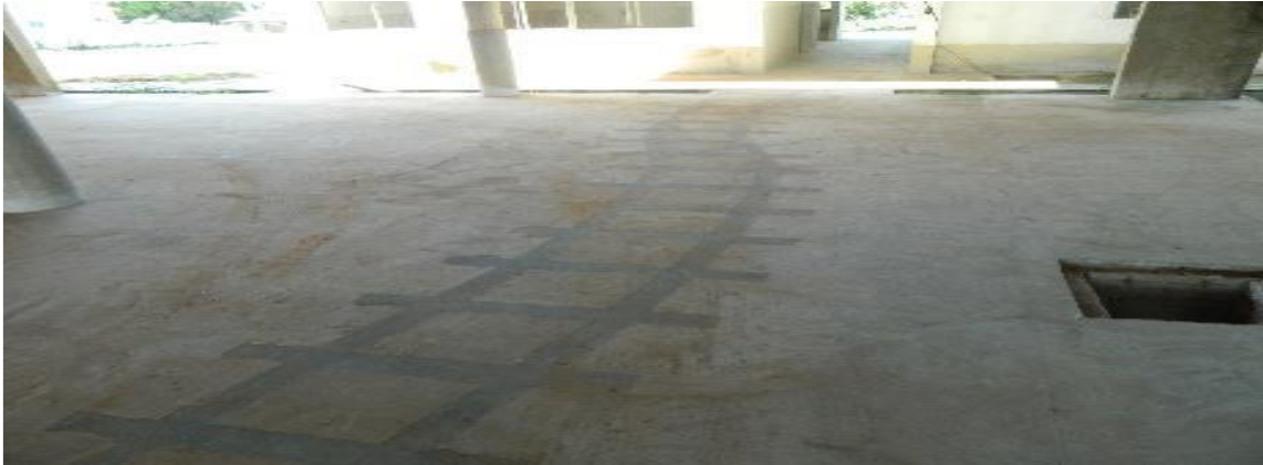
Figura 14 – Piso executada com necessidade de polimento. Fonte: OBRAS 2.0 – Histórico SIMEC
