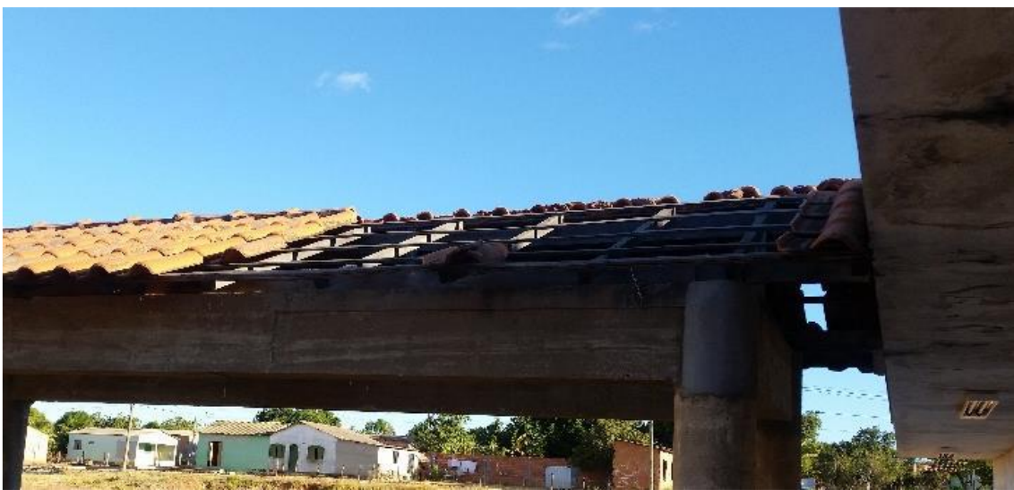
Figura 15 – Cobertura com necessidade de reparo e reposição de telhas.
