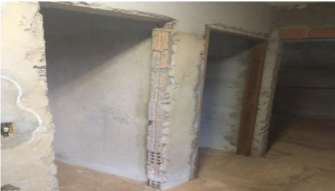
Figura 21 – Presença de umidade e acúmulo de água no piso, ausência da maioria das esquadrias de madeira e falta de acabamento elétrico e hidro sanitário. Fonte: OBRAS 2.0 – Histórico SIMEC.
