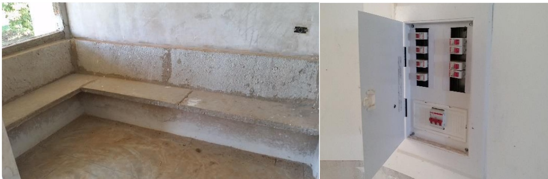
Figura 7 – Bloco administrativo com alvenaria, bancos, pisos e início da parte elétrica executados.
