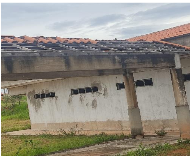
Figura 19 – Telhado com estrutura exposta podendo ser comprometida devido a umidade e com necessidade de reposição de telhas. Fonte: OBRAS 2.0 – Histórico SIMEC.
