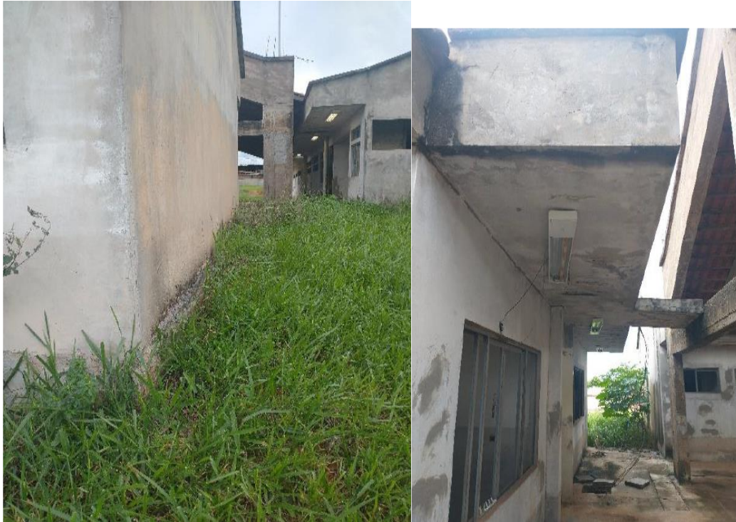
Figura 12 – Projeto estrutural FNDE- Alvenaria com infiltração, viga baldrame e lages com ausência de impermeabilização. Fonte: OBRAS
