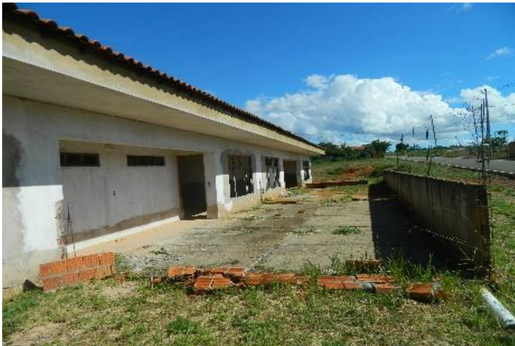
Figura 13 – Ausência de piso em granitina e fechamento em elementos vazados. Fonte: OBRAS 2.0 – Histórico SIMEC.
