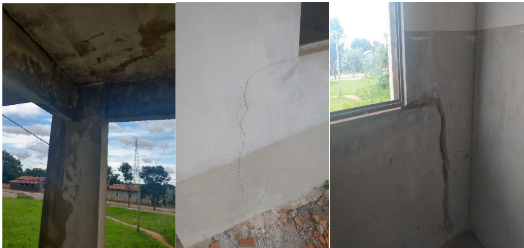
Figura 11 – Projeto estrutural FNDE- Lages com infiltração, alvenaria com fissuras aparentes. Fonte: OBRAS 2.0 – Histórico SIMEC
