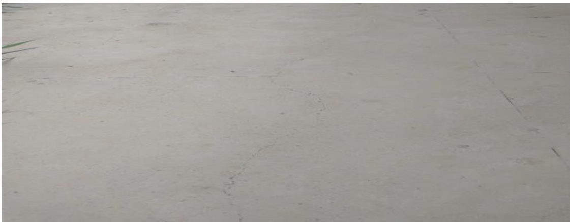
Figura 8 – Execução do contrapiso e piso em granitina com fissuras aparentes. Fonte: OBRAS 2.0 – Histórico SIMEC
