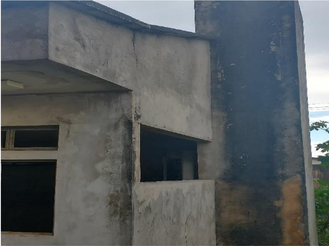
Figura 22 – Pano de alvenaria reboco com presença de lodo. Fonte: OBRAS 2.0 – Histórico SIMEC.
