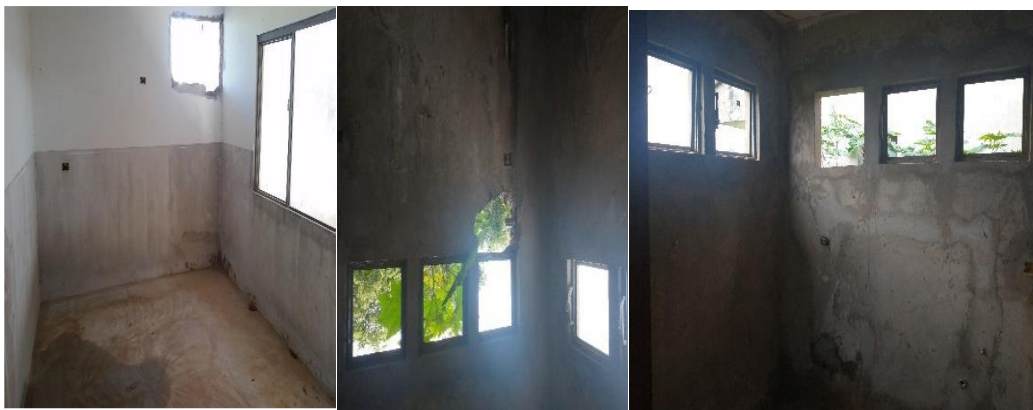
Figura 10 – Ausência de fiações elétricas, e necessidade de reparo em esquadrias. Fonte: OBRAS 2.0 – Histórico SIMEC
