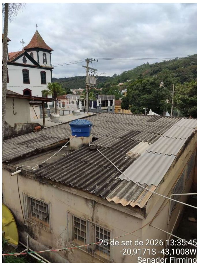
FOTO 01: Local com necessidade de intervenção.
