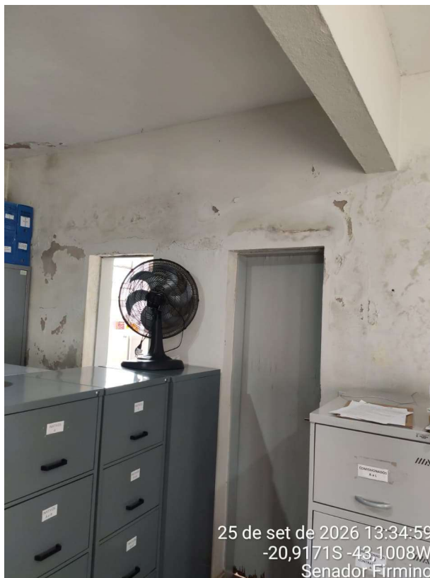
FOTO 07: Local com necessidade de intervenção.
