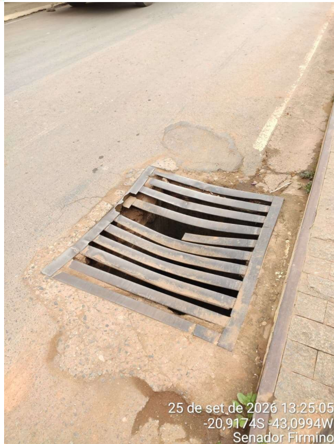
FOTO 04: Local com necessidade de intervenção.
