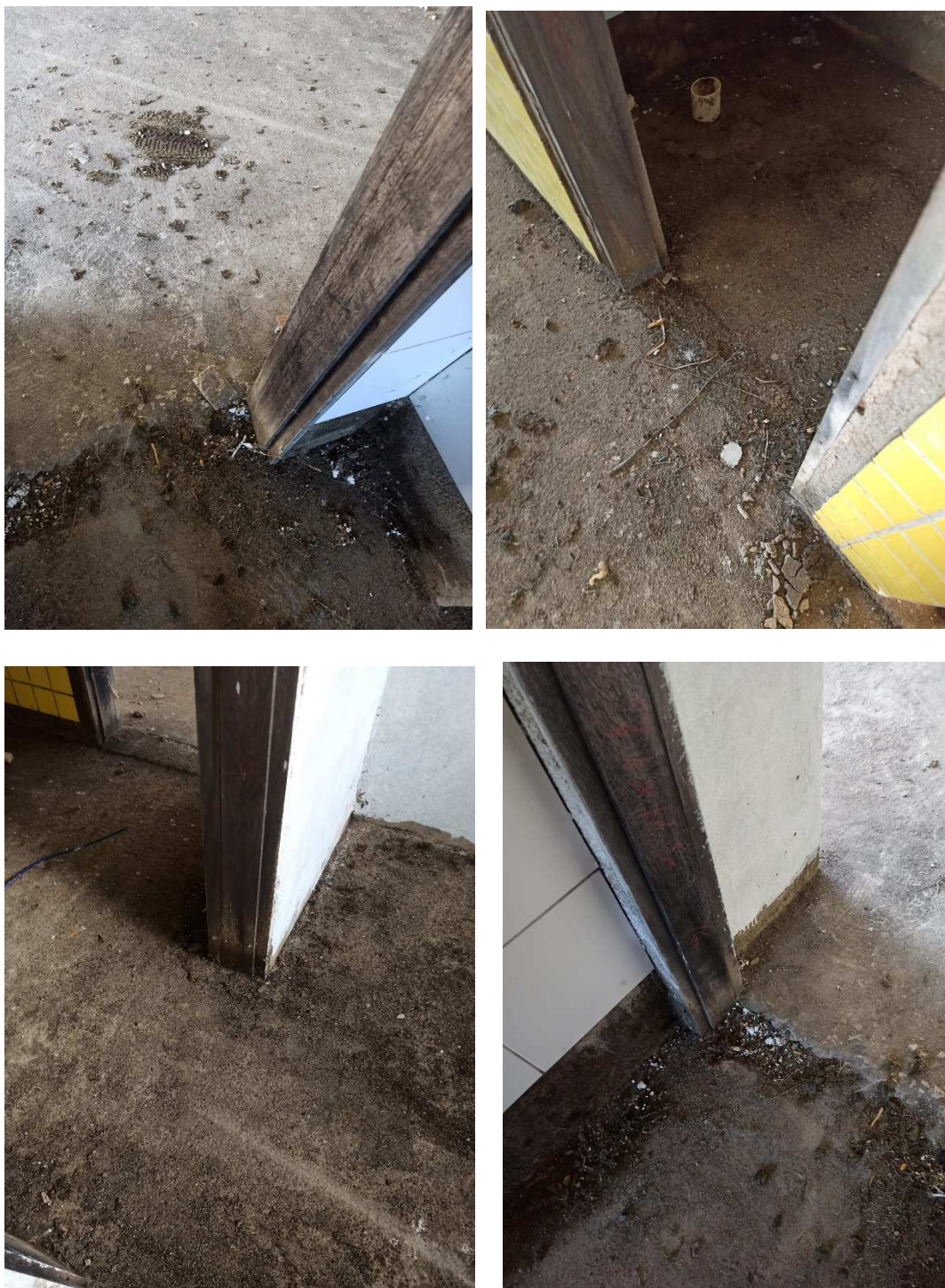
Figura 42 a 45- Inexistência de desníveis entre os contra pisos dos cômodos internos dos blocos A e B (entre as áreas secas- salas e molhadas-banheiros) em descumprimento das especificações de projeto. Necessário ser demolidos e refeitos a fim de que atendem o preconizado no projeto aprovado. Fonte: elaboração própria.
