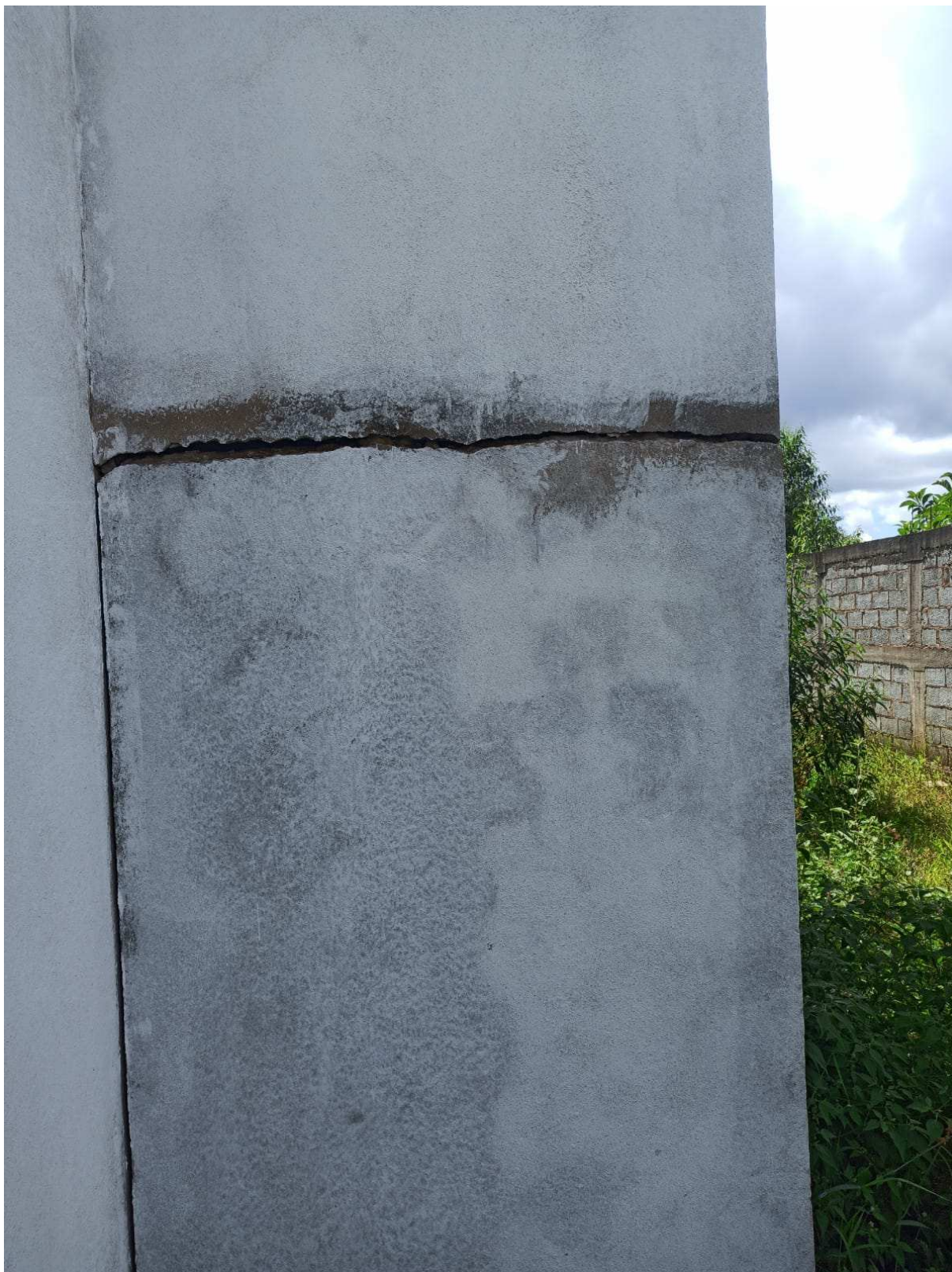
Figura 28 – Trincas com espessura superior a 5mm. Recalque da base do acréscimo de parede, o qual deverá ser feito o escoramento pontual no local. Fonte: elaboração própria.
