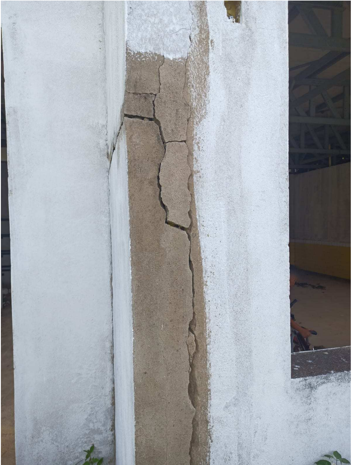
Figura 25 – Trincas com espessura superior a 5mm. Trincas nas junções dos acréscimos das alvenarias de embutimentos das prumadas com a alvenaria existente da edificação, sem execução do correto travamento com telas e amarração das alvenarias. Fonte: elaboração própria.
