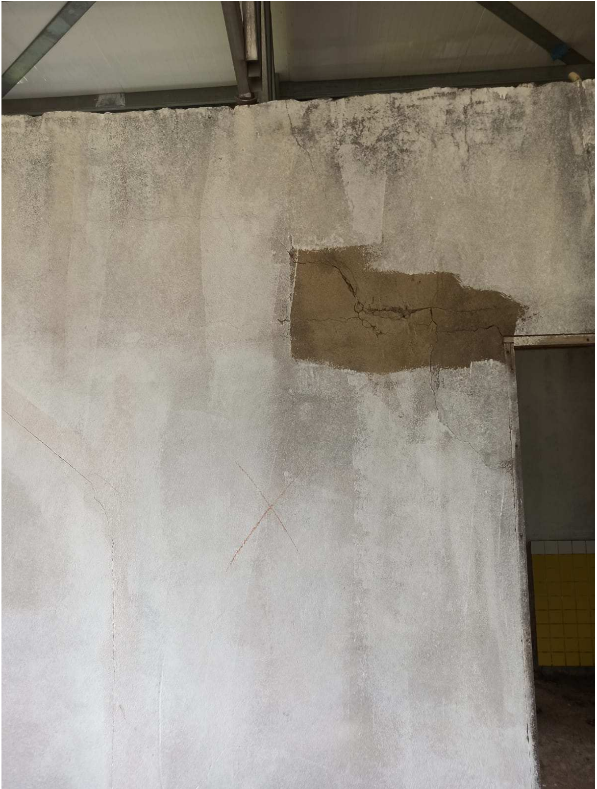
Figura 26 – Trincas com espessura superior a 3 mm. Falta de execução das vergas e contra-vergas nas aberturas dos vãos das portas e janelas. Fonte: elaboração própria.
