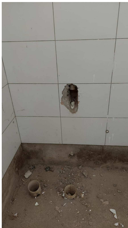
Figura 22 – Válvula de descarga roubada, cerâmica branca 30x40 não assentada. Necessário executar o barramento inferior de todas as cerâmicas e pastilhas junto ao piso, limpeza de toda a área das cerâmicas nas paredes e no contrapiso com remoção de entulho e lixo. Fonte: elaboração própria.
