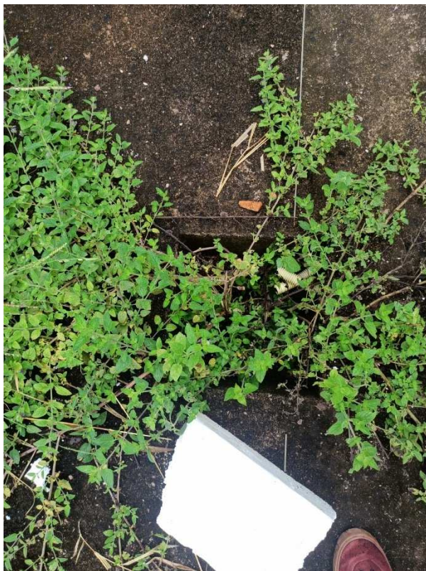
Figura 10— Passeio ao longo de todo o perímetro externo no encontro com as paredes Blocos A e B com vegetação indesejada no contrapiso nas frestas que se abriram entre o passeio e a parede. Necessário a demolição e reexecução de 20% do passeio externo uma vez que apresenta trincas relevantes com aparecimento da vegetação retratada na foto. Fonte: elaboração própria
