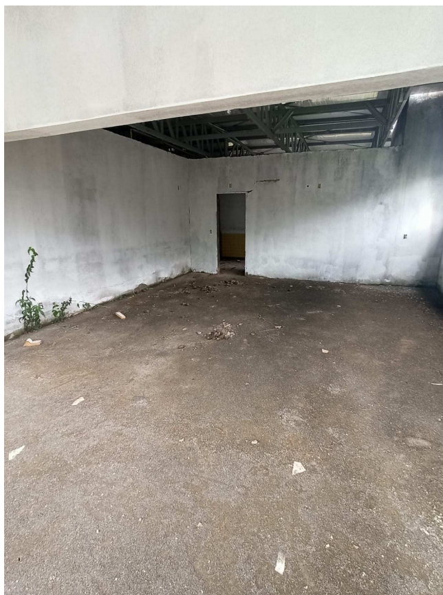
Figura 40- Trincas, vegetação e umidade no barramento inferior em vários pontos no interior dos cômodos dos blocos A e B. Fonte: elaboração própria
