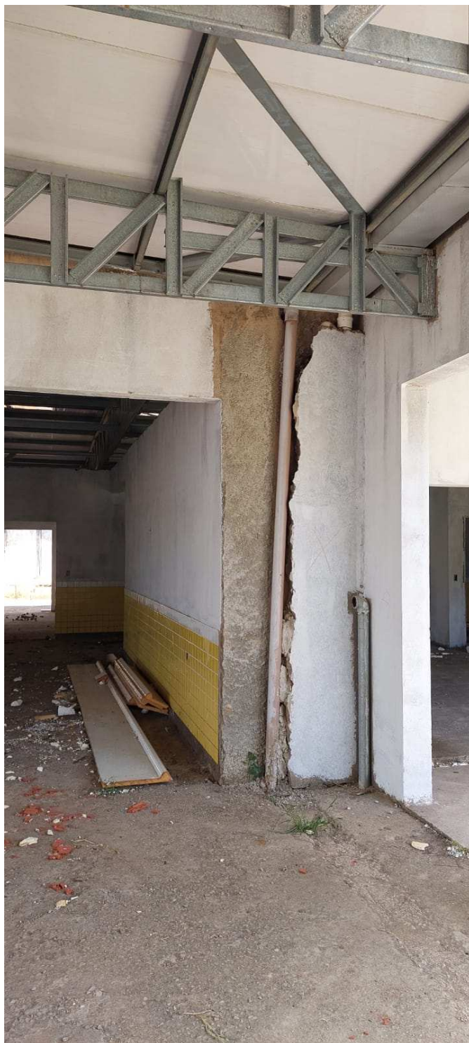
Figura- 23 Alvenaria inacabada nos acréscimos de boneca para vedação das prumadas de água fria e água pluvial conforme alteração feita no projeto revisado pelo próprio FNDE Fonte: elaboração própria
