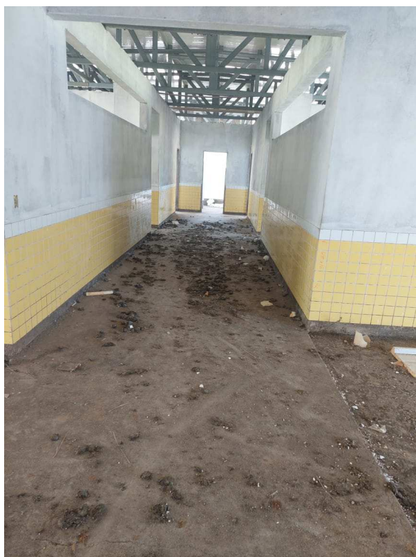
Figura 20 –Grande presença de fezes de animais, entulhos e lixo. Necessário executar o barramento inferior de todas as cerâmicas e pastilhas junto ao piso, limpeza de toda a área das cerâmicas nas paredes e no contrapiso com remoção de entulho e lixo. Fonte: elaboração própria
