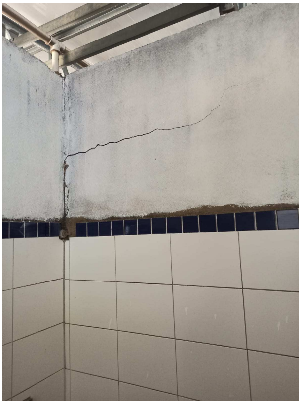
Figura 30 – Erro na instalação de registro, trincas com espessura superior a 5 mm. Fonte: elaboração própria
