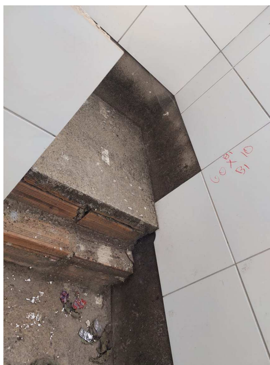
Figura 18 – Cerâmicas 40x30 quebradas e/ou não assentadas (a ser assentada após a execução do piso). Necessário executar o barramento inferior de todas as cerâmicas e pastilhas junto ao piso, limpeza de toda a área das cerâmicas nas paredes e no contrapiso com remoção de entulho e lixo. Fonte: elaboração própria
