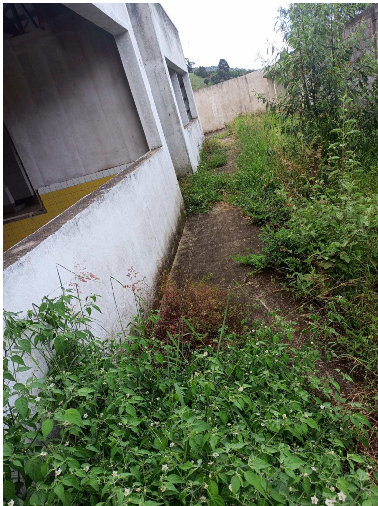
Figura 41- Umidade no barramento inferior em vários pontos ao longo de todo perímetro externos das paredes dos blocos A e B. Fonte: elaboração própria.
