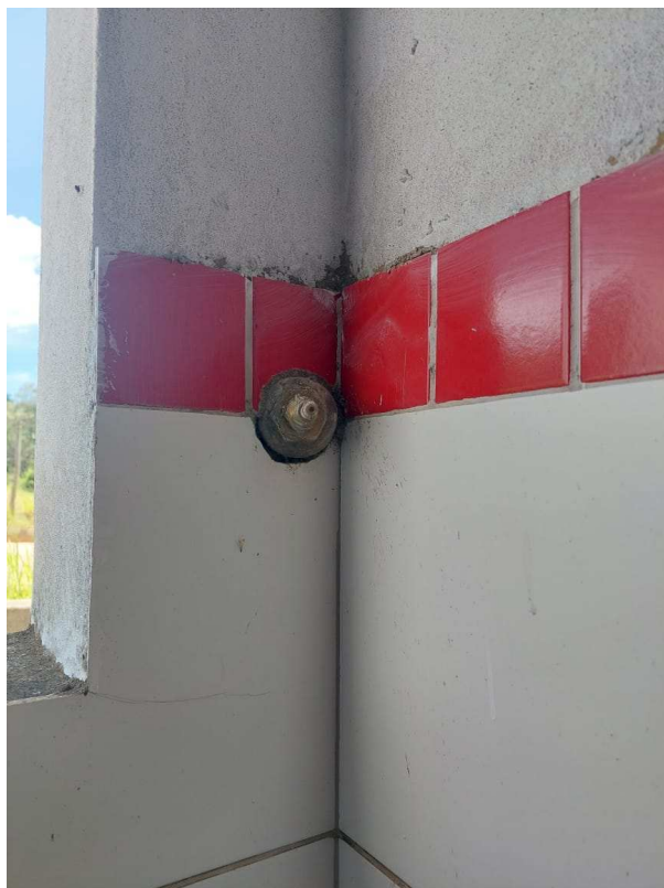
Figura 19 – Erro de execução, registro instalado de forma errada, necessidade de demolição e executar conforme projeto. Falta acabamento em todos os registros. Fonte: elaboração própria
