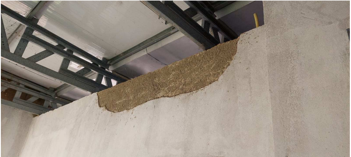
Figura 15 – Destacamento de placa de emboço por falta de chapisco, reparo teve início, porém não foi concluído. Necessário remoção do revestimento em estado de deslocamento, cm som oco (a deslocar) e executar o chapisco ora inexistente com consequente reexecução do emboço/emboço Fonte: elaboração própria
