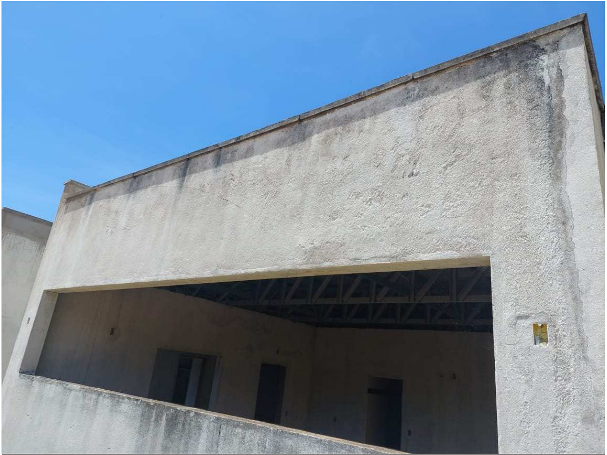
Figura 24 –Emboço externo pulverulento, pingadeiras executadas de forma invertida, agua direcionada à parede. Necessário ser removidas e reassentadas. Fonte: elaboração própria
