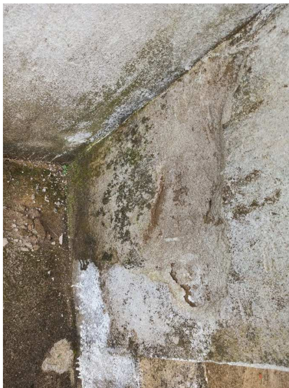
Figura 39- Umidade e pulverulência no canto da parede (área interna) em vários trechos. Falta de impermeabilização no barramento inferior das paredes. Fonte: elaboração própria
