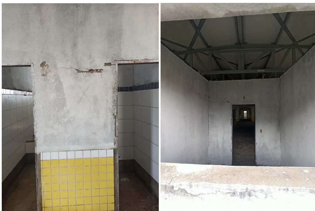
Figura 31 e 32- Trincas horizontais. . Falta de execução das vergas e contra-vergas nas aberturas dos vãos das portas e janelas. Fonte: elaboração própria
