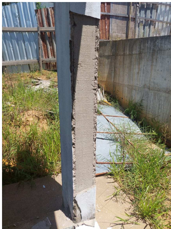
Figura 13 –Emboço deslocando, chapisco inexistente. Necessário remoção do revestimento em estado de deslocamento, cm som oco (a deslocar) e executar o chapisco ora inexistente com consequente reexecução do emboço/emboço. Fonte: elaboração própria
