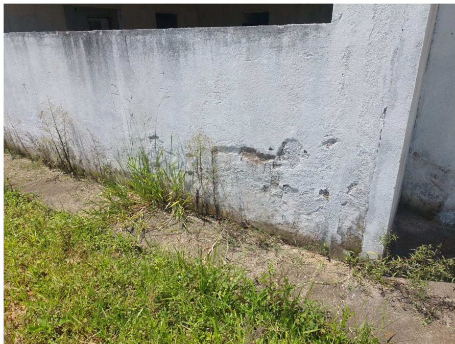
Figura 11 – Blocos A e B com vegetação indesejada no contrapiso, reboco pulverulento com manchas de umidade e bolores até uma altura de 1,0m em todo o perímetro externo da edificação. Sinal de falta de impermeabilização da alvenaria. Fonte: elaboração própria
