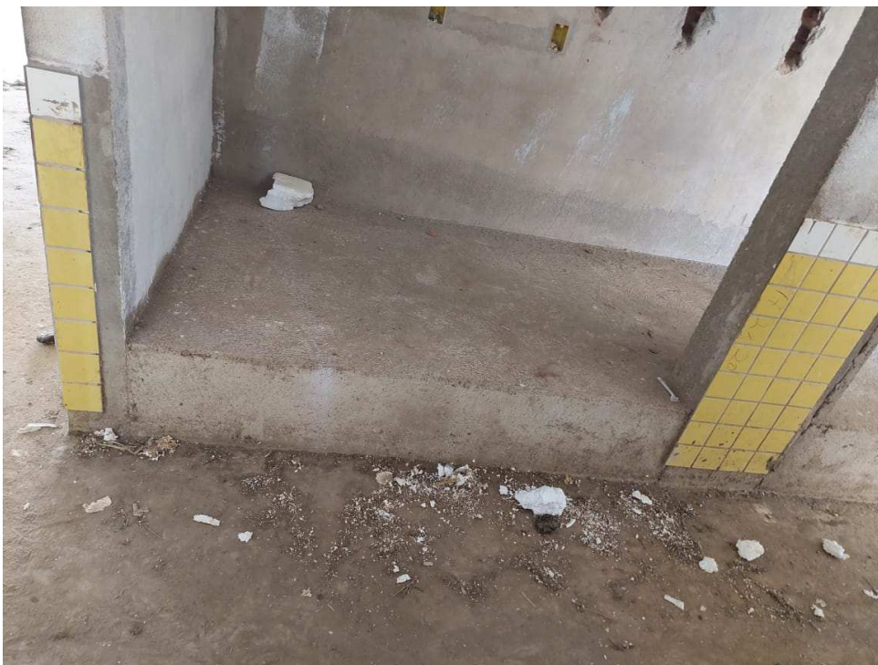
Figura 21 – Pastilhas 10x10 não assentadas em trecho e soleira. Necessário executar o barramento inferior de todas as cerâmicas e pastilhas junto ao piso, limpeza de toda a área das cerâmicas nas paredes e no contrapiso com remoção de entulho e lixo. Fonte: elaboração própria.
