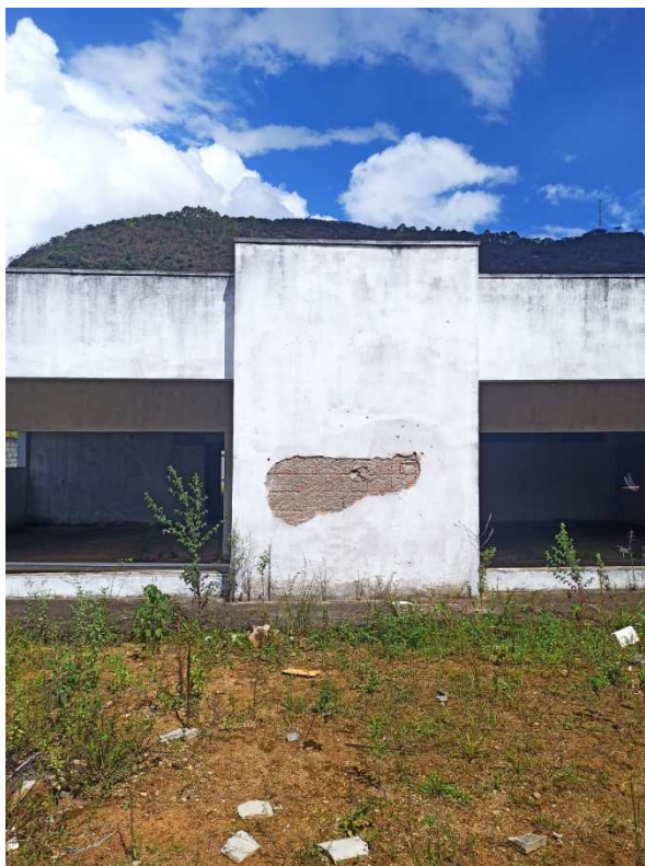
Figura 14– Reparos feitos em decorrência de destacamentos. Necessário remoção do revestimento em estado de deslocamento, cm som oco (a deslocar) e executar o chapisco ora inexistente com consequente reexecução do emboço/emboço Fonte: elaboração própria
