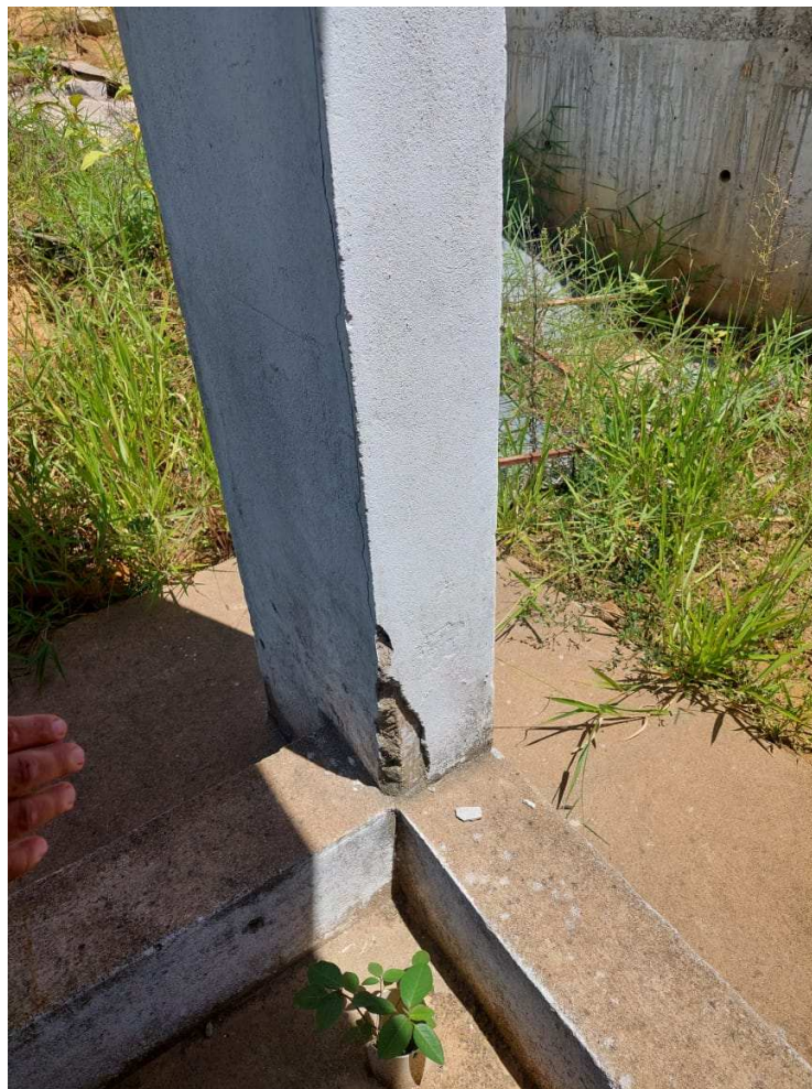
Figura 16 – Destacamento de placa de emboço em andamento, fissuras delimitam a placa a cair. Necessário remoção do revestimento em estado de deslocamento, cm som oco (a deslocar) e executar o chapisco ora inexistente com consequente reexecução do emboço/emboço Fonte: elaboração própria
