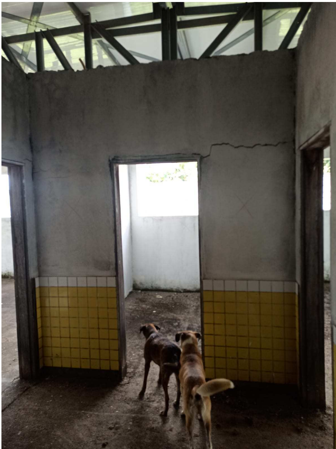
Figura 29 – Trincas com espessura superior a 5mm, presença de animais, sujeira e entulhos. Falta de execução das vergas e contra-vergas nas aberturas dos vãos das portas e janelas. Fonte: elaboração própria
