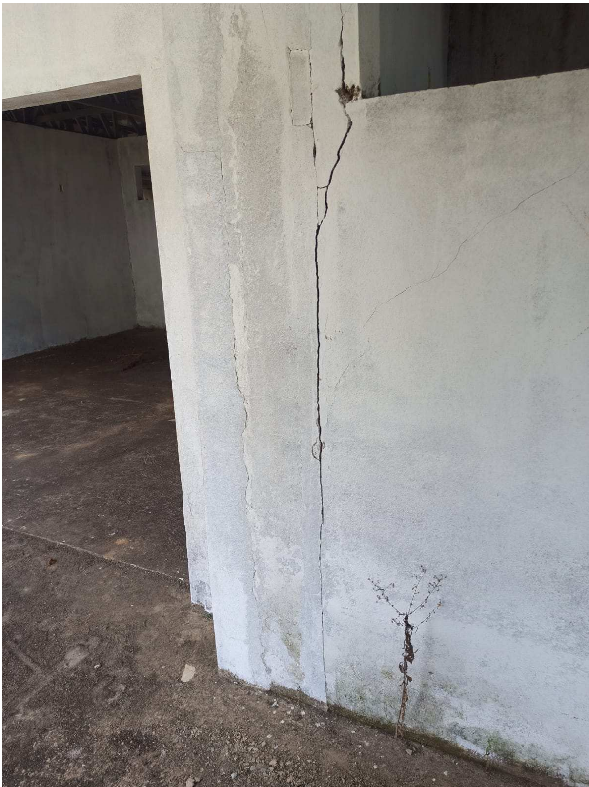
Figura 27 – Trincas com espessura superior a 5mm. Falta de execução das vergas e contra-vergas nas aberturas dos vãos das portas e janelas somado com a inexistência do correto travamento com telas ou amarração da alvenaria ao executar o acréscimo de parede para embutimento da tubulação (conforme solicitado no projeto de revisão propostos pelo FNDE). Fonte: elaboração própria.
