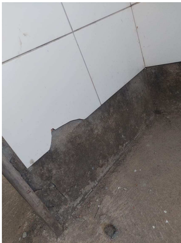
Figura 17 – Cerâmicas 40x30 quebradas e/ou não assentadas no barramento inferior (a ser assentada após a execução do piso). Necessário executar o barramento inferior de todas as cerâmicas e pastilhas junto ao piso, limpeza de toda a área das cerâmicas nas paredes e no contrapiso com remoção de entulho e lixo. Fonte: elaboração própria.
