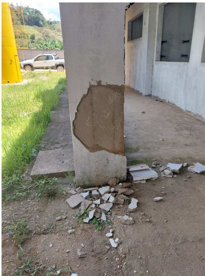
Figura 12 – Falta chapisco no pilar, deslocamento do emboço. Necessário remoção do revestimento em estado de deslocamento, com som oco (a deslocar) e executar o chapisco ora inexistente com consequente reexecução do emboço/emboço. Fonte: elaboração própria.
