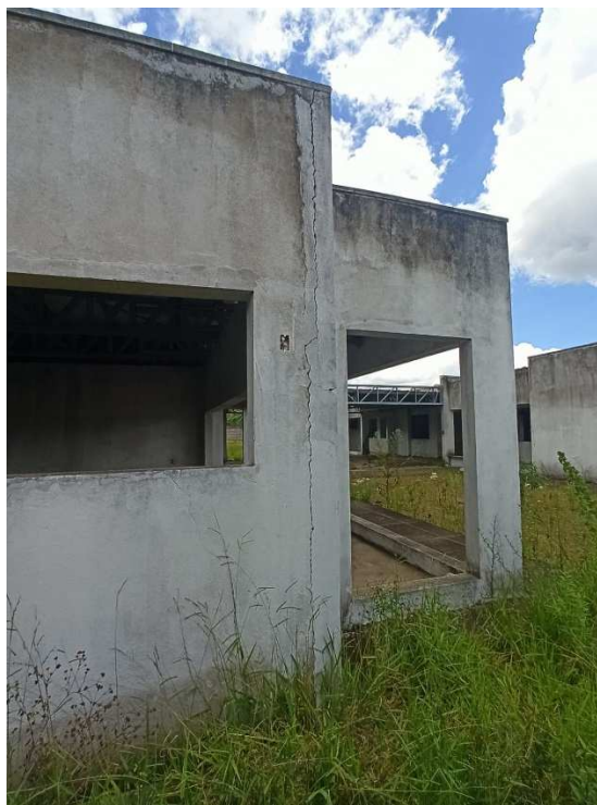
Figura 33- Vegetação indesejada e trincas verticais na estrutura. Trincas nas junções dos acréscimos das alvenarias de embutimentos das prumadas com a alvenaria existente da edificação, sem execução do correto travamento com telas e amarração das alvenarias. Fonte: elaboração própria.
