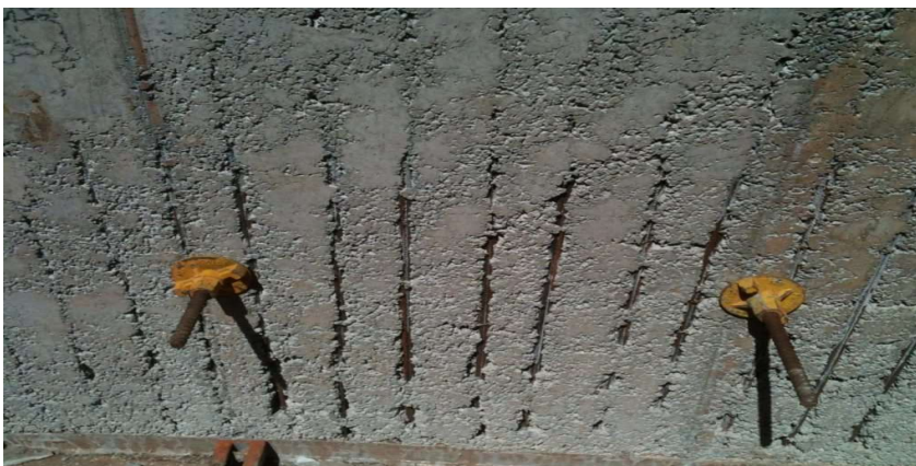
Concreto mal vibrado, deixando o aço exposto.
