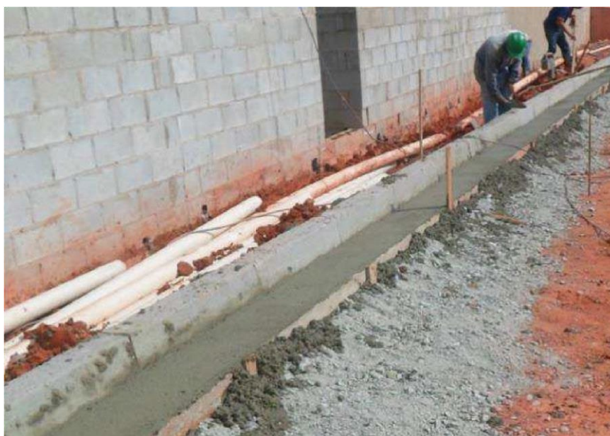
Figura 1 - Exemplo de execução de sarjeta moldada in loco após execução do meio-fio pré-moldado
