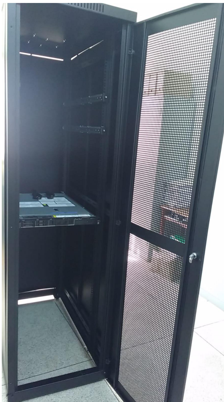
Figura 18: imagem da instalação do servidor em 25/10/2021.
