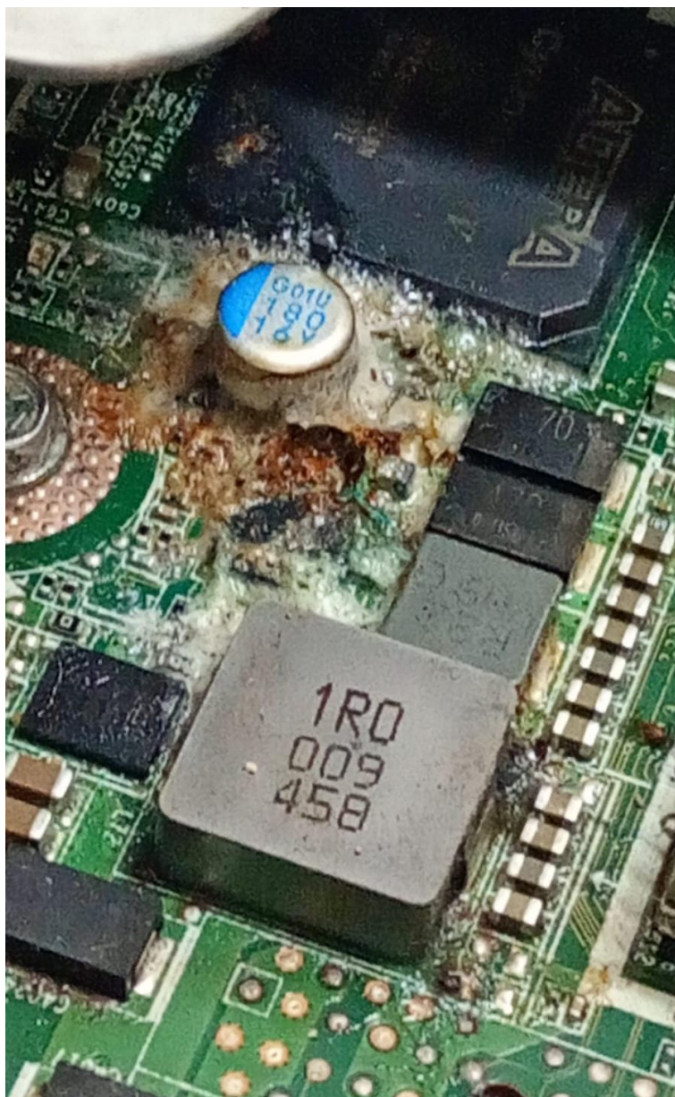
Figura 12: imagem das marcas de água na placa de circuito do servidor
