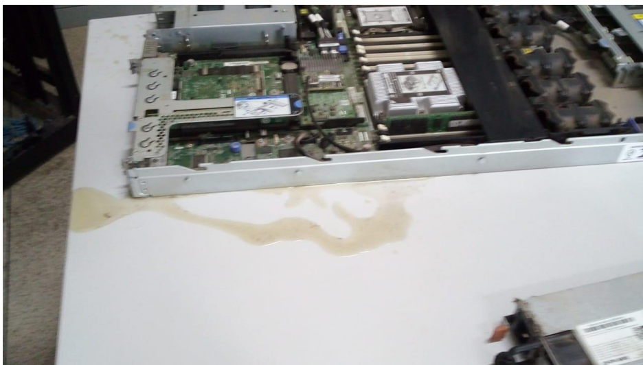
Figura 5: Imagem do servidor danificado pela chuva
