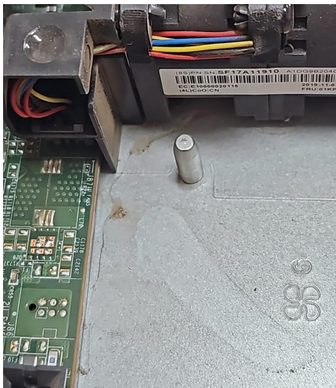
Figura 15: imagem das marcas de água na placa de circuito do servidor
