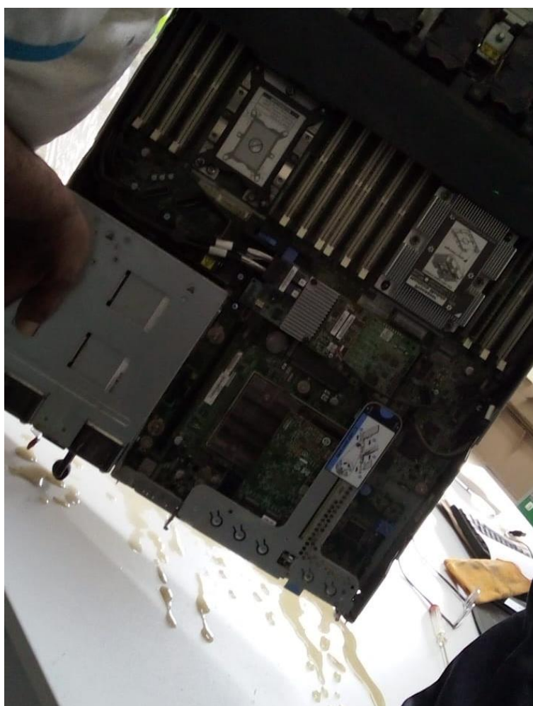
Figura 4: Imagem do servidor danificado pela chuva
