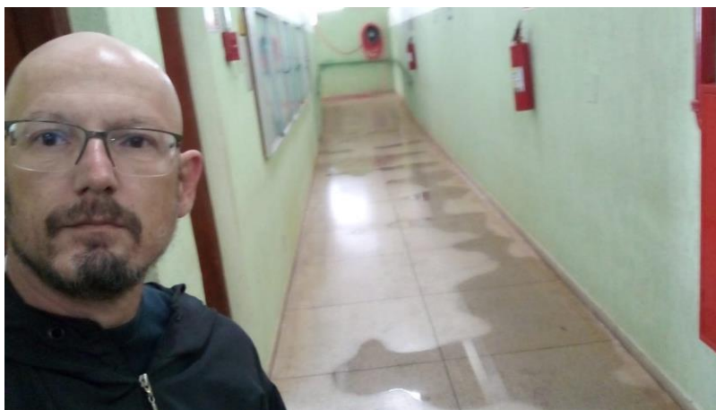
Figura 1: Imagem do corredor da Prefeitura após a infiltração de água causada pela chuva
