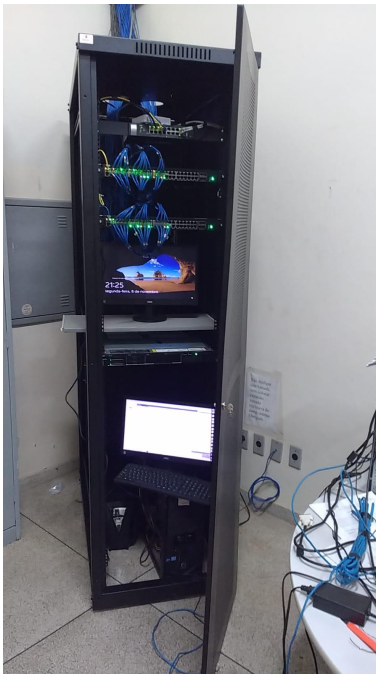
Figura 20: imagem do servidor devidamente instalado e funcionando em 08/11/2021.
