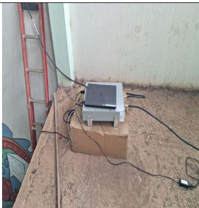
8 – Equipamento repetidor (Sobre o banheiro)
