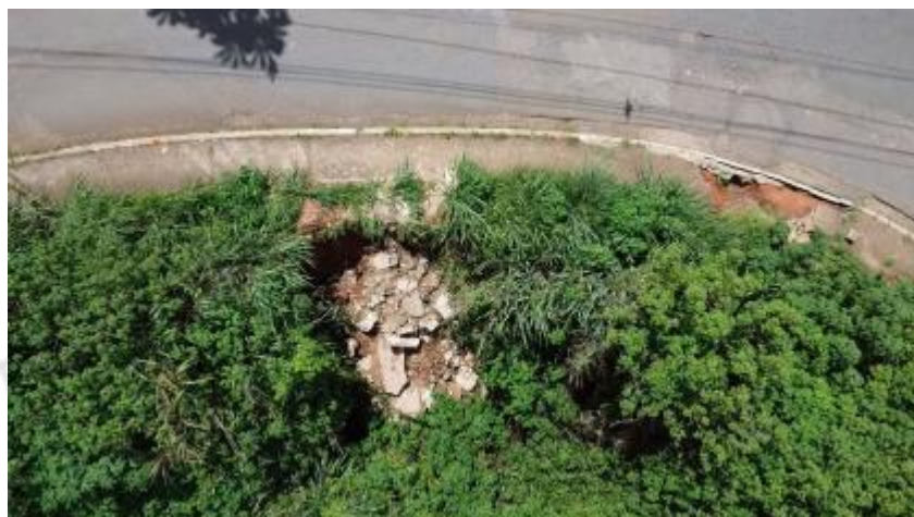
Foto 06 – Local das erosões – Fonte: Defesa Civil – Ouro Branco
