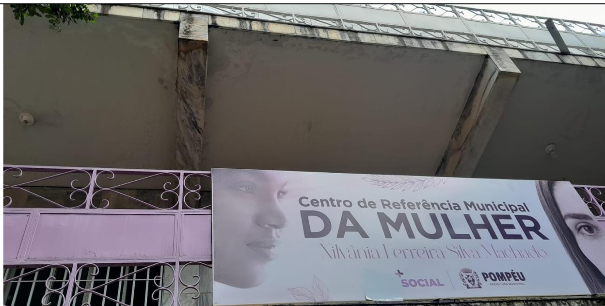
FACHADA FRONTAL – MANCHAS DE INFILTRAÇÃO
