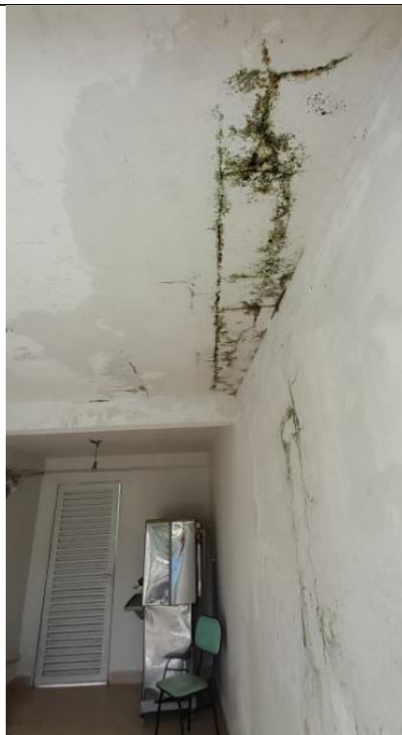
INFILTRAÇÃO NO INTERIOR DO PRÉDIO
