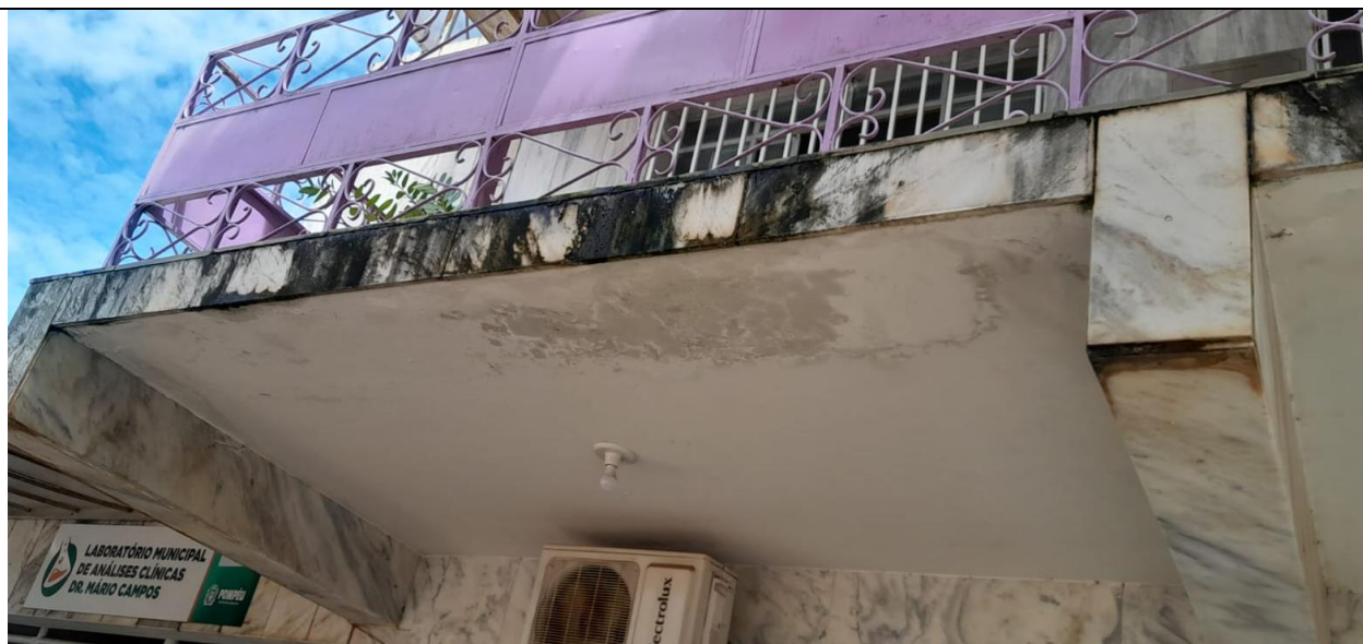
FACHADA FRONTAL – MANCHAS DE INFILTRAÇÃO
