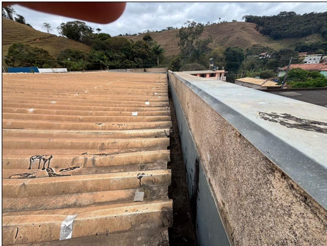
Foto 08 – Vista das calhas e rufos a serem substituídos
