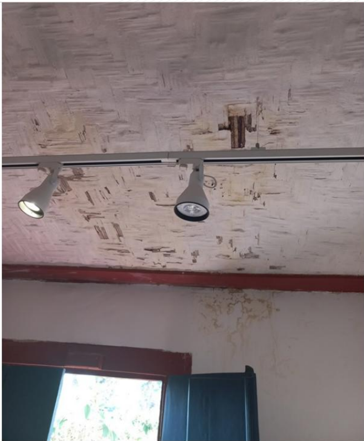
Imagem: 06 – Foto em vistoria no dia 20/06/2024 - Comodo voltado para a fachada Nordeste do Museu Regional de Caeté. Forro e parede danificados pela infiltração de águas pluviais.
