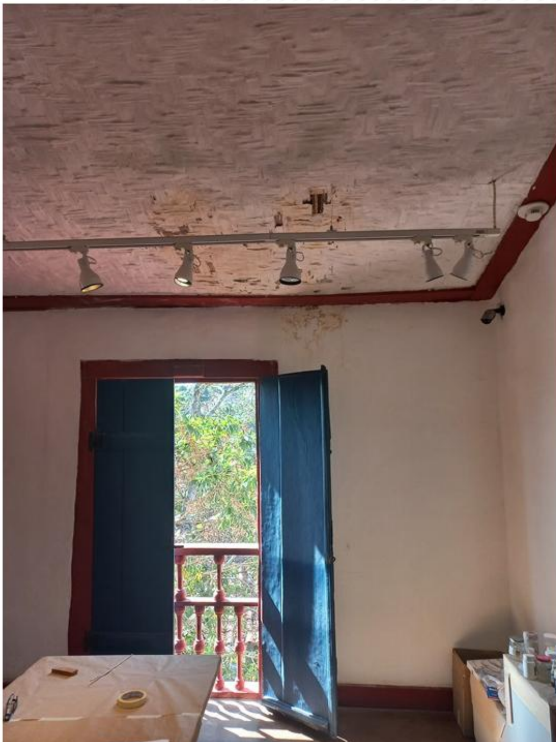
Imagem 05 – Foto em vistoria no dia 20/06/2024 – Comodo voltado para a fachada Nordeste do Museu Regional de Caeté. Forro e parede danificados pela infiltração de águas pluviais.
