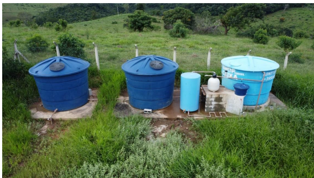
Figura 07: Foto das estruturas da ETA do Distrito de Santo Antônio do Norte
