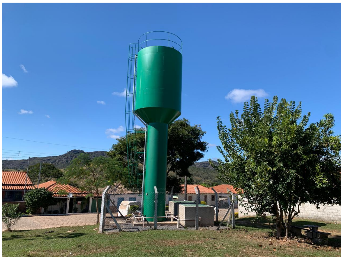
Figura 13: Foto da área do reservatório e abrigo do tratamento de água do Distrito de Costa Sena
