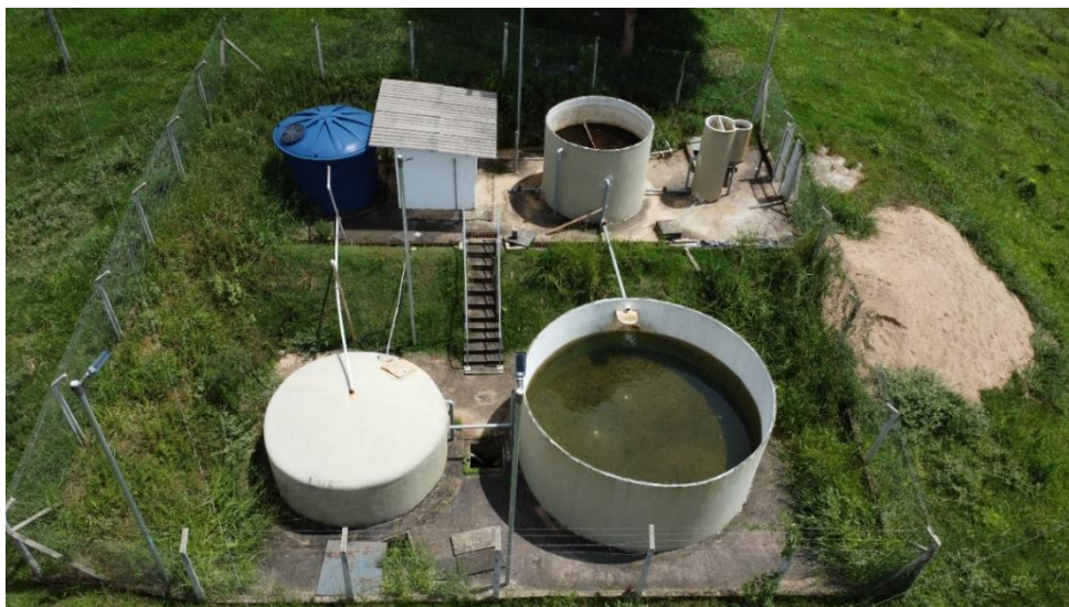
Figura 01: Foto das estruturas ETA do Distrito do Tabuleiro
