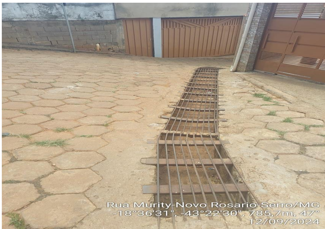
Foto 03: Drenagem da Tv. Murity.
