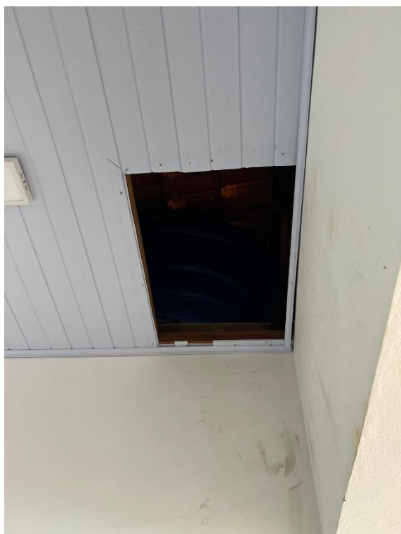
Foto 04 – Forro em PVC
