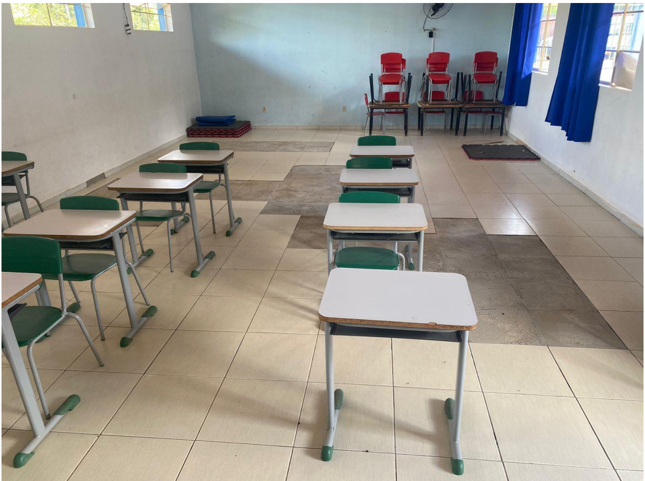
FOTO 10 – SALA 01 (TROCA DE PISO CERÂMICO DO CHÃO E INSTALAÇÃO DE PISO CERÂMICO NAS PAREDES)
