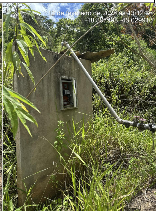
Foto 09 – Quadro de comando.
