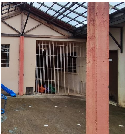
Foto 01: Portão a ser adequado.
