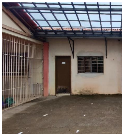
Foto 02: Portão a ser adequado.
