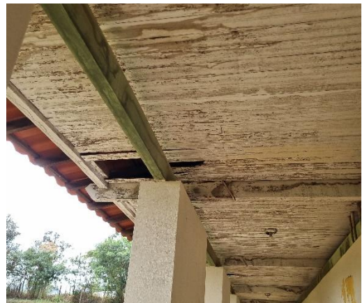
Figura 6- Forros a serem substituídos
